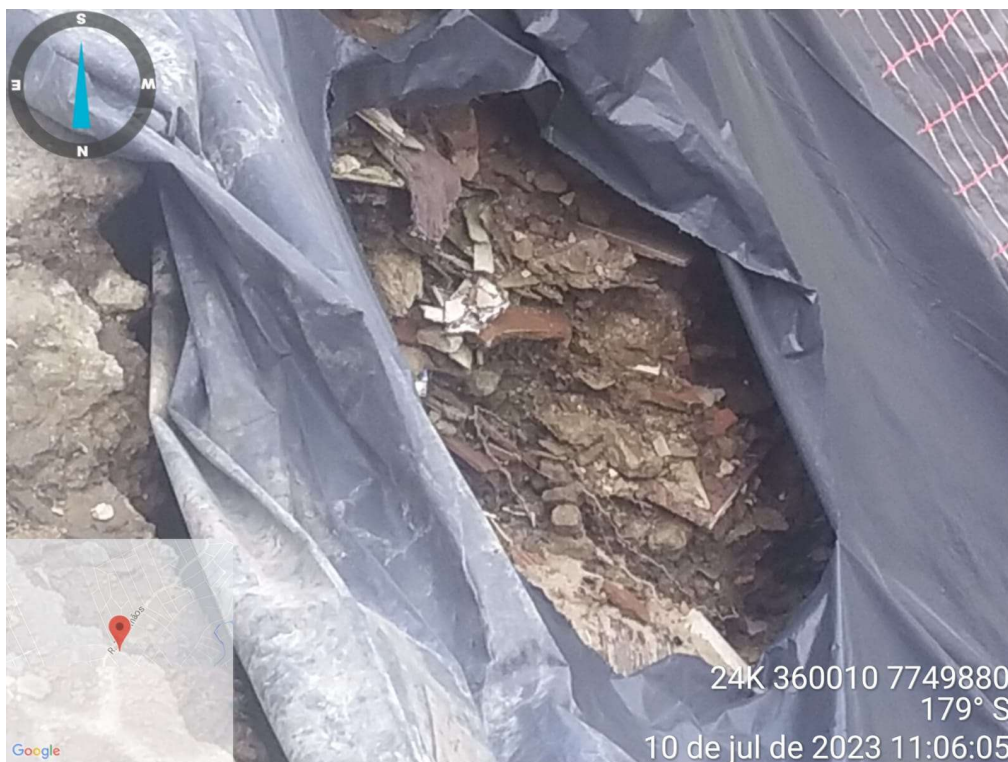
Foto 04 – Detalhamento do talude no trecho desmoronado constituído de aterro em parte considerável de material de entulho.
