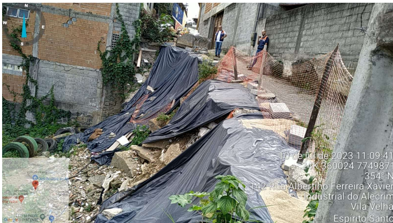
Foto 01 – Vista da infraestrutura da via desmoronada. Isolamento promovido pela SEMOPE.
