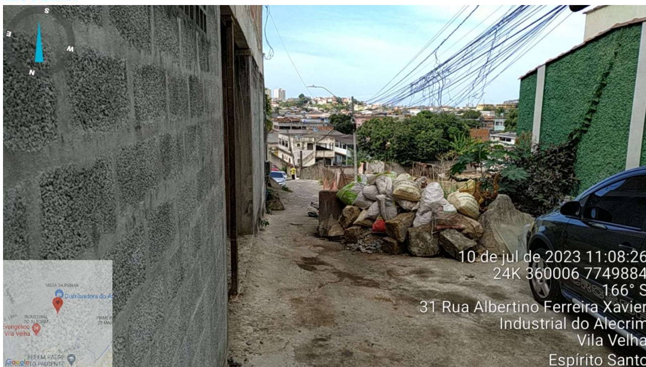
Foto 03 – Obstrução da via promovida para evitar trânsito de veículos próximo ao trecho desmoronado.
