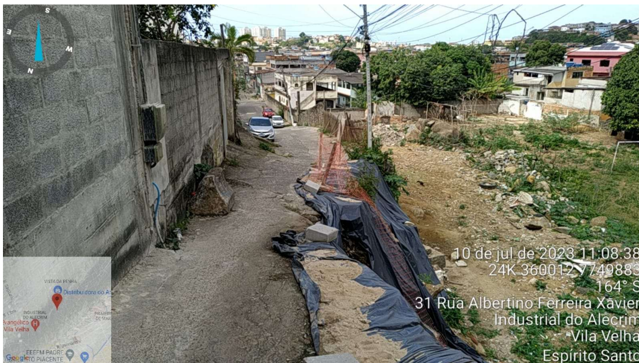
Foto 02 – Vista lateral da infraestrutura da via desmoronada. Acesso à rua prejudicado.
