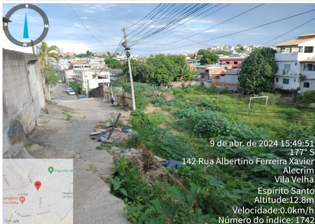
Foto 01 – Local de ocorrência do desmoronamento da via.
