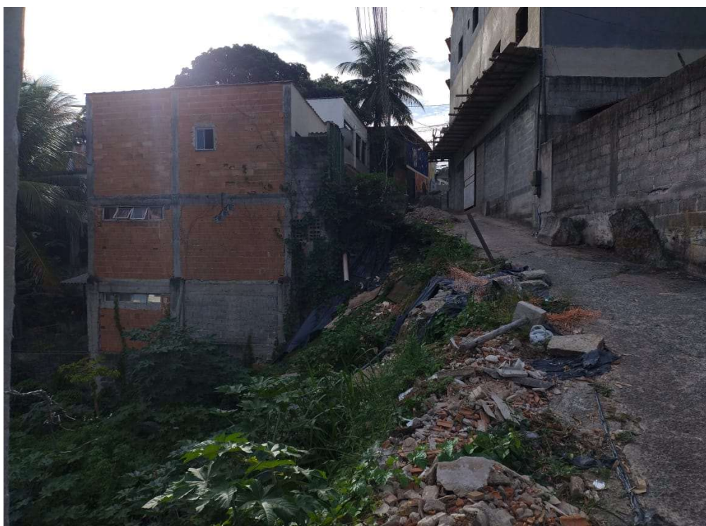
Foto 02 – Local de ocorrência do desmoronamento da via e a presença de resíduos.
