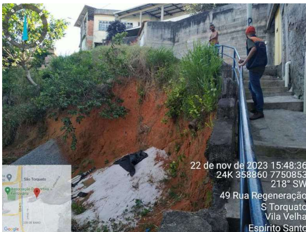
Foto 2 – Trecho da Rua Resplendor. Talude de corte com histórico de movimentos de massa cuja progressão dos processos poderá acarretar a perda do acesso por este local.
