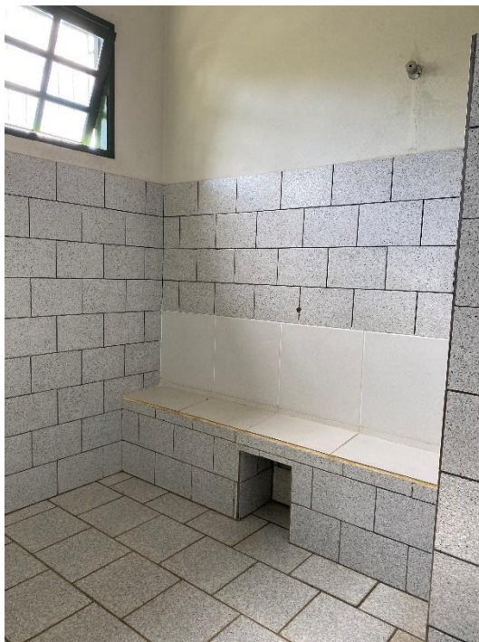
Figura 18 - Revestimento incompatível Serpenge ,2023
