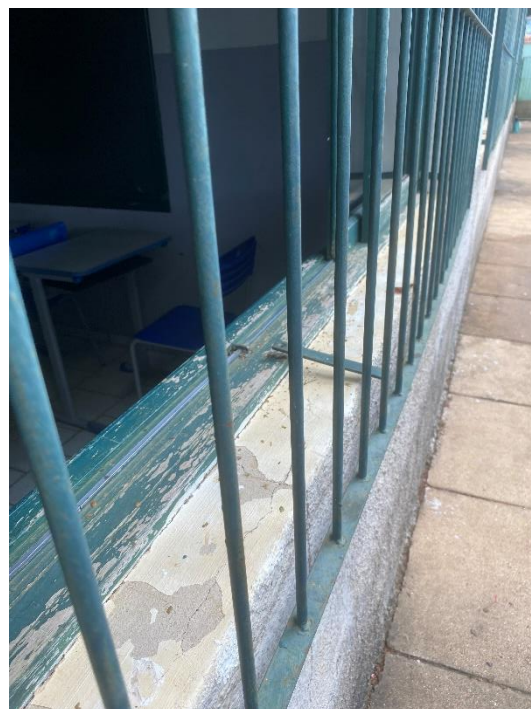
Figura 11 – Janela das Sala de Aula. Serpenge ,2023
