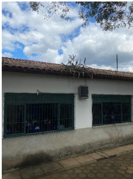
Figura 19 - Infiltração na fachada Serpenge ,2023
