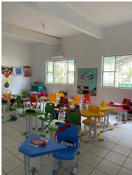
Figura 14 – Piso sala de aula, Serpenge ,2023
