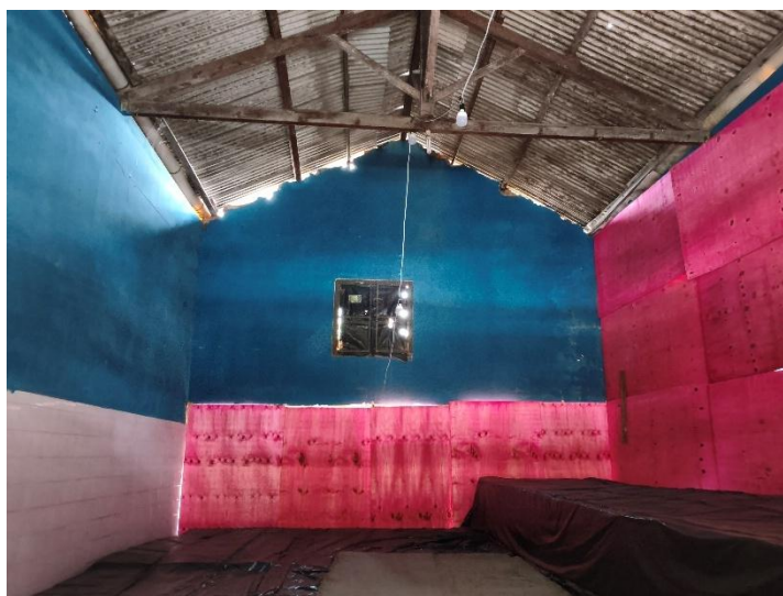
Figura 9 – Foto do galpão no terceiro terreno e suas condições estruturais do telhado
