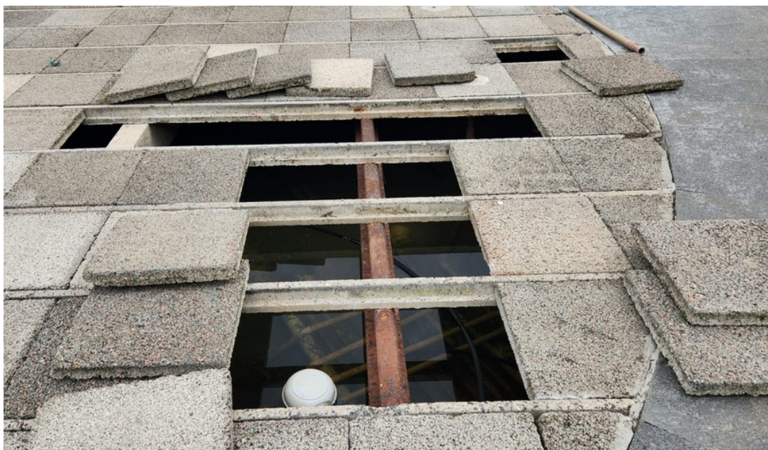
Figura 1: Detalhe do Chafariz Interativo sem estrutura abaixo das placas de concreto poroso.
