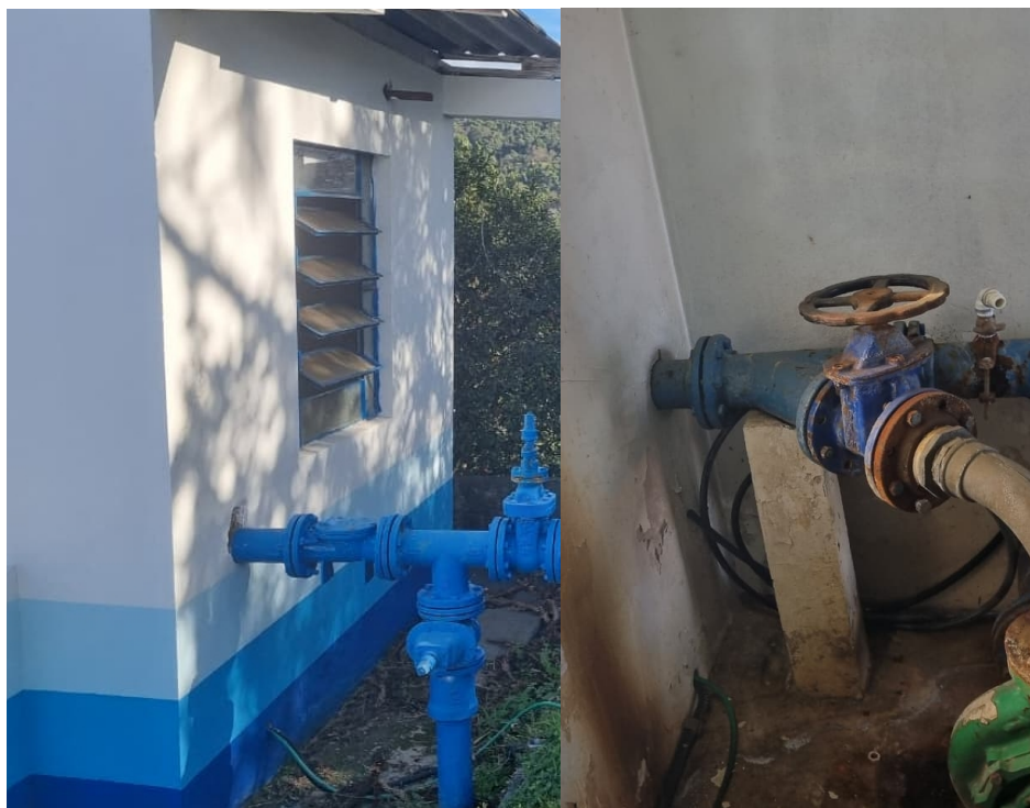
Foto 06: Local de instalação do macromedidor no recalque do ERAT 2.2.
