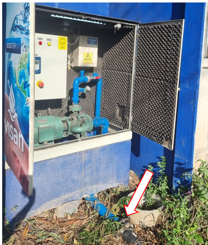
Foto 02: Local de instalação do macromedidor no recalque do booster 1.1.
