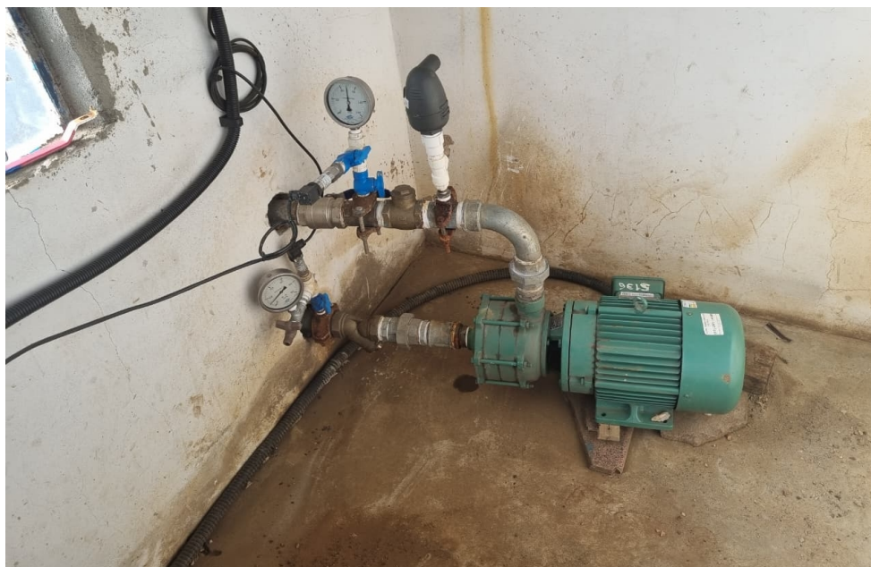
Foto 10: Local de instalação do macromedidor recalque ERAT 3.2.
