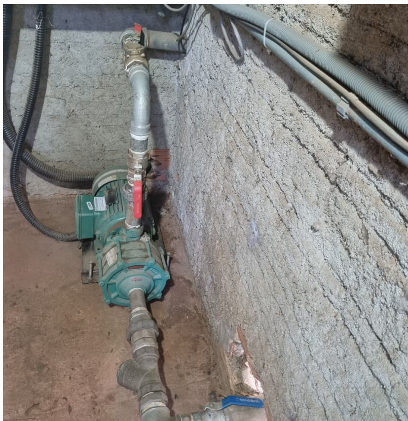
Foto 04: Local de instalação do macromedidor no recalque do ERAT 1.5.
