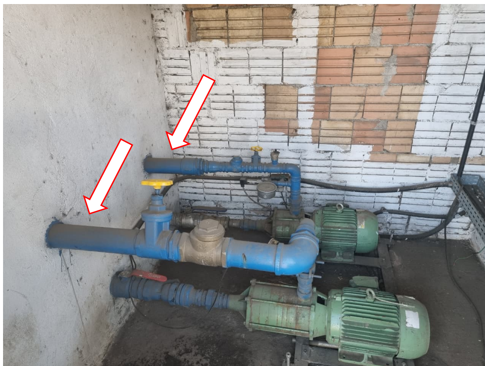
Foto 03: Local de instalação do macromedidor no recalque do booster 1.3 e ERAT 1.3.1.
