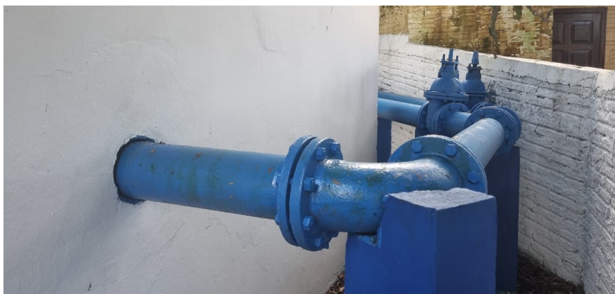
Foto 05: Local de instalação do macromedidor no recalque do ERAT 2.1.
