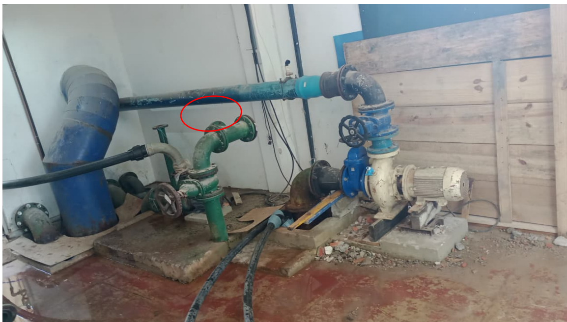
Foto 01: Local de instalação do macromedidor no recalque erat 1.
