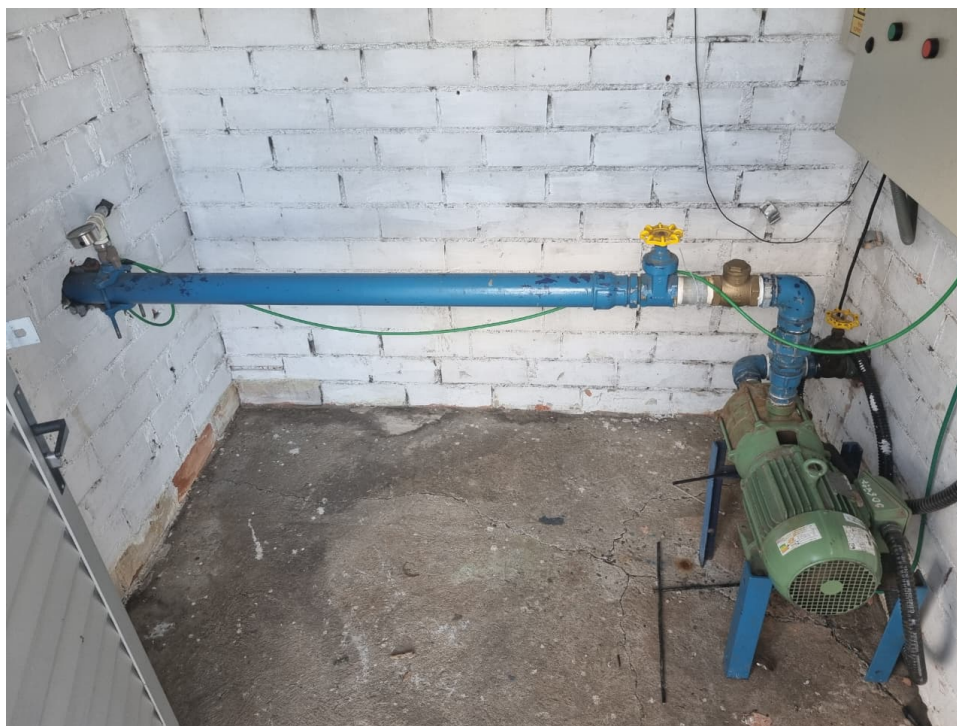
Foto 07: Local de instalação do macromedidor no recalque do ERAT 2.4.
