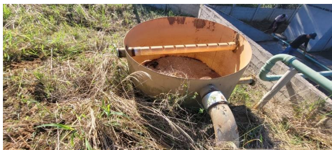
Foto 7 – Filtro inativo a ser retirado. D=1,50m
