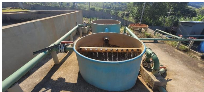
Foto 1 – Imagem lateral dos Filtros a serem retirados. D=1,50/H=1,03
