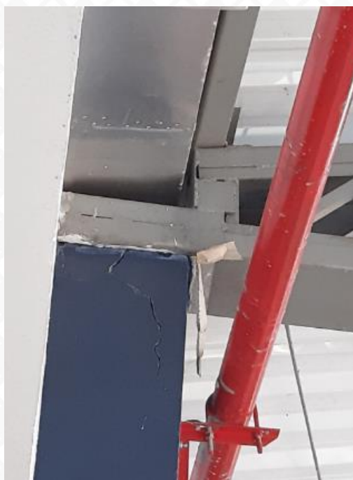
FIGURA 9 – APOIO INCORRETO DAS TRELIÇAS DE COBERTURA METÁLICA
