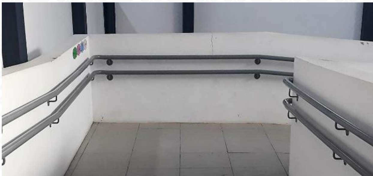
FIGURA 32 – FISSURA EM GUARDA-CORPO E RAMPA
