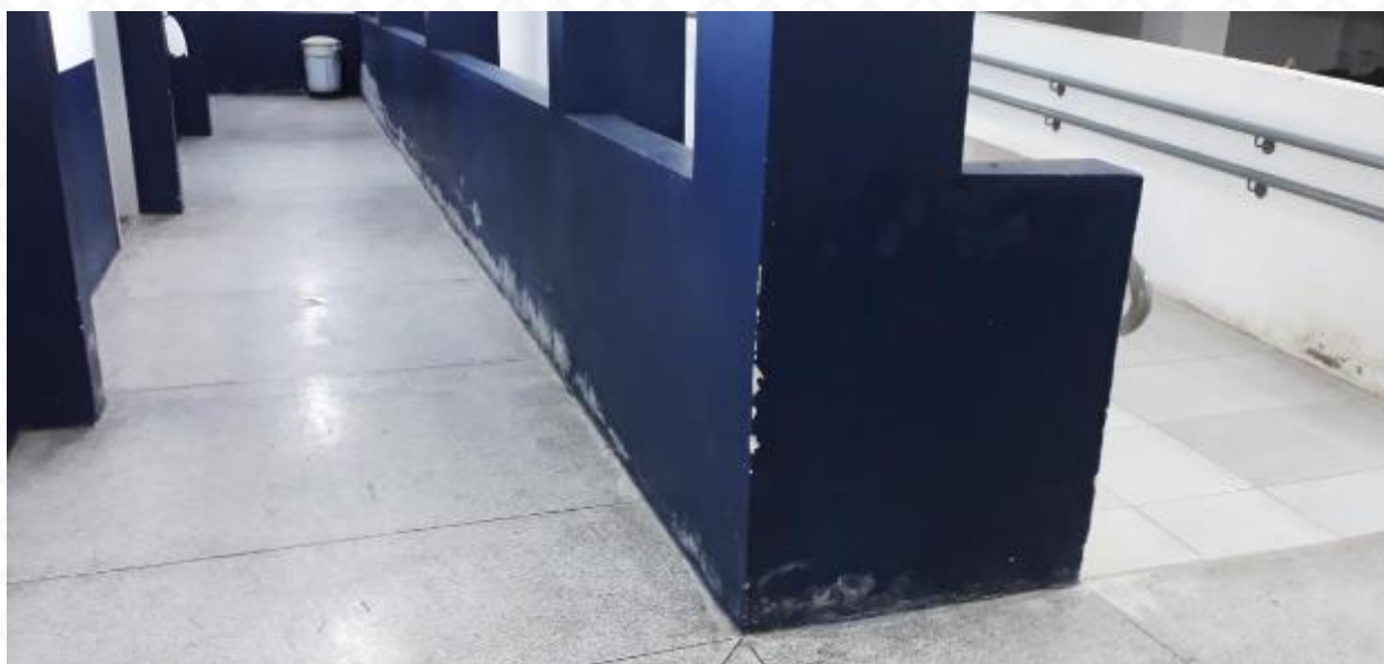
FIGURA 23 – SINAIS DE UMIDADE, EFLORESCÊNCIA, DEGRADAÇÃO E DESPLACAMENTOS
