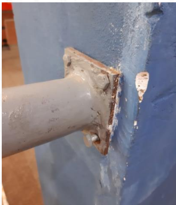
FIGURA 44 – ESCADAS METÁLICAS – FALTA DE PINTURA E PROTEÇÃO CONTRA INCÊNDIO
