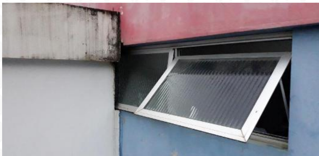
FIGURA 49 – CENTRAL DE GÁS – INCAPACIDADE DE ABERTURA DE JANELAS
