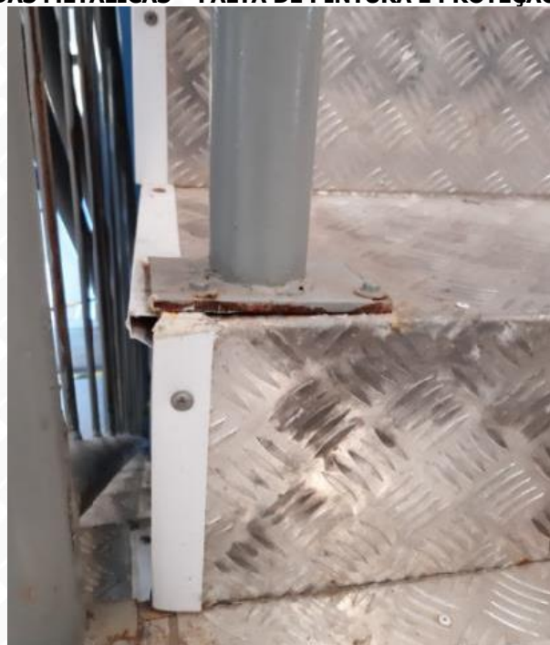
FIGURA 43 – ESCADAS METÁLICAS – FALTA DE PINTURA E PROTEÇÃO CONTRA INCÊNDIO
