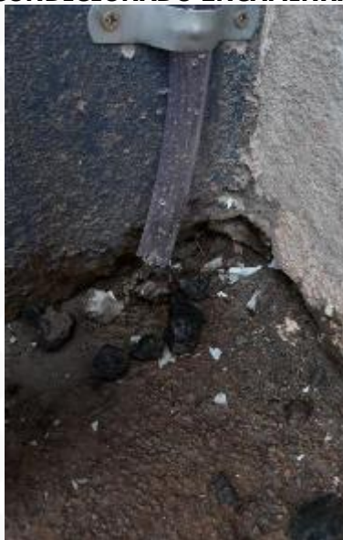
FIGURA 56 – DRENO DO AR CONDICIONADO ENCAMINHADO PARA LOCAL INCORRETO
