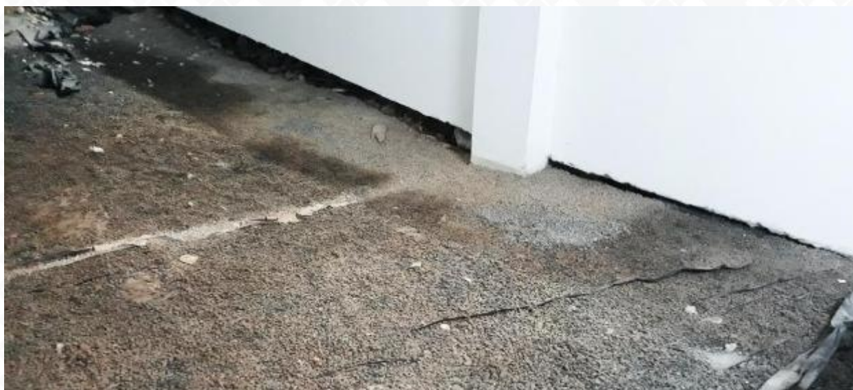
FIGURA 22 – SINAIS DE UMIDADE, EFLORESCÊNCIA, DEGRADAÇÃO E DESPLACAMENTOS
