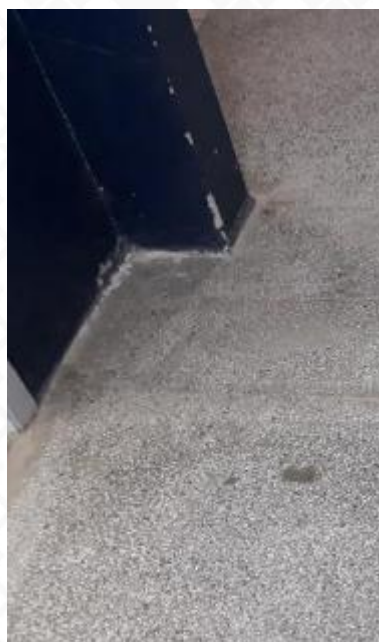
FIGURA 12 – DEGRADAÇÃO DO REVESTIMENTO ARGAMASSADO
