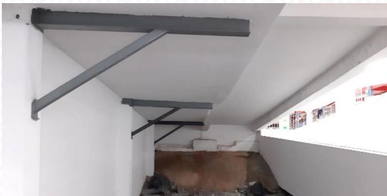
FIGURA 33 – ESTRUTURA NÃO PREVISTA EM PROJETO
