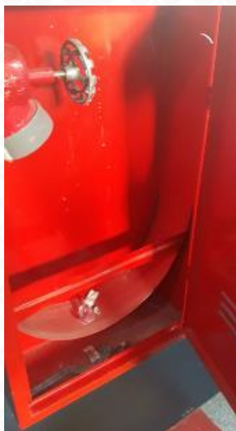
FIGURA 36 – HIDRANTES SEM EQUIPAMENTOS
