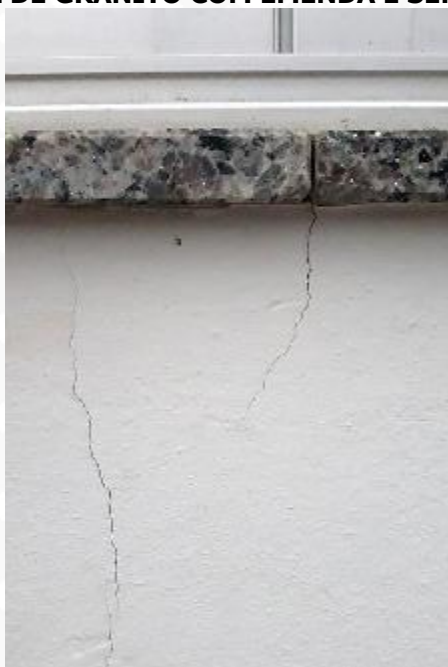
FIGURA 55 – PEITORIL DE GRANITO COM EMENDA E SEM IMPERMEABILIZAÇÃO
