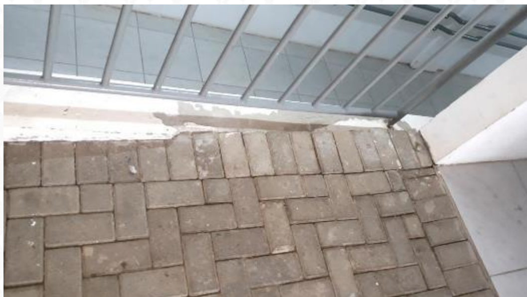
FIGURA 31 – FALTA DE ACABAMENTO E COMPATIBILIZAÇÃO DE PROJETO
