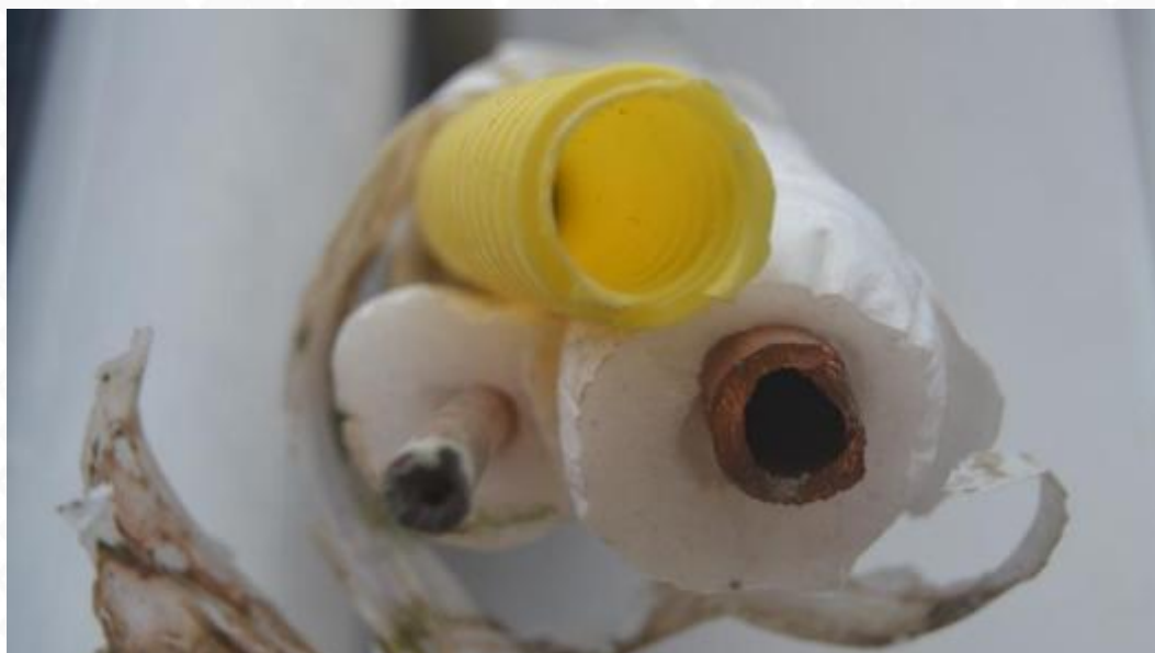
FIGURA 57 – INSTALAÇÃO DE NOVAS TUBULAÇÕES E FURAÇÕES DESNECESSÁRIAS EM PAREDE
