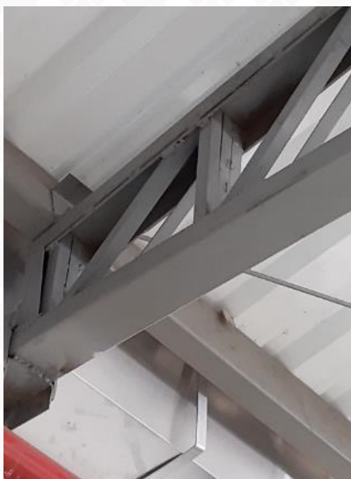
FIGURA 10 – FALTA DE QUALIDADE DA ESTRUTURA METÁLICA (SOLDAS E ENCONTROS)
