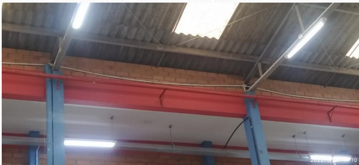
FIGURA 15 – ELETRODUTOS E CALHAS EM DESACORDO
