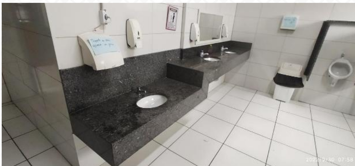
FIGURA 51 – BANHEIRO NÃO PROJETADO E EXECUTADO PARA ACESSIBILIDADE
