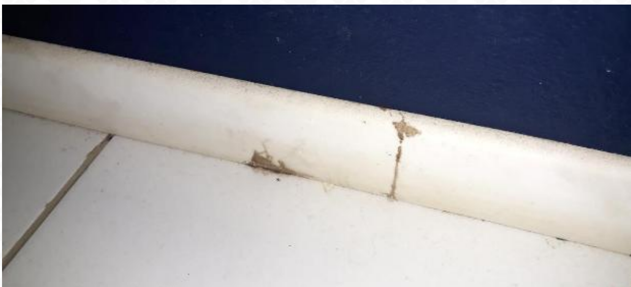
FIGURA 26 – RODAPÉ INADEQUADO AO USO
