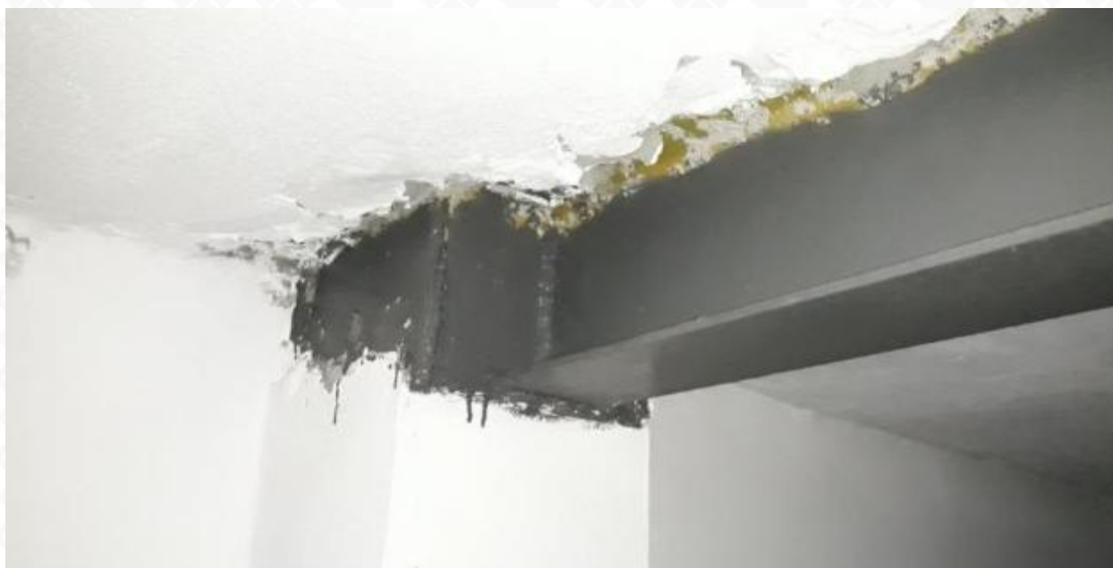
FIGURA 34 – ESTRUTURA NÃO PREVISTA EM PROJETO
