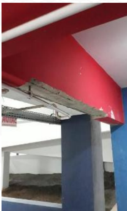
FIGURA 25 – DESPLACAMENTO DE REBOCO EM VIGA DE CONCRETO ARMADO
