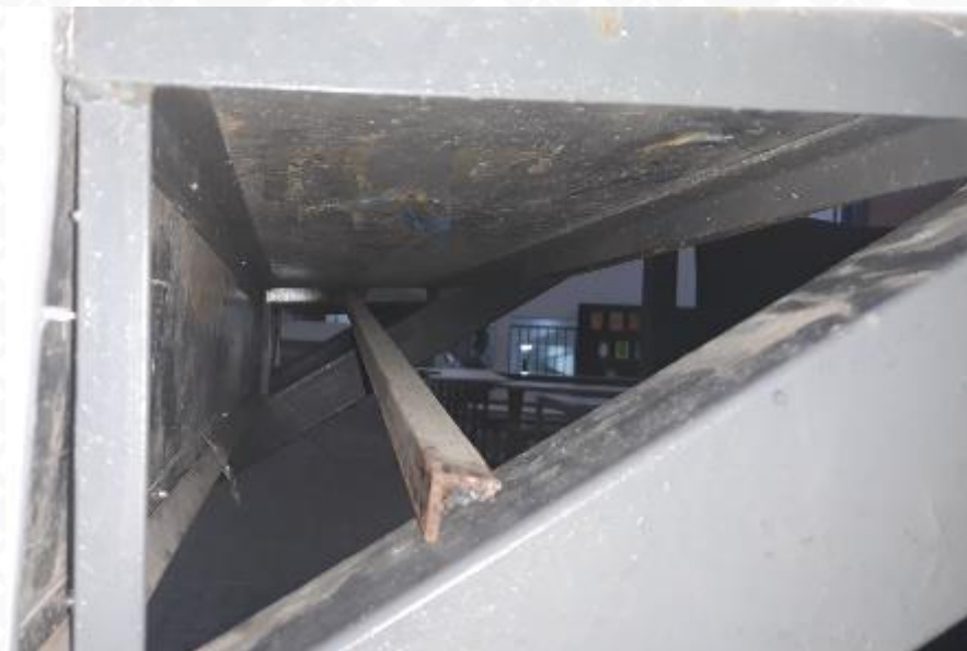
FIGURA 40 – ESCADAS METÁLICAS – SOLDAS SEM RESISTÊNCIA OU QUALIDADE
