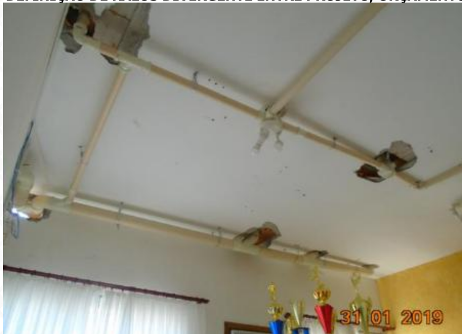
FIGURA 52 – DEFINIÇÃO DE RALOS DIVERGENTE ENTRE PROJETO, ORÇAMENTO E EXECUÇÃO
