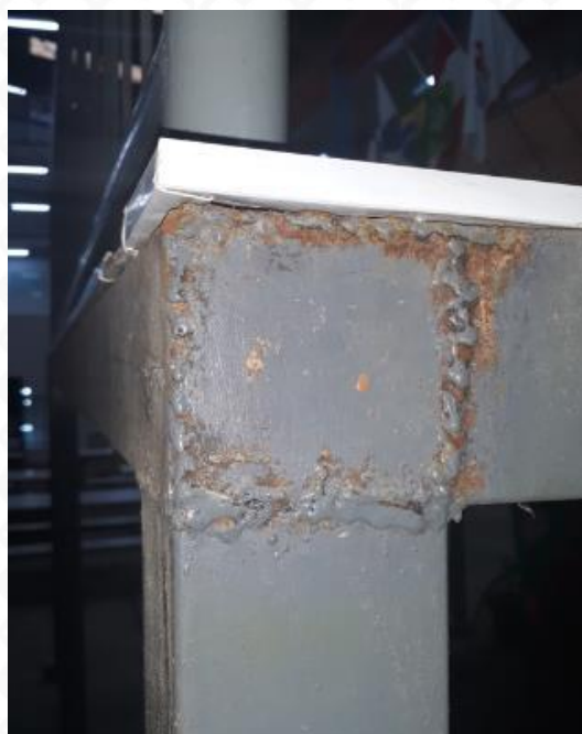
FIGURA 41 – ESCADAS METÁLICAS – SOLDAS SEM RESISTÊNCIA OU QUALIDADE
