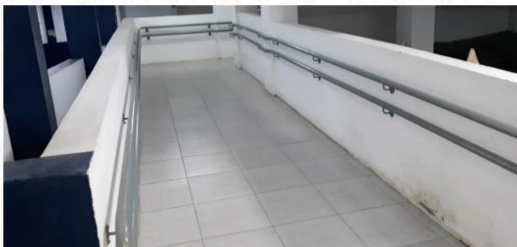
FIGURA 29 – FALTA DE RODAPÉ E UMIDADE
