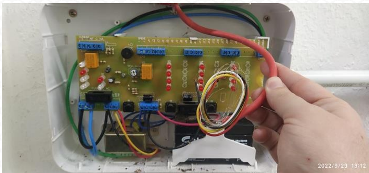
FIGURA 37 – SISTEMA DE ALARME INOPERANTE
