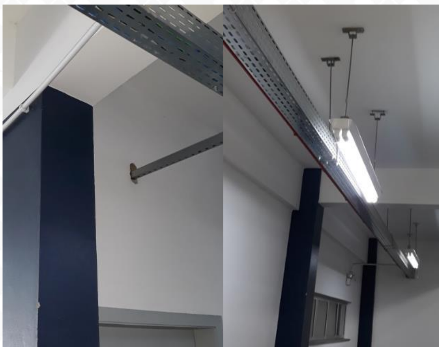
FIGURA 16 – ELETRODUTOS E CALHAS EM DESACORDO
