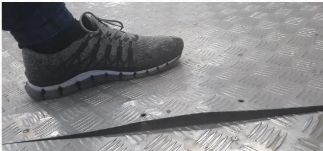
FIGURA 38 – ESCADAS METÁLICAS – MATERIAL INAPROPRIADO E RESISTÊNCIA DUVIDOSA
