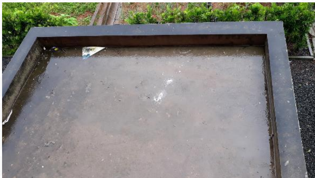
FIGURA 48 – CENTRAL DE GÁS – ÁGUA ACUMULADA NA LAJE
