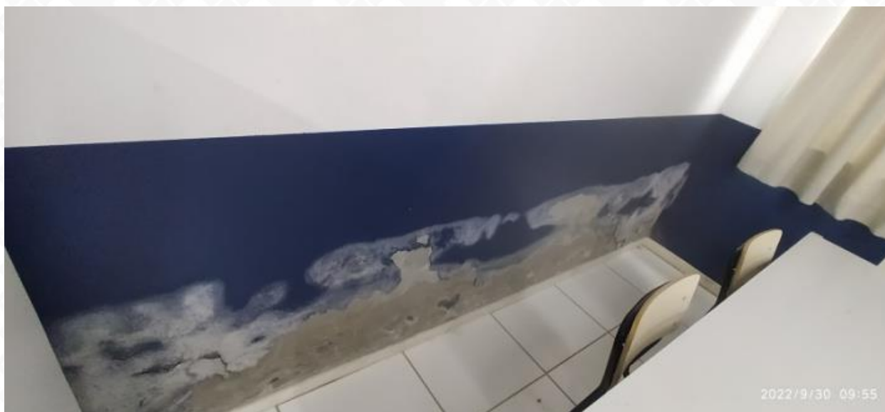
FIGURA 24 – SINAIS DE UMIDADE, EFLORESCÊNCIA, DEGRADAÇÃO E DESPLACAMENTOS
