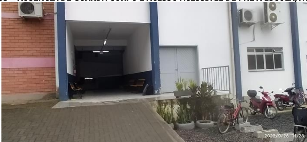
FIGURA 53 – AUSÊNCIA DE GUARDA CORPO E ACESSO ACESSÍVEL DE PNE A ESCOLA/AUDITÓRIO
