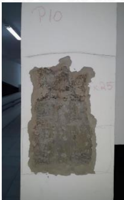
FIGURA 28 – FALTA DE ADENSAMENTO DE CONCRETO E “BICHEIRA”
