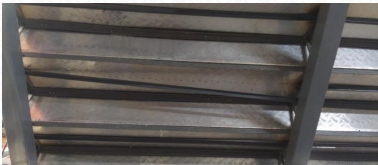
FIGURA 39 – ESCADAS METÁLICAS – MATERIAL INAPROPRIADO E RESISTÊNCIA DUVIDOSA
