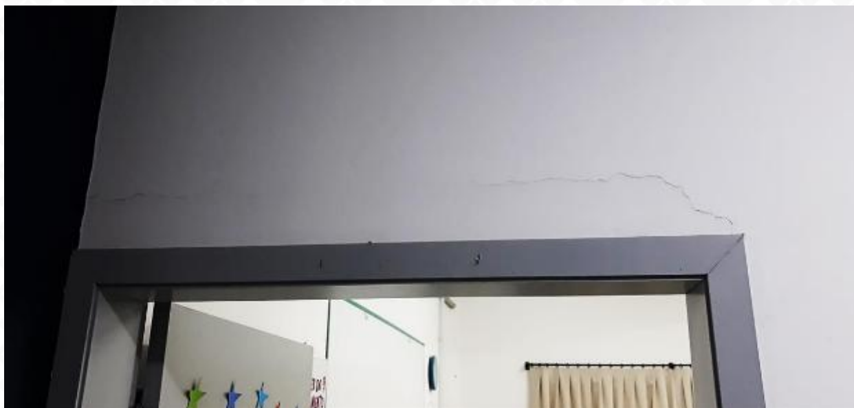
FIGURA 14 – FISSURAS POR FALTA DE VERGAS E CONTRA-VERGAS
