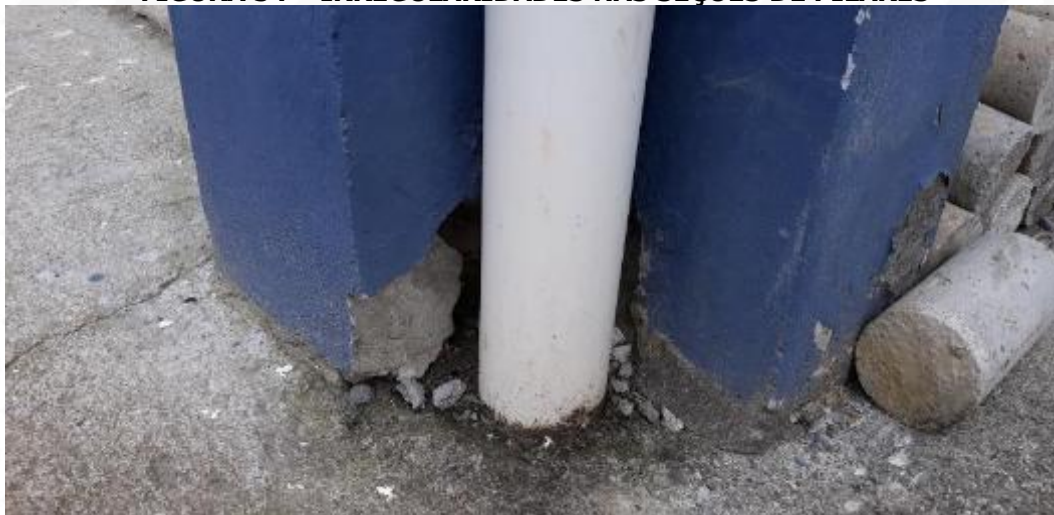
FIGURA 54 – IRREGULARIDADES NAS SEÇÕES DE PILARES
