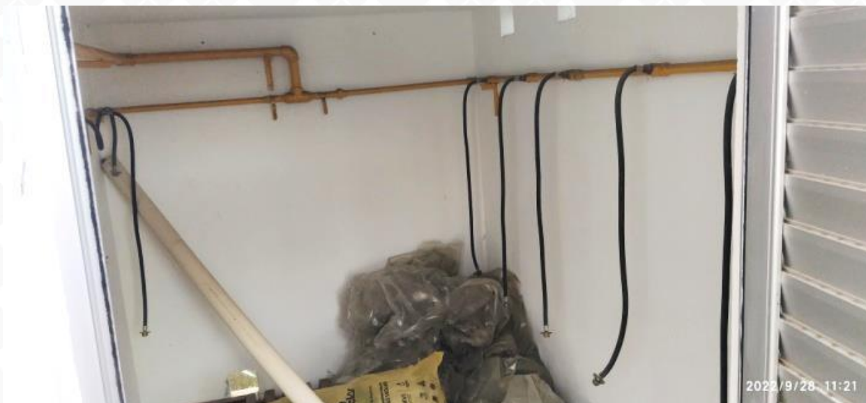
FIGURA 46 – CENTRAL DE GÁS – FALTA OS CILINDROS
