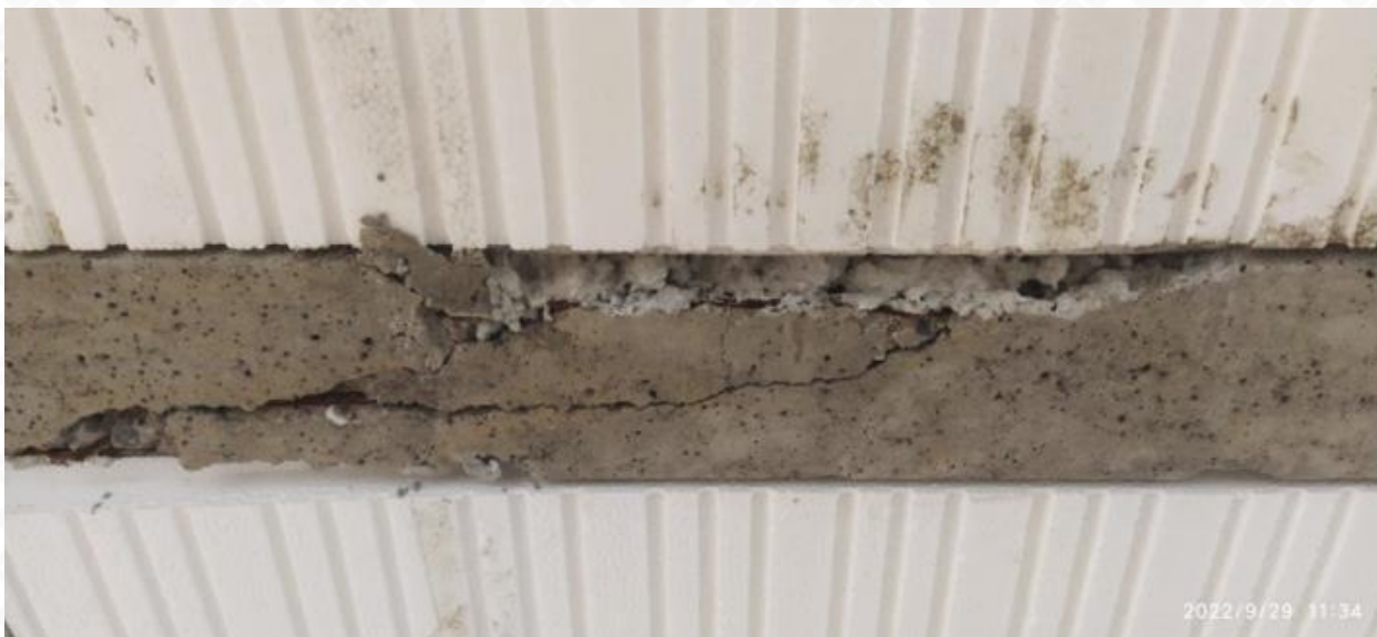
FIGURA 27 – VIGOTAS DAS LAJES DE RAMPAS COMPROMETIDAS
