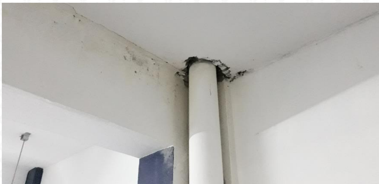
FIGURA 35 – FALTA DE ARREMATAMENTO NOS FUROS EM LAJES
