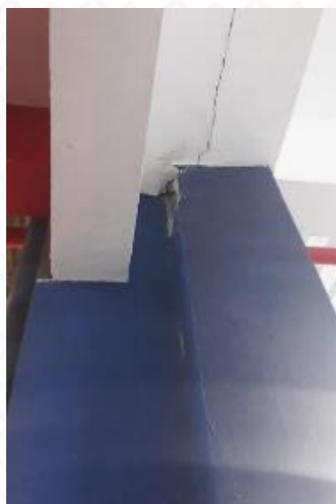
FIGURA 13 – ERRO DE CONCRETAGEM DE PILARES
