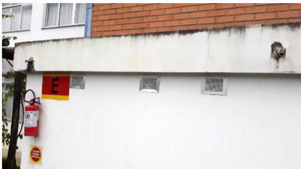
FIGURA 47 – CENTRAL DE GÁS – ÁGUA ACUMULADA NA LAJE
