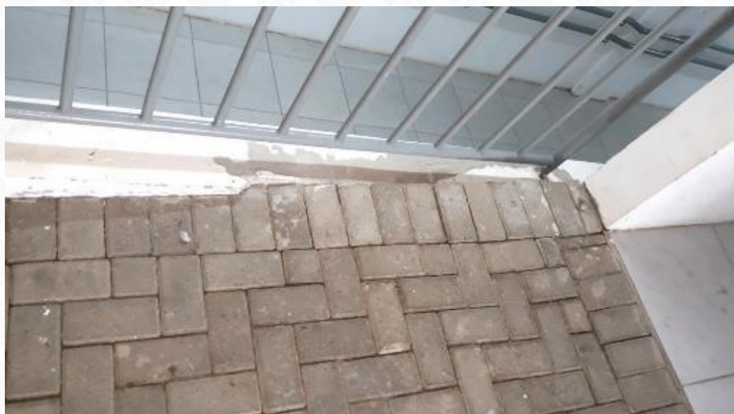
FIGURA 30 – FALTA DE ACABAMENTO E COMPATIBILIZAÇÃO DE PROJETO
