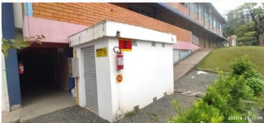
FIGURA 45 – CENTRAL DE GÁS – EXTINTOR EM LOCAL INCORRETO
