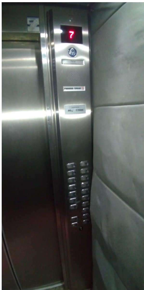
Foto 23 – Painel da cabine do elevador de serviço
