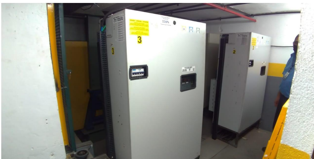
Foto 18 – Quadros de comando dos elevadores (cada elevador possui um)
