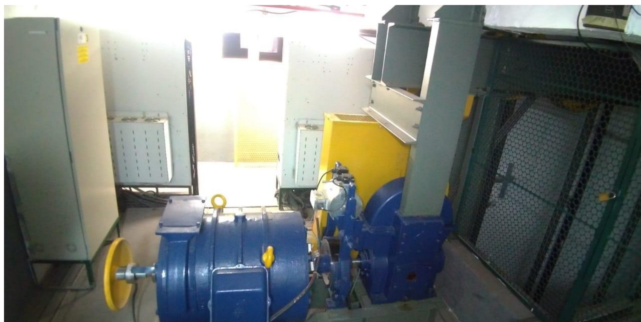
Foto 13 – Casa de máquinas, elevadores sociais
