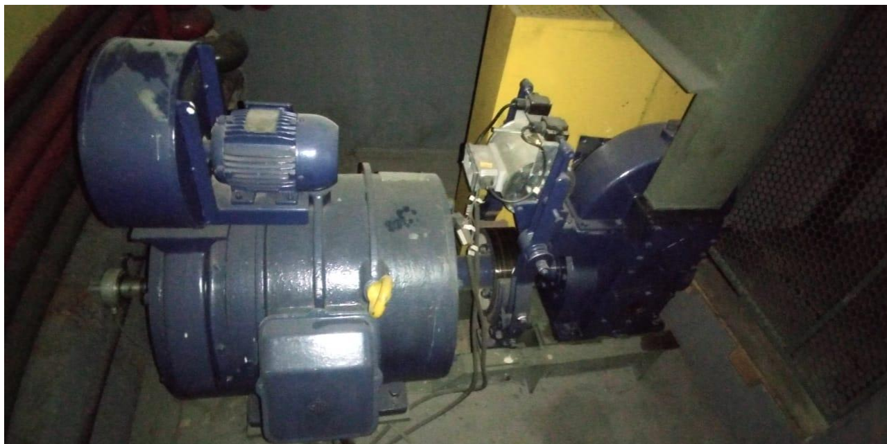
Foto 26 – Motor elevador de serviço
