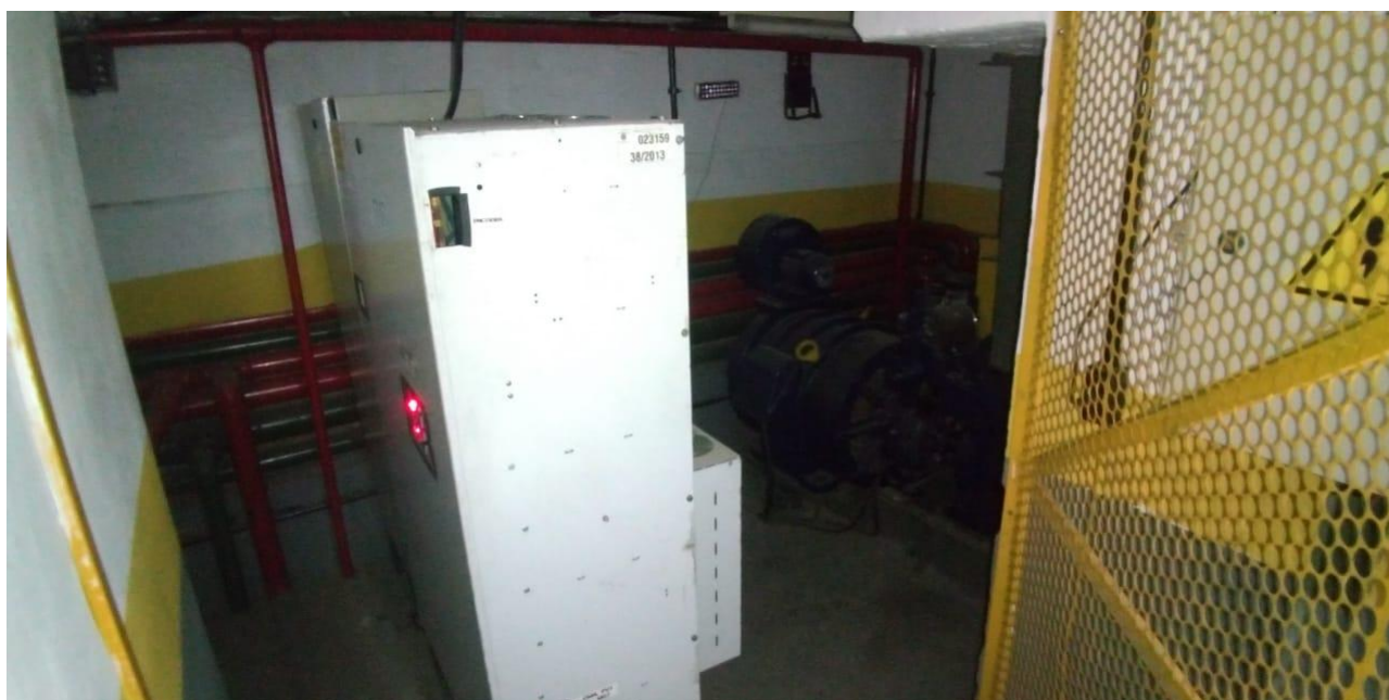
Foto 25 – Casa de máquinas, elevador de serviço
