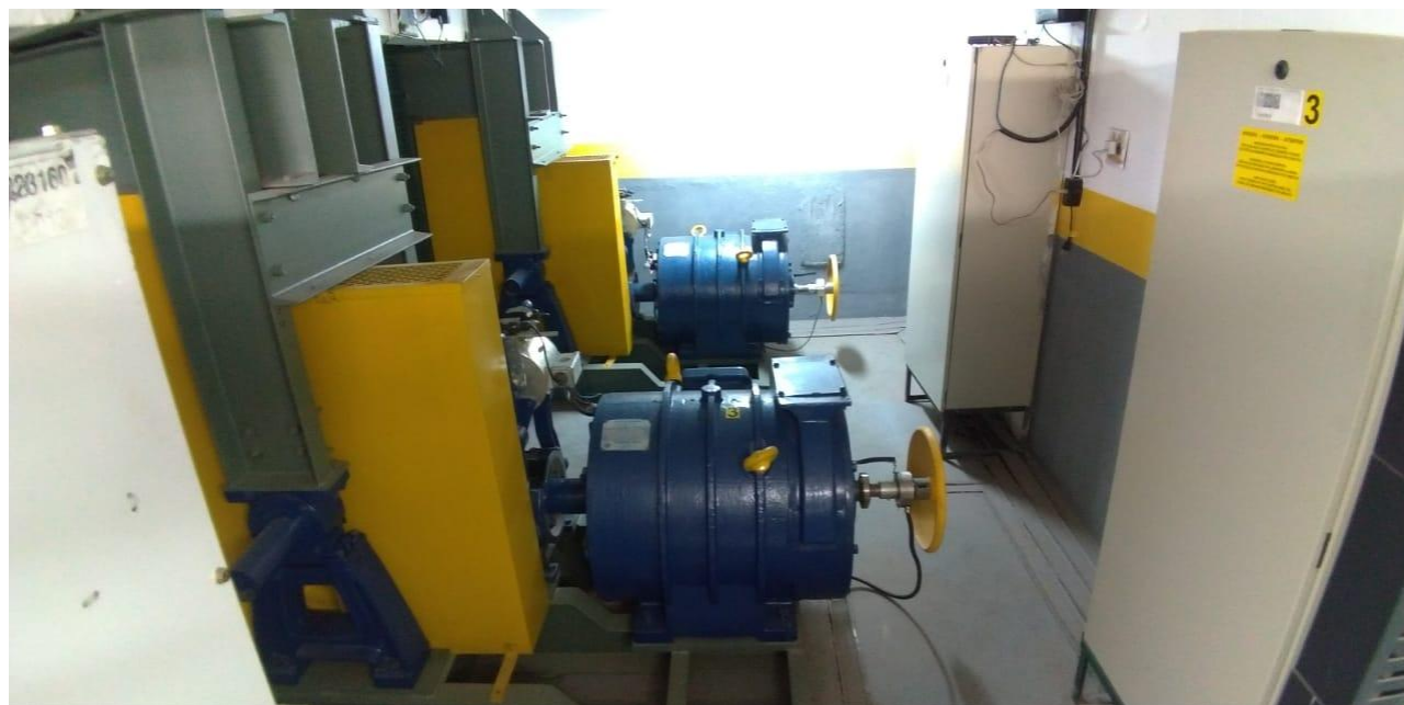
Foto 12 – Casa de máquinas, elevadores sociais
