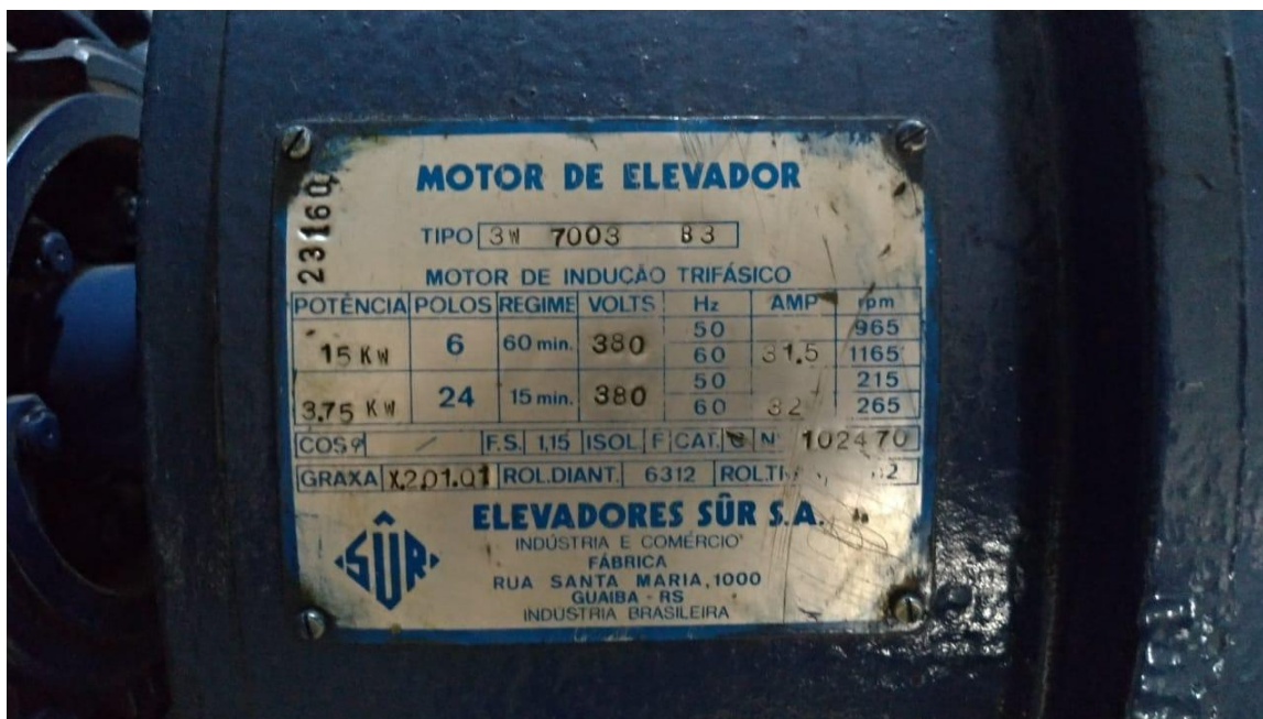
Foto 14 – Tarjeta de identificação com especificações dos motores dos elevadores sociais e de serviço
