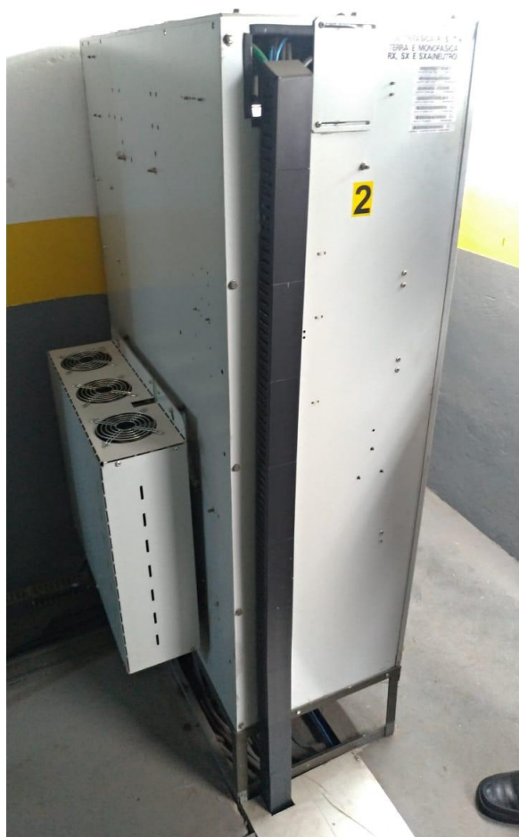
Foto 19 – Quadro de comando
