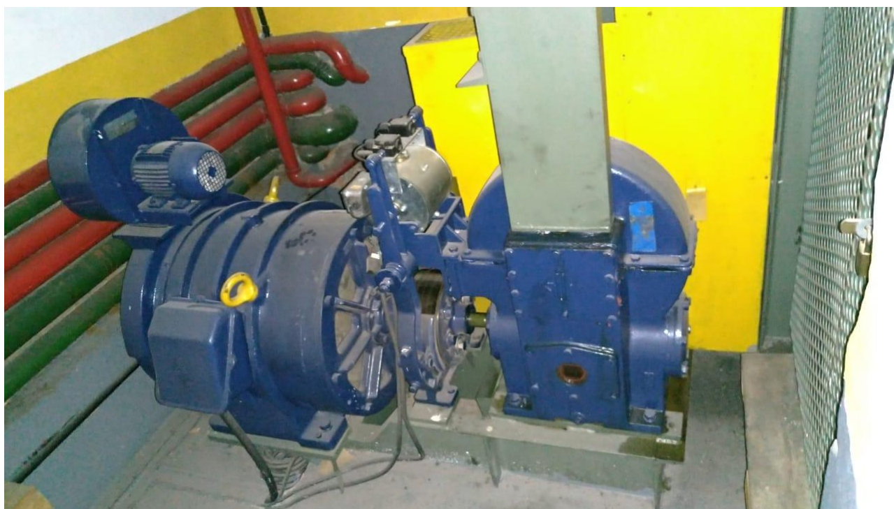
Foto 27 – Motor elevador de serviço
