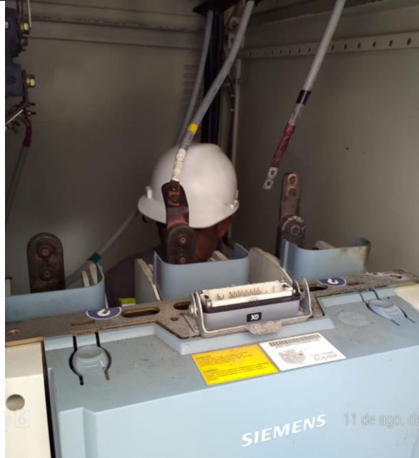
FOTO Nº 05: DETALHE DO DISJUNTOR QUE FOI RETIRADO
