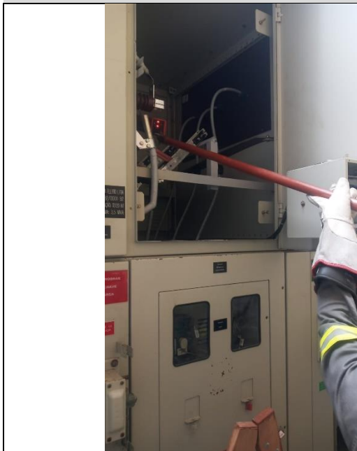
FOTO Nº 01: CONSTATANDO AUSÊNCIA DE TENSÃO
