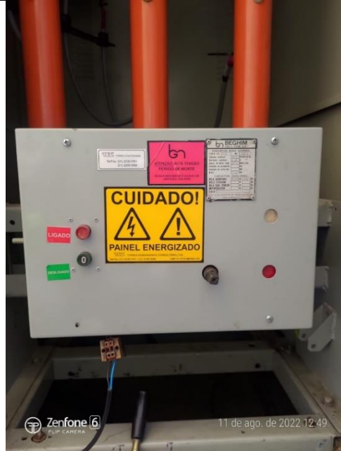
FOTO Nº 06: DETALHE DO DISJUNTOR PROVISÓRIO
