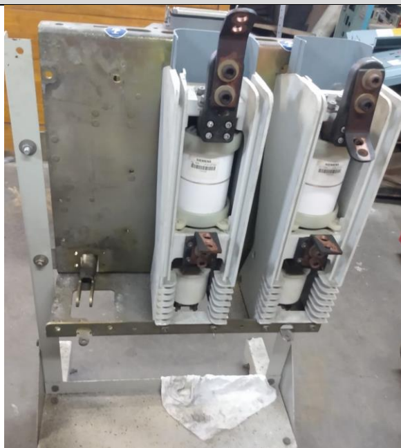
FOTO Nº 12: DETALHES DO DISJUNTOR QUE APRESENTOU DEFEITO
