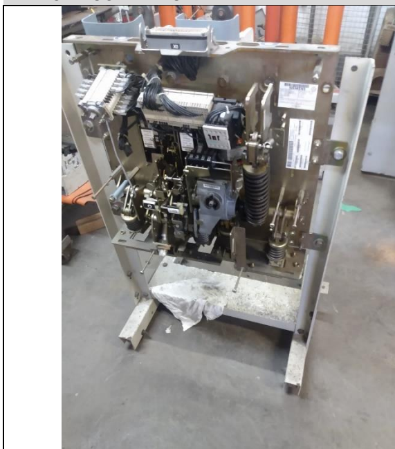
FOTO Nº 09: DETALHES DO DISJUNTOR QUE APRESENTOU DEFEITO
