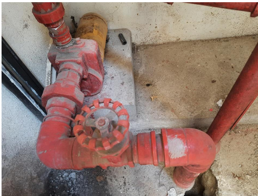
Foto 2 – Tubulação 63mm em PVC e bomba instalada
