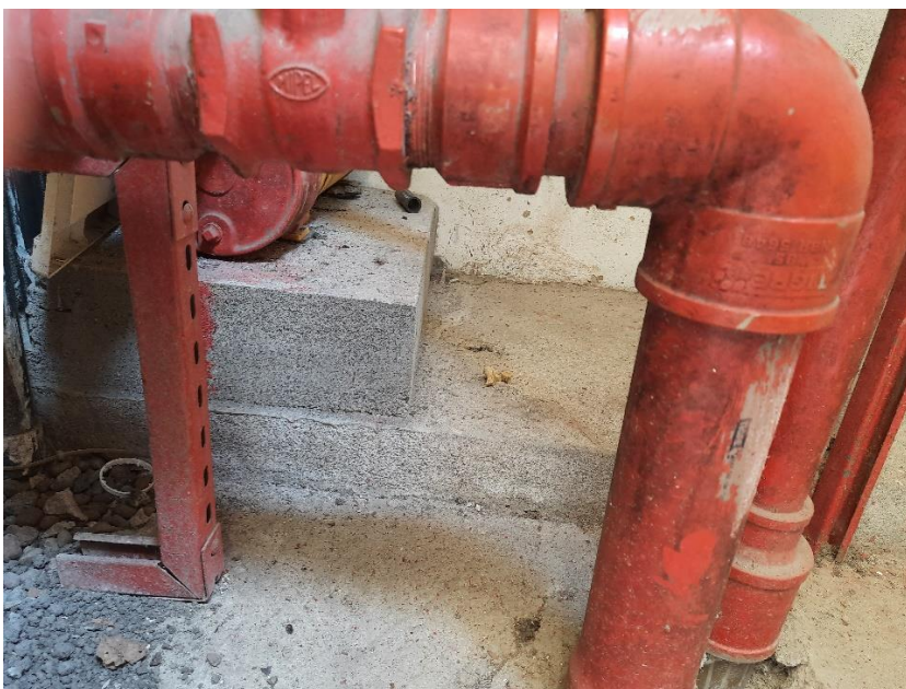
Foto 3 – Tubulação 63mm em PVC e bomba instalada
