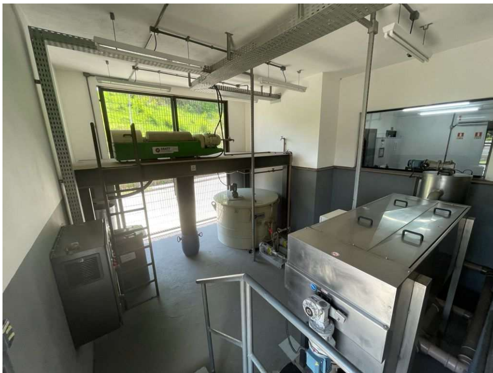
Foto 04: Sistema de adensamento de lodo
