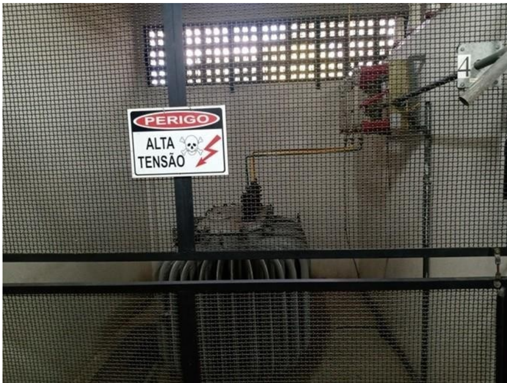
Cubículo de Transformação 3
