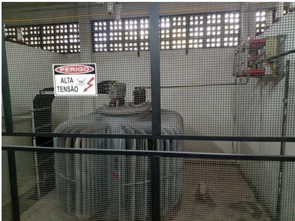
Cubículo de Transformação 2
