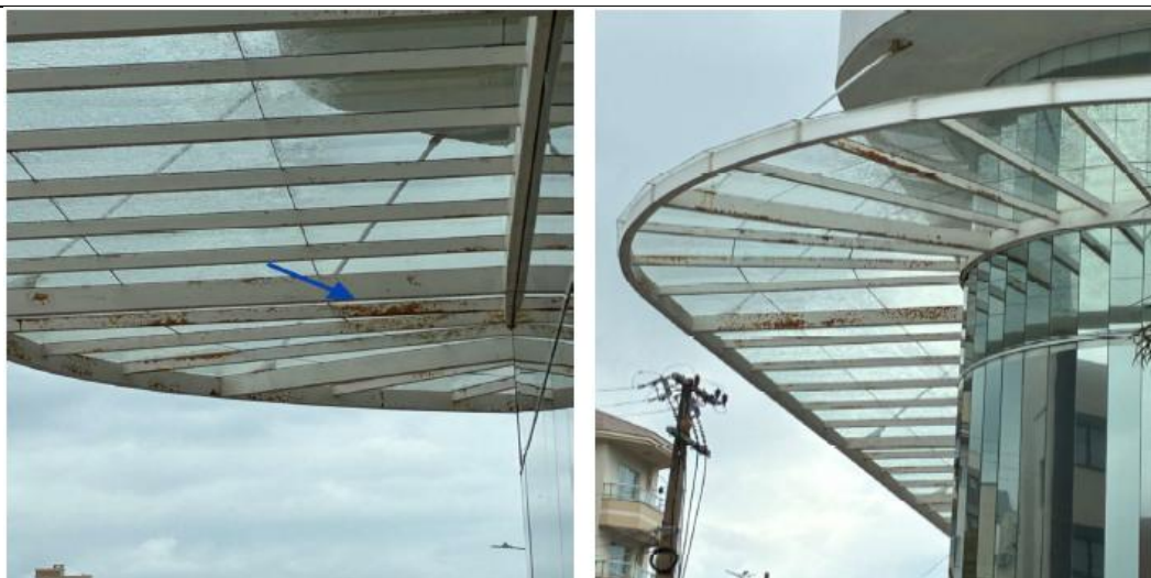
Imagens 04 e 05: Corrosão do pergolado metálico da fachada do prédio sede.
