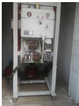
Disjuntor com defeito
