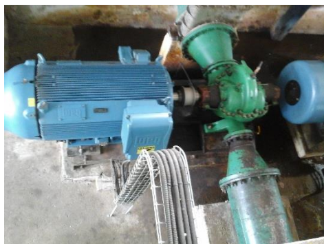
Motores para aciona
