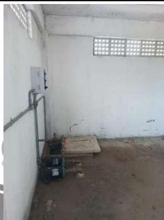
Figura 62- Sistema de recalque
