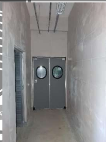
Figura 46 - Acesso às câmaras frias
