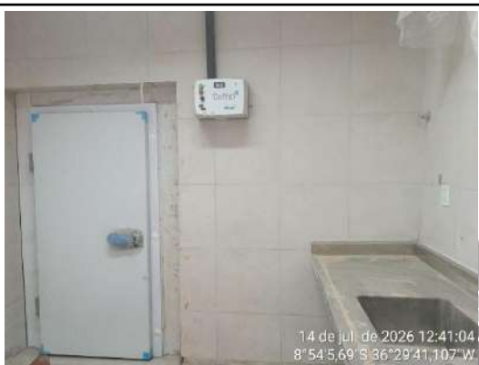
Figura 49 - Câmara fria para resfriados
