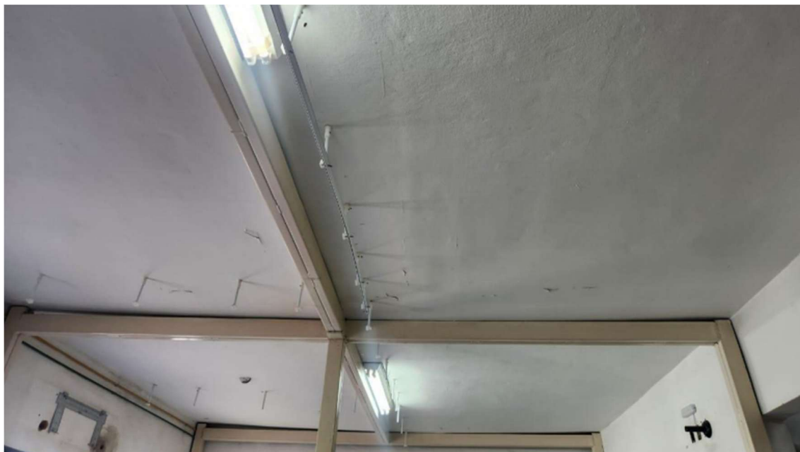
Foto da laje da enfermaria Ala C: Registro do abaulamento da laje, evidenciando deformação fora do plano original, bem como a estrutura metálica instalada para suporte e sustentação provisória para evitar o colapso.
