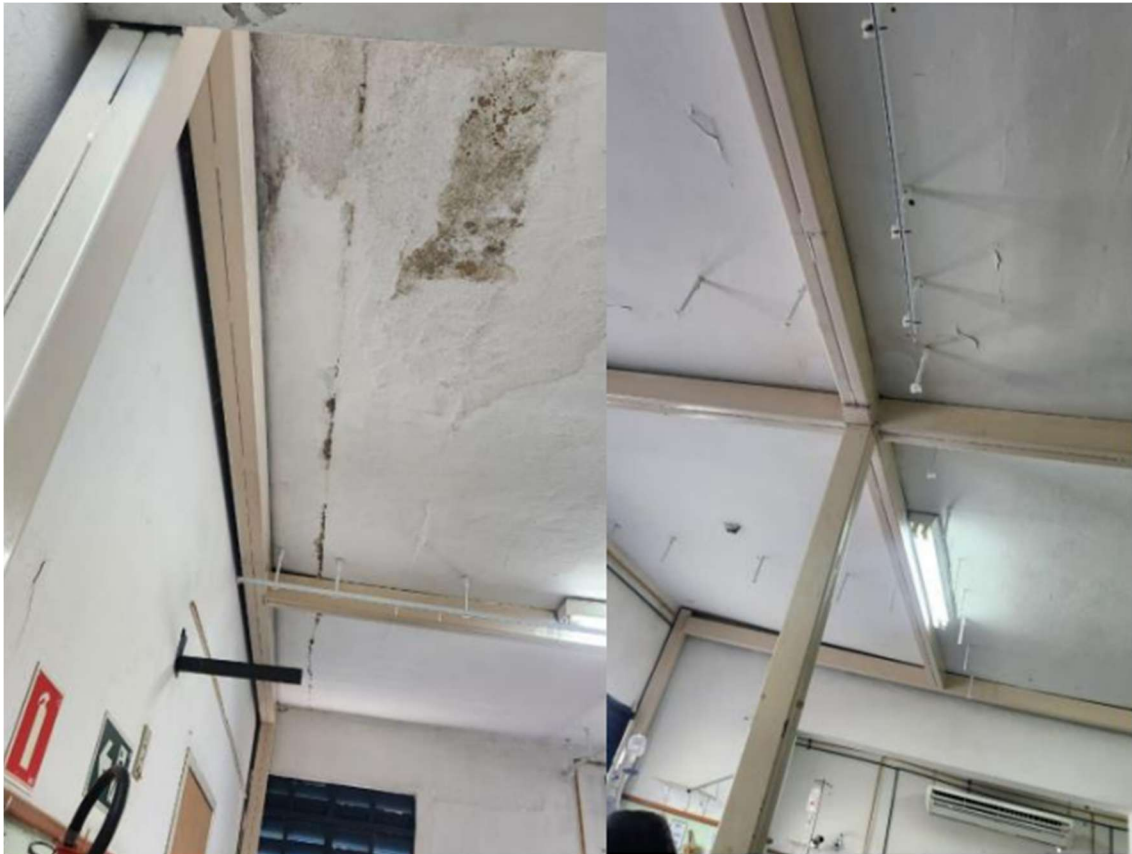
Foto da laje da enfermaria Ala C: Registro das fissuras na laje e da estrutura metálica instalada para sua sustentação.
