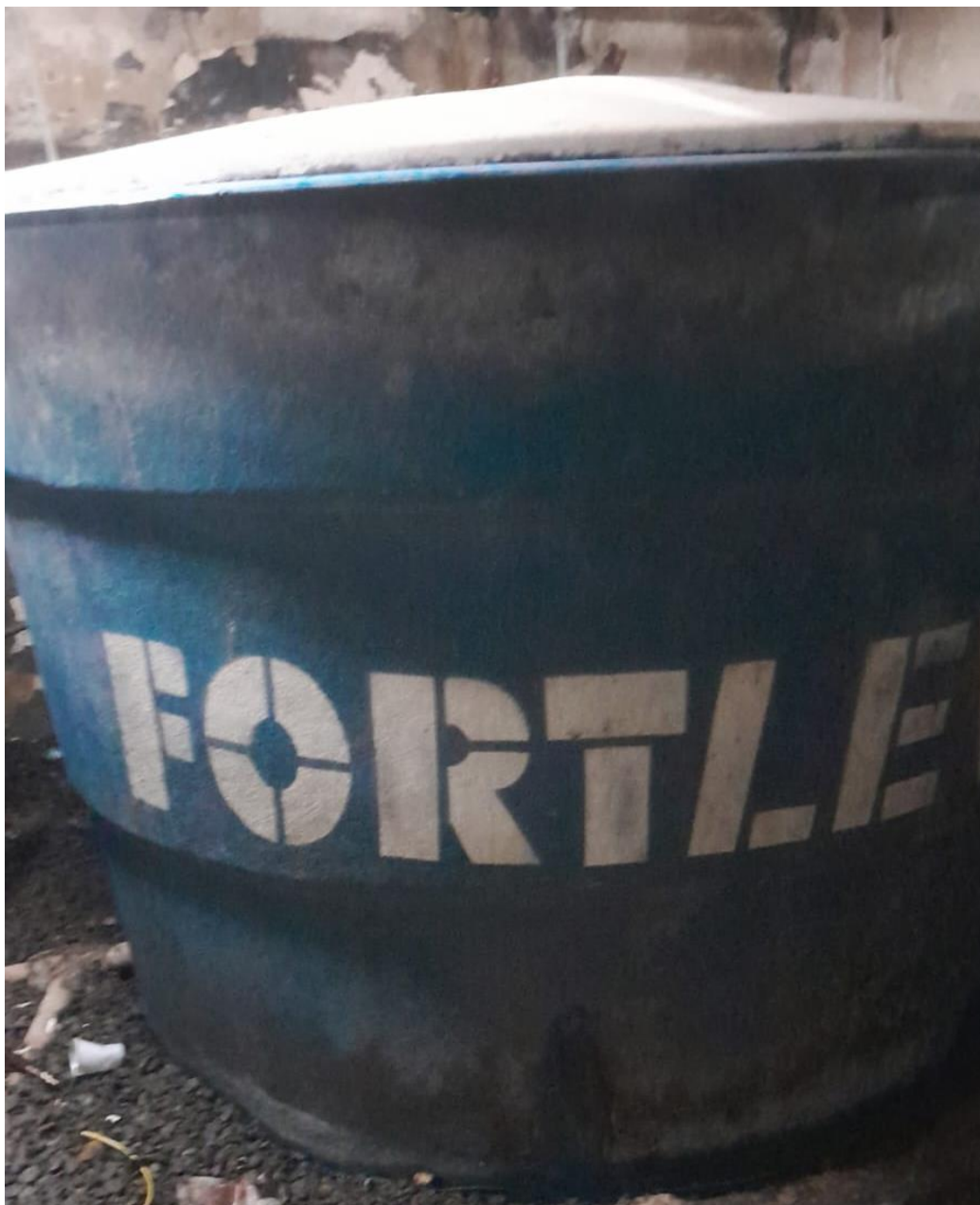
Imagem 1 – Caixa d'água apresentando avarias com risco de rompimento
