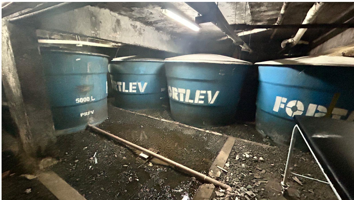
Imagem 5 – Local onde as caixas de água estão alocadas atualmente
