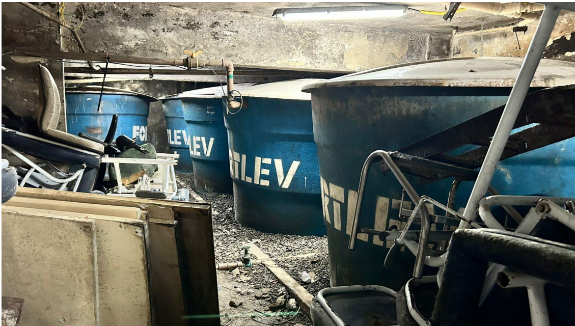
Imagem 7 – Local onde as caixas de águas estão alocadas juntamente com os mobiliários obsoletos
