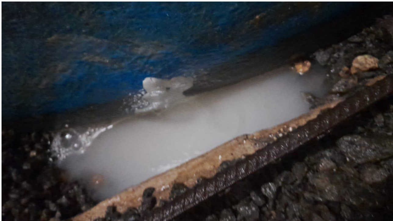
Imagem 4 – Furo na caixa d'água, ocasionando vazamento contínuo e comprometimento no abastecimento de água da unidade
