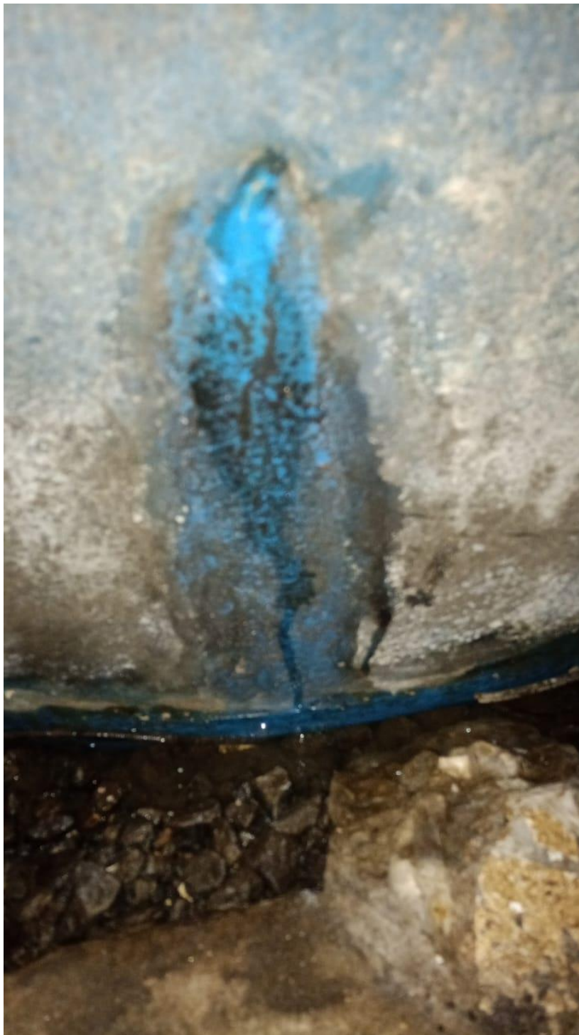
Imagem 3 – Furo da Caixa d'água trazendo risco de rompimento
