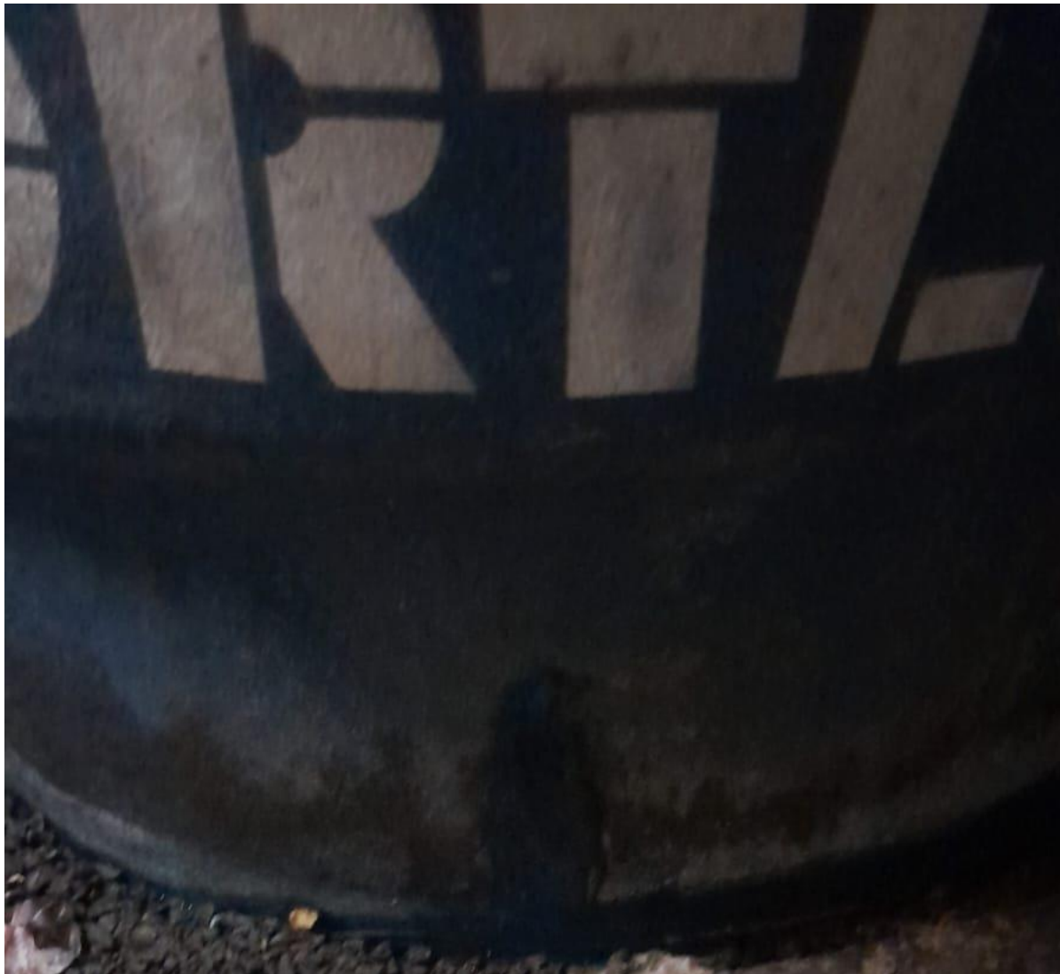
Imagem 2 - Caixa d'água apresentando avarias com risco de rompimento
