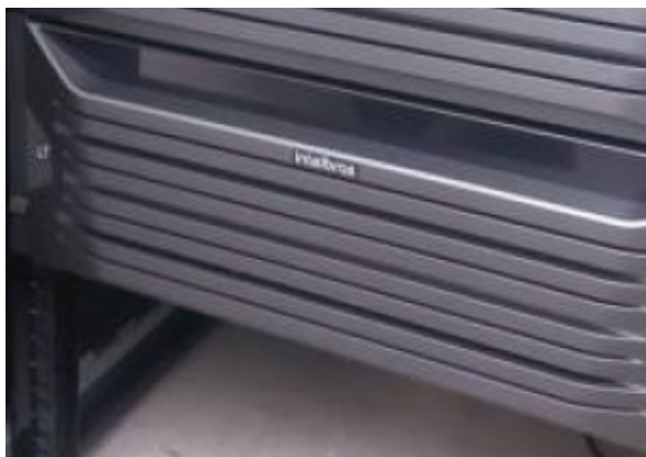
Figura 5 - Ilustração do storage redundante a ser migrado para sala de equipamentos no prédio SUPGUA
