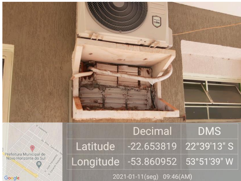
(Caixa suporte para ar condicionado)
