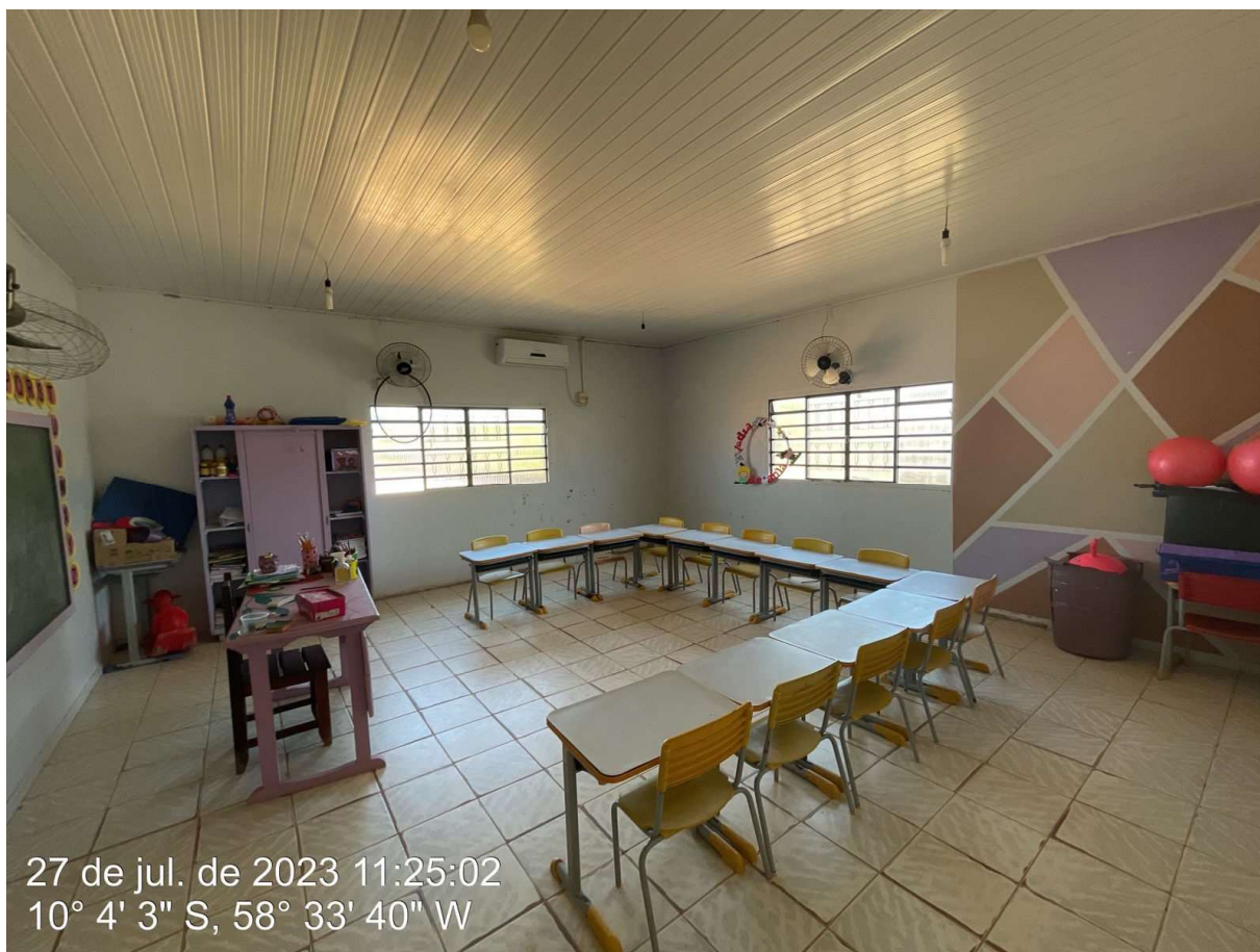
Salas de aula do bloco do fundo a reformar com troca de piso, forro, cobertura, instalações e nova pintura.
