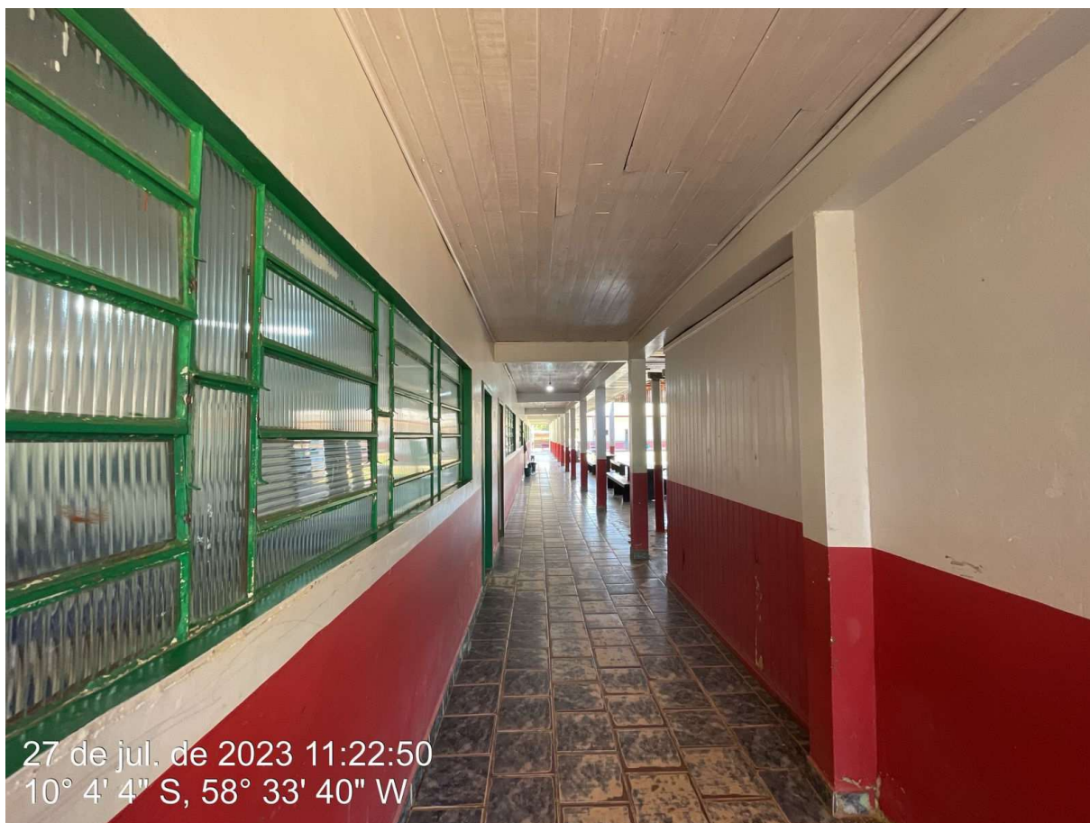
Circulação entre blocos – a reformar com troca de piso, forro, cobertura, instalações e nova pintura.
