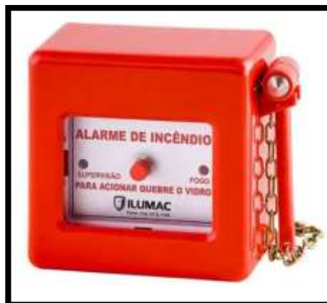
Figura 8 - Botoeira - acionamento do alarme
