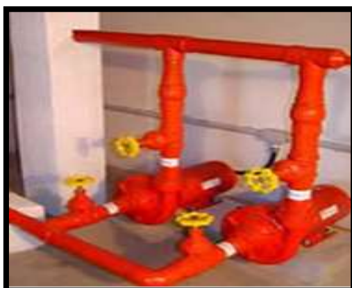
Figura 16 - Bomba de Incêndio
