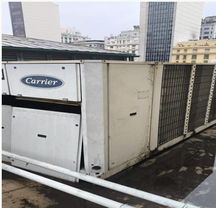
Chillers Condensação a ar 02
