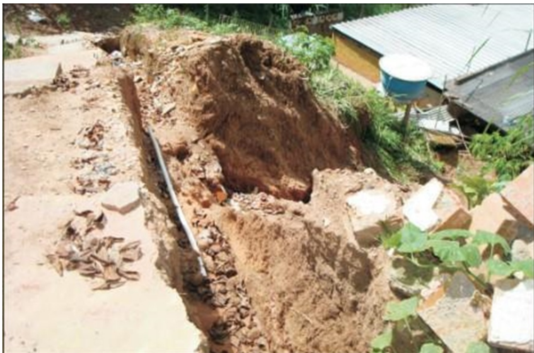
Figura 08: Fotografia de localidade em Vila Nova, após o incidente de 2011 (Fonte: CPRM)
