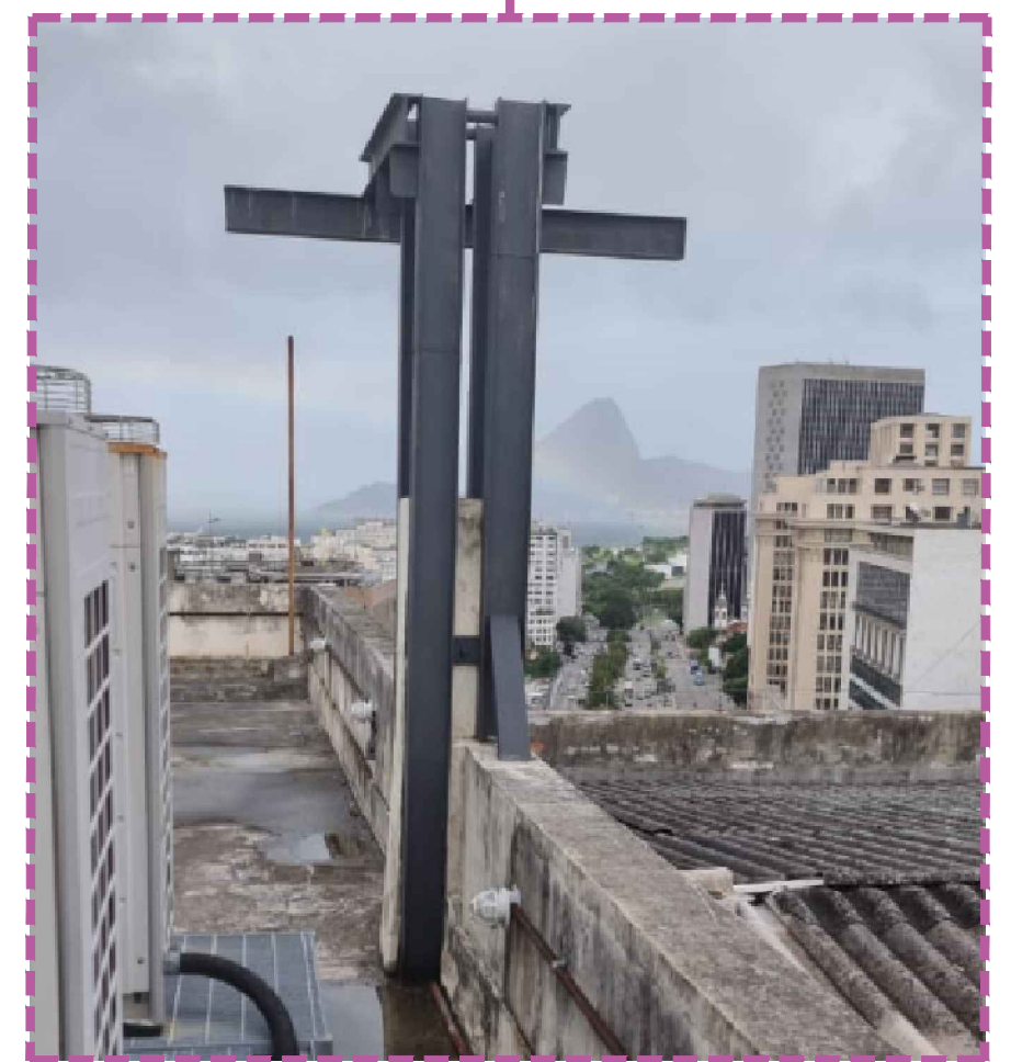
ESTRUTURA PARA IÇAMENTO
