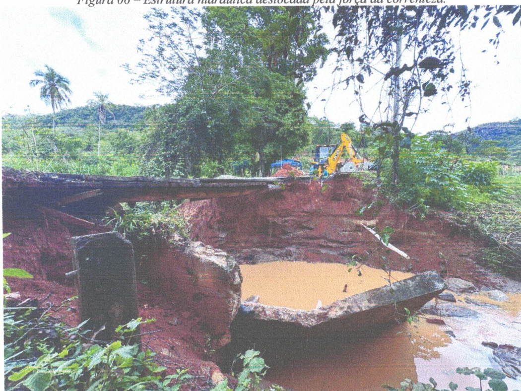
Figura 07 – Perda do maciço lateral de apoio da ponte.
