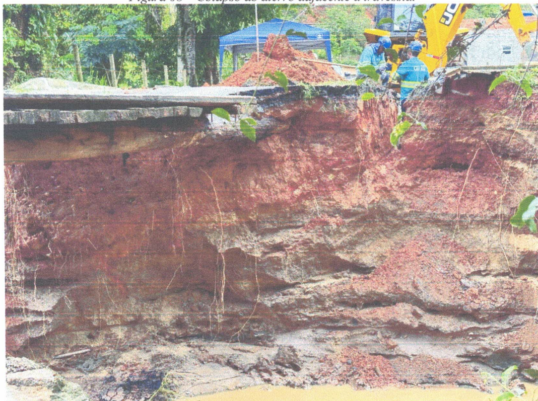
Figura 09 – Processo erosivo ativo junto à cabeceira.
