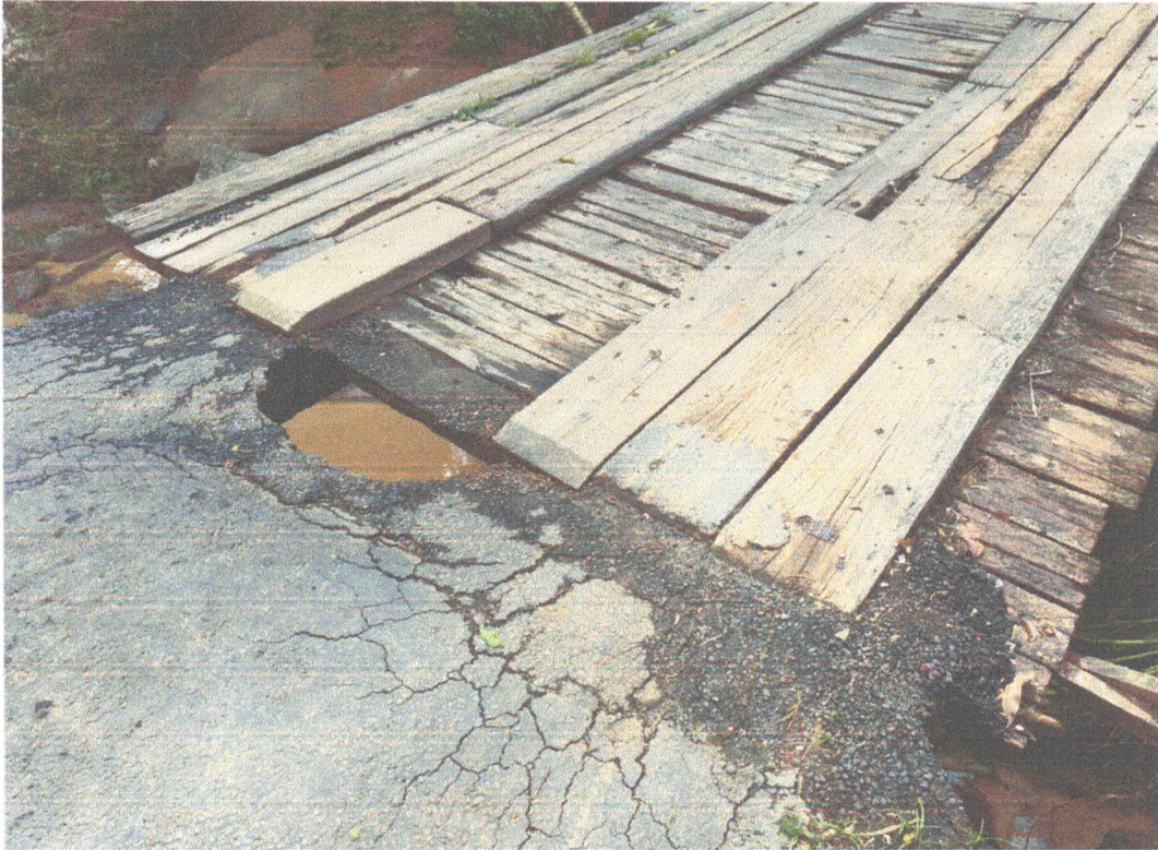
Figura 04 – Detalhe da ruptura do pavimento e presença de vazios.
