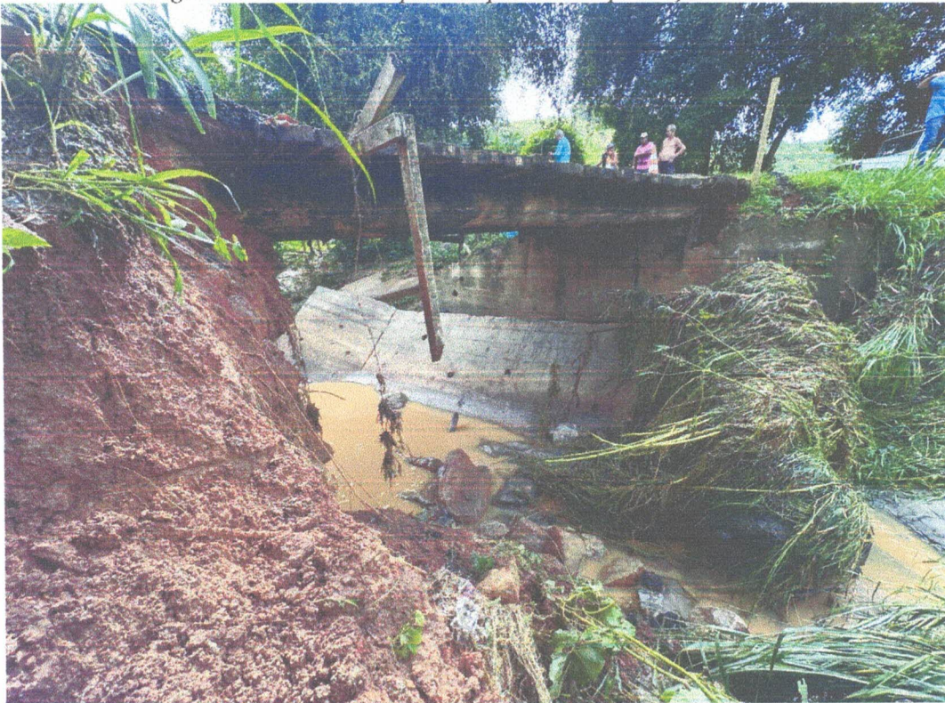
Figura 05 – Vista inferior da ponte e erosão das margens.
