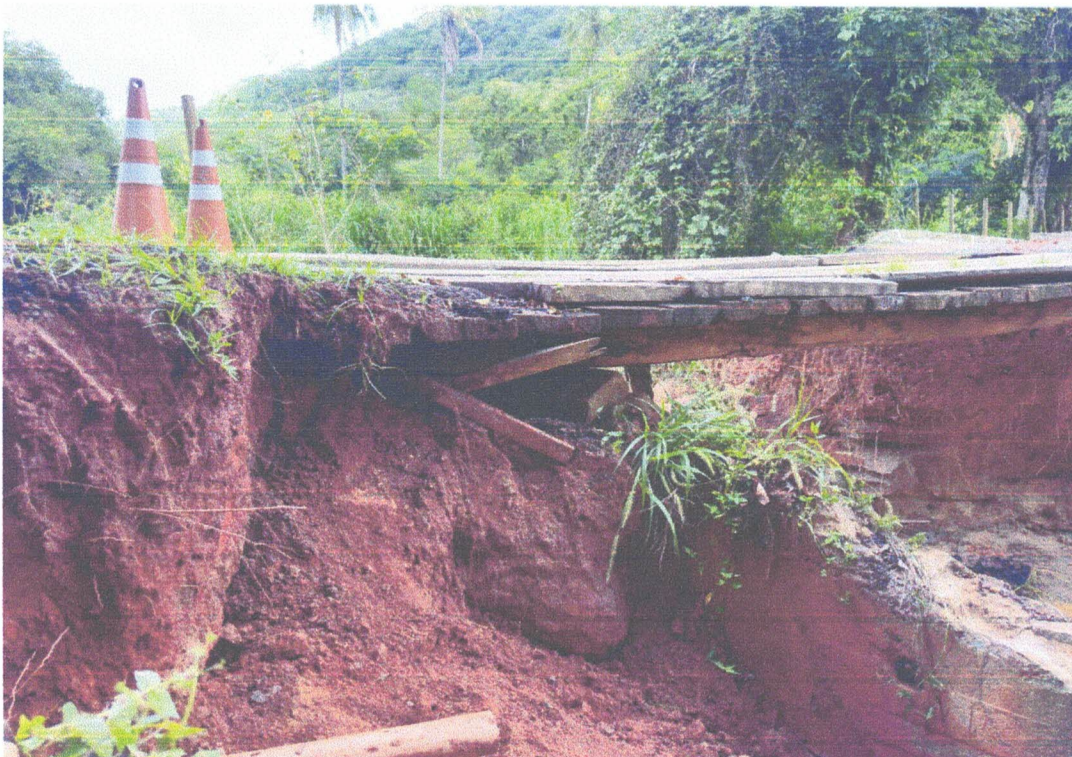
Figura 12 – Detalhe do comprometimento estrutural da ponte.
