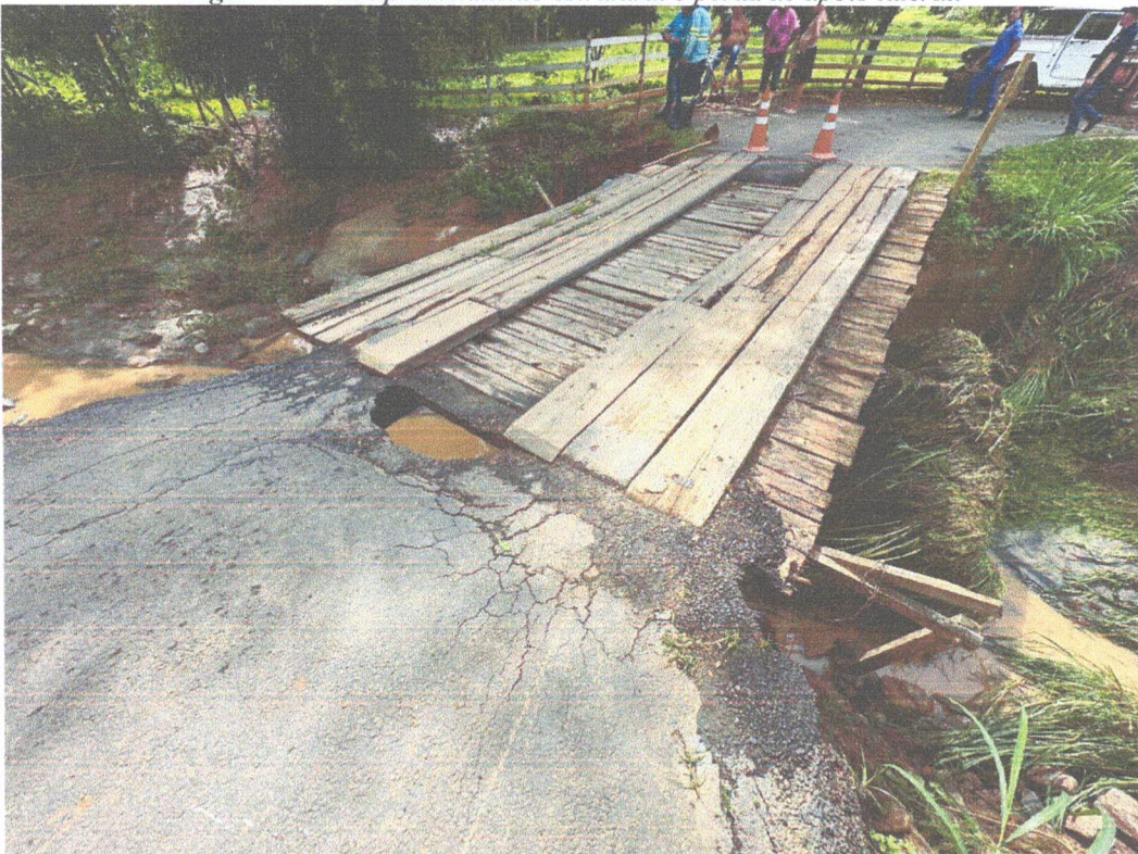
Figura 03 – Danos no tabuleiro e no pavimento de acesso.
