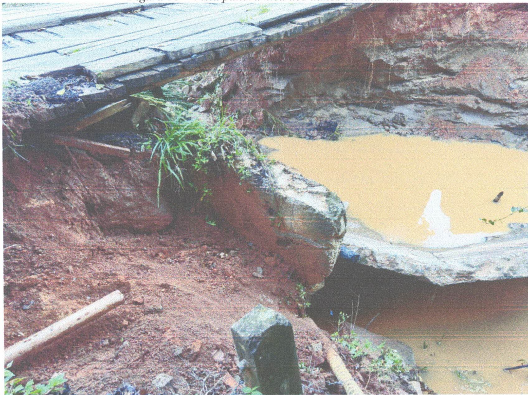
Figura 11 – Estrutura parcialmente sustentada pelos vigamentos remanescentes.
