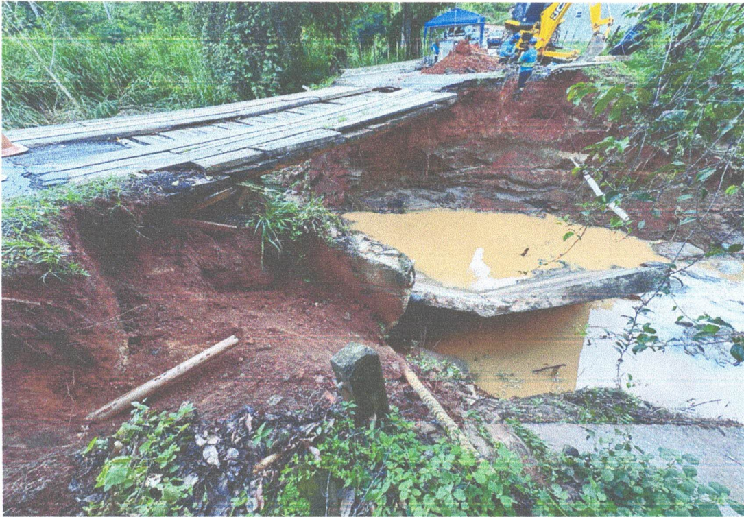
Figura 10 – Vista panorâmica dos danos estruturais.
