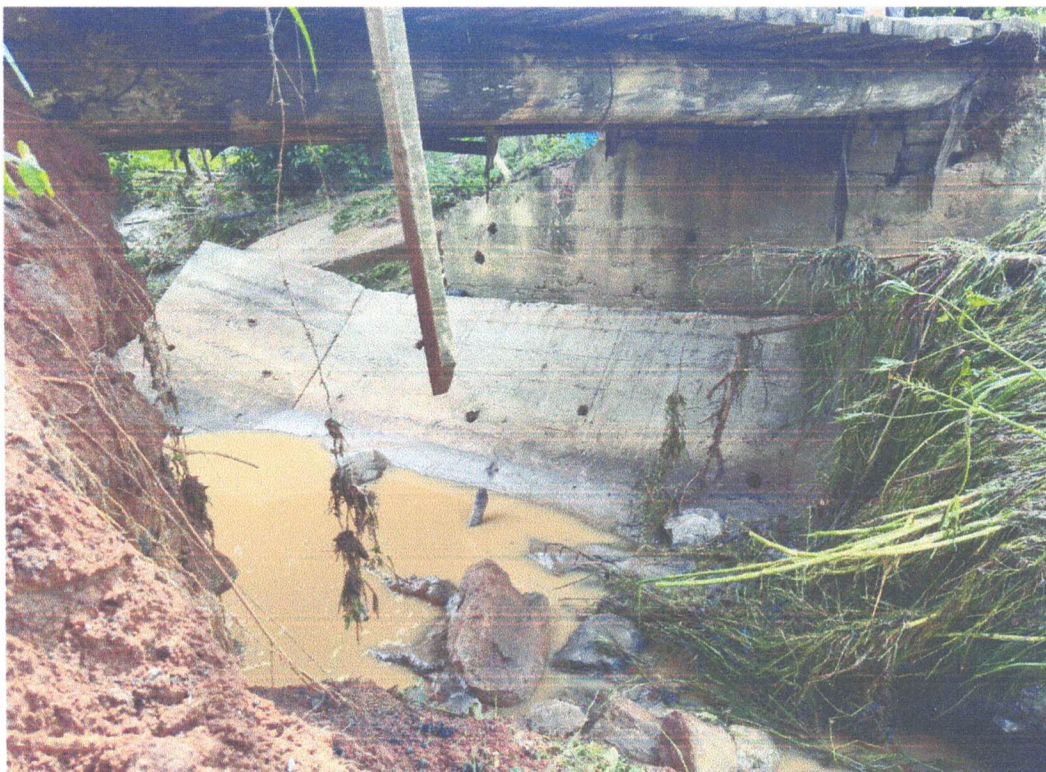
Figura 06 – Estrutura hidráulica deslocada pela força da correnteza.
