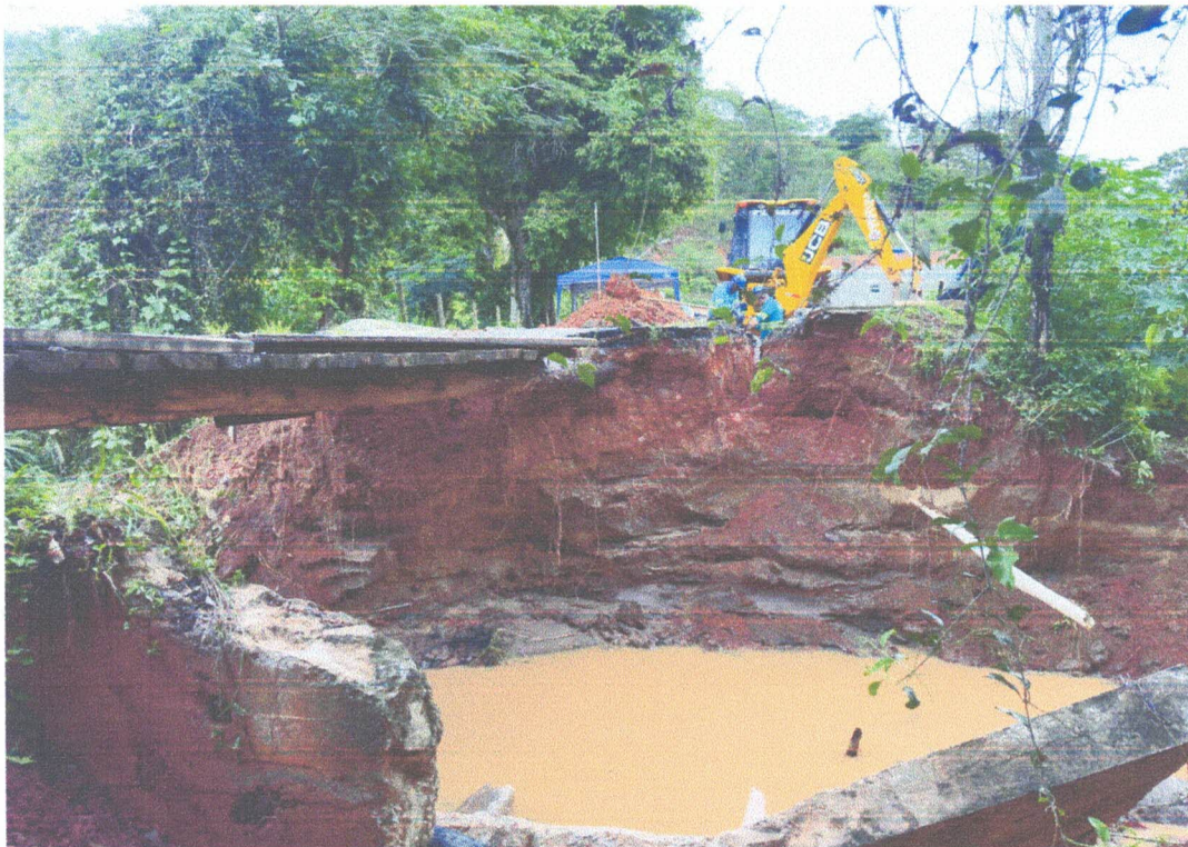
Figura 08 – Colapso do aterro adjacente à travessia.
