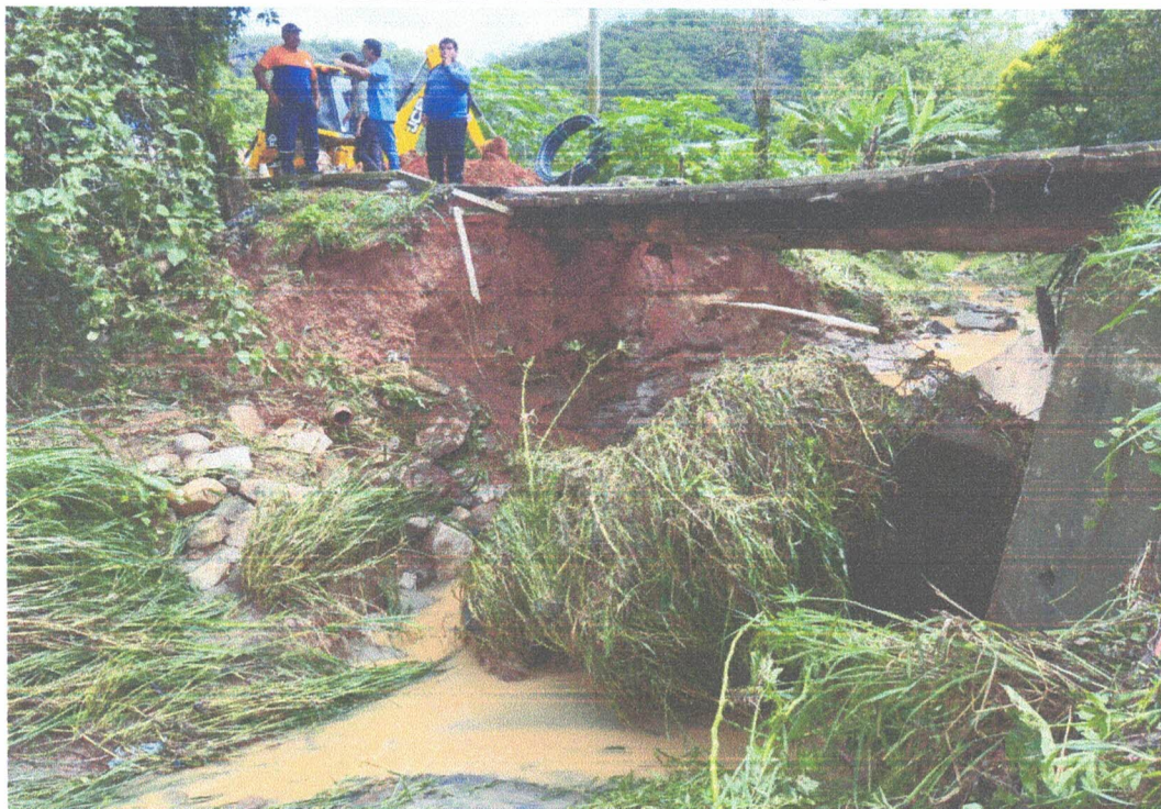
Figura 01 – Processo erosivo severo sob a estrutura da ponte.
