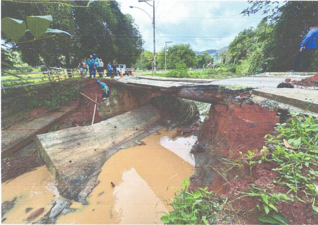
Figura 02 – Comprometimento estrutural e perda de apoio lateral.
