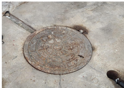
07 - Poço de coleta de água de chuva provenientes da rampa
