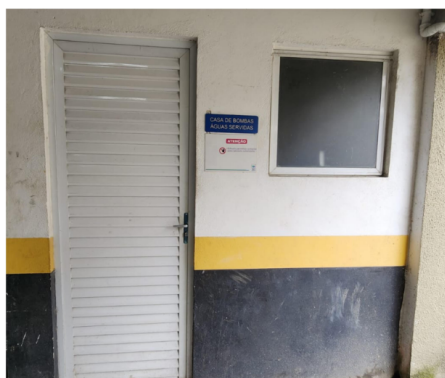
06 - Acesso ao poço de coleta de água de chuva
