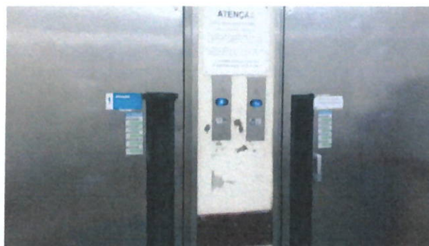
Figura 01 - Elevador do grupo 1
