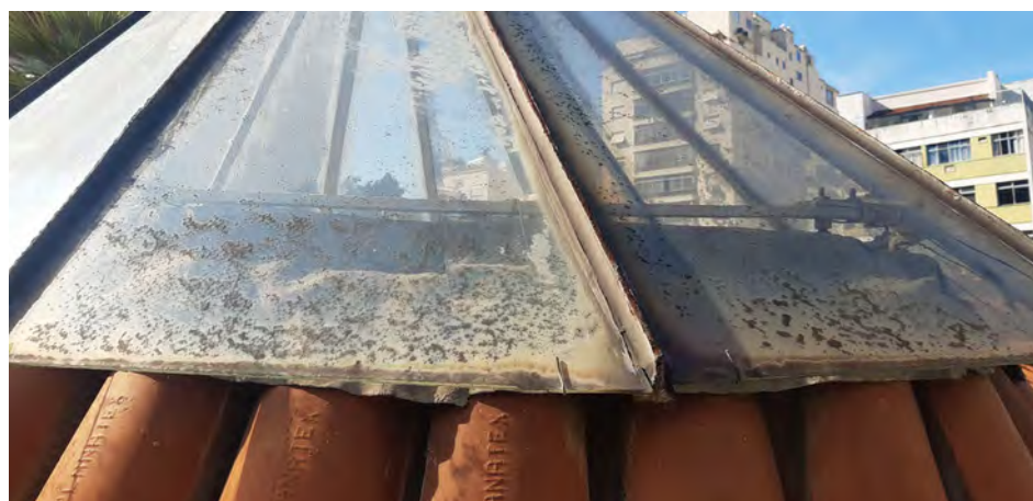
Foto 16: Vidros da clarabóia apresentando desgaste e corrosão na estrutura metálica.
