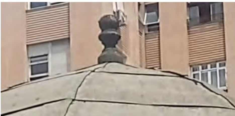
Foto 153: Adorno de união das chapas do Quiosque apresenta desgastes na pintura e no suporte.
