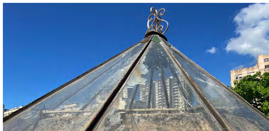
Foto 17: Danos similares ao da foto anterior, atentando para o detalhe superior metálico, que também apresenta corrosão e onde ocorre a junção dos vidros e da estrutura metálica.
