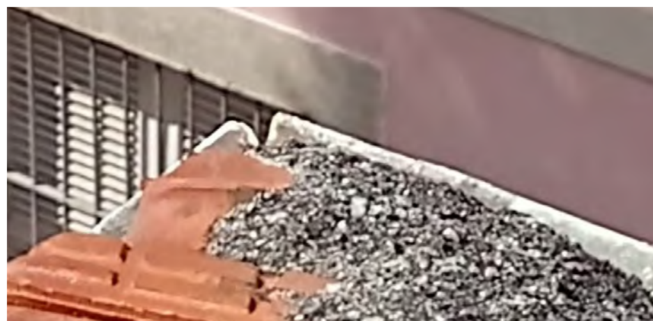
Foto 28: Pingadeira em chapa metálica abaixo das telhas está deformada, deixando trecho da platibanda exposto - VER DET. 01
