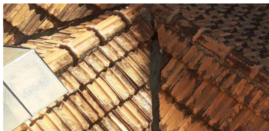
Foto 48: Encontro entre cumeeiras e rincões das coberturas TE 03 e 04, apresentando estrutura e impermeabilização expostos e telhas com sujeidades.
