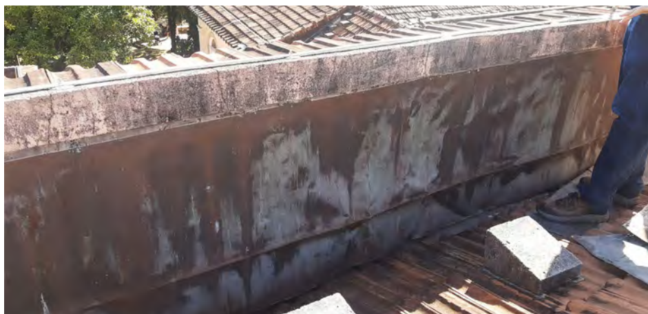
Foto 12: As saias de cobre apresentam deterioração em geral, como corrosão, desprendimento da platibanda (ressecamento da argamassa de fixação) e trechos com rasgo. Vet det. 01.
