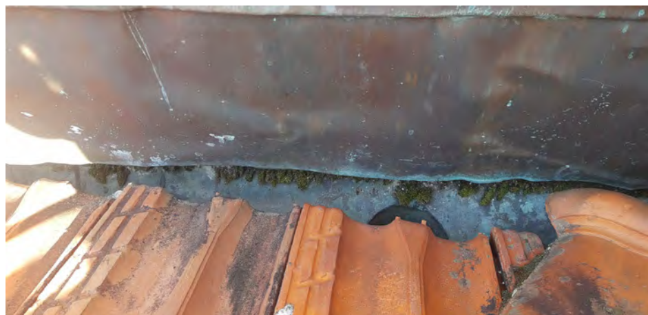
Foto 10: Presença de vegetação partindo por de trás das saias de cobre fixadas nas platibandas.
