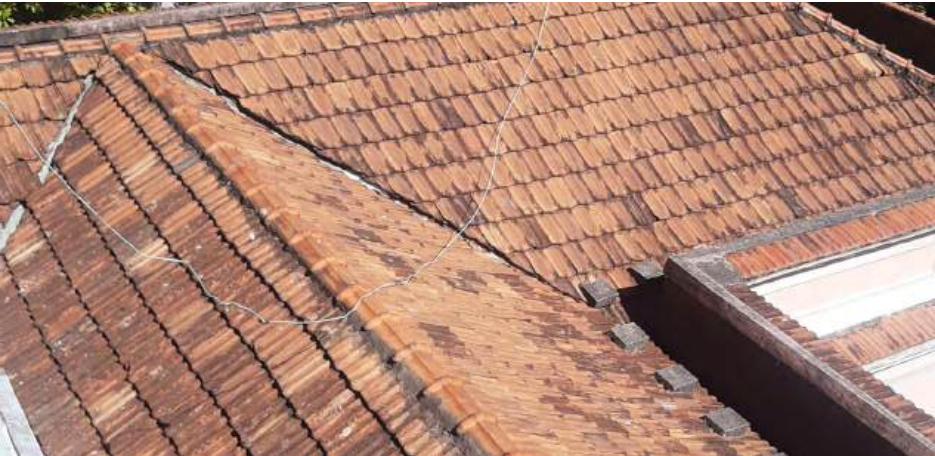
Foto 33: Lateral esquerda da cobertura, evidenciando os encontros entre coberturas (rincão) com a subcobertura (tyvek) exposta, o que acarreta o ressecamento da mesma. Além disso, a cumeeira apresenta argamassa excessiva, telhas com sujidades e pátina orgânica.
