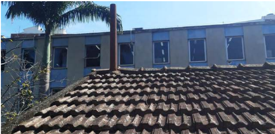
Foto 138: Vista de trecho da cobertura em direção a cumeeira, apresentando telhas com sujidades e pátina orgânica. O acabamento lateral das telhas de cumeeira em argamassa apresenta ressecamento e risco de porosidade.
