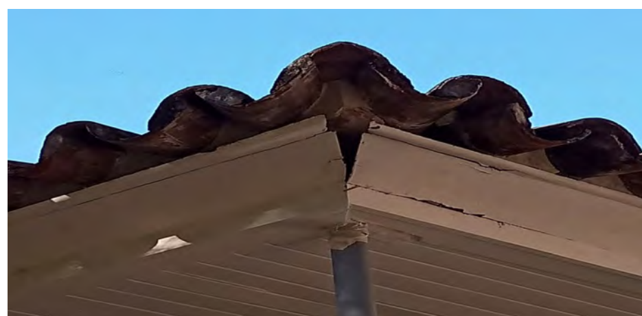
Foto 110: Sanca de acabamento em madeira com desprendimento e fissuras, que permitem infiltração de água.
