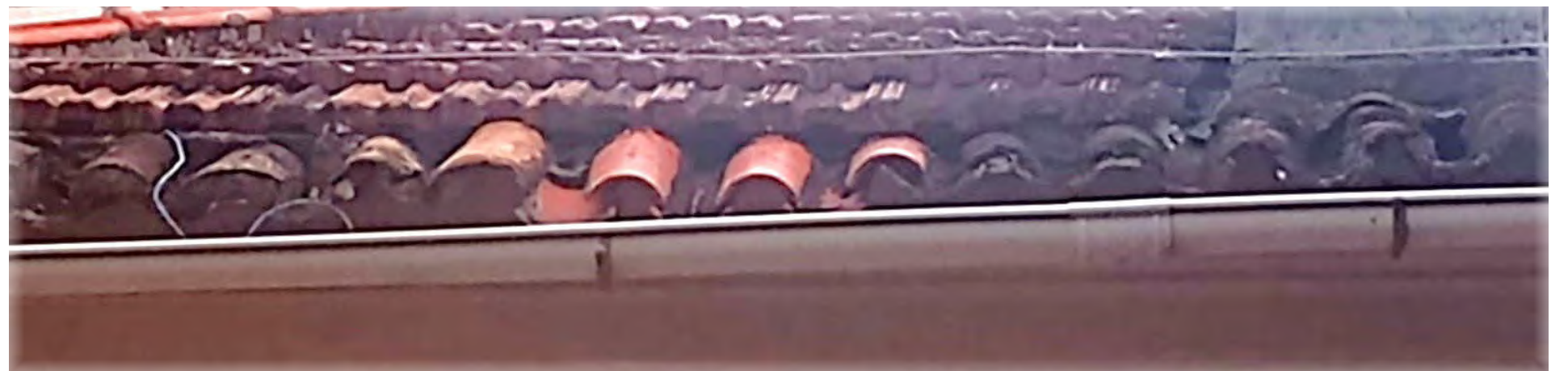
Foto 86: Telhas do beiral do telhado estão cedendo, prestes a se desprenderem. Elas se apoiam na calha aberta em PVC logo abaixo. Algumas telhas estão fragilizadas nas bordas, além da quantidade grande de pátina orgânica em sua superfície.
