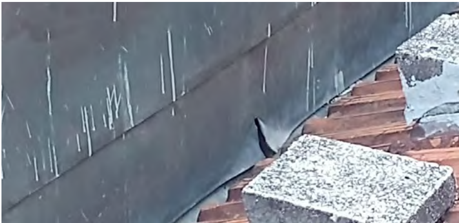
Foto 21: Rasgo na saia de cobre provocando infiltração para a estrutura do telhado e para a parede oeste da fachada.
