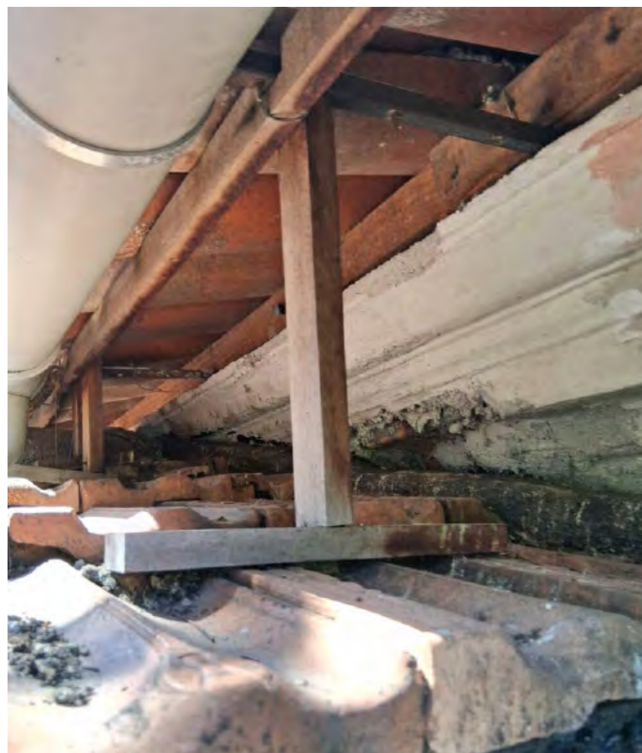
Foto 98: Trecho abaixo da cobertura com os danos apontados anteriormente e com sustentação em madeira inadequada por conta da remoção da antiga parede que sobrecarregava o peso na cobertura. A infestação de aves ocorre neste ponto também. Ver detalhe 02 na prancha 04.
