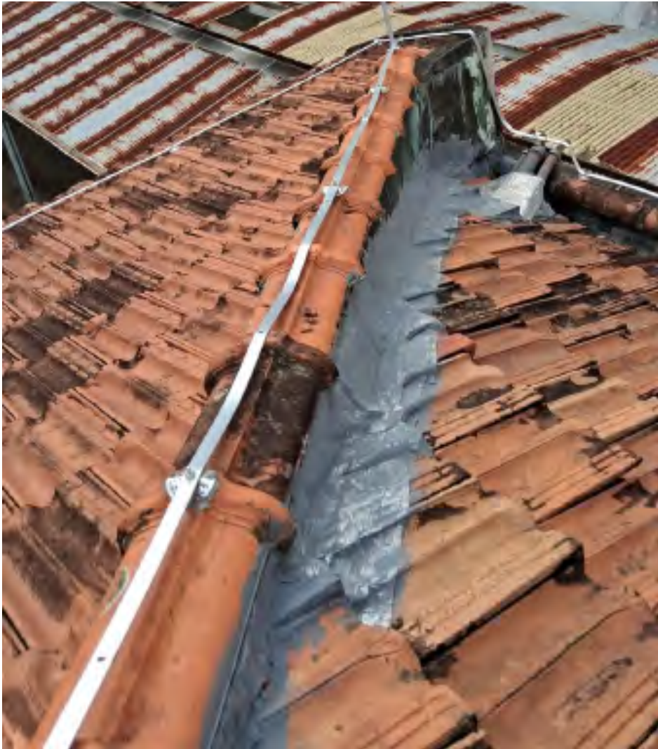
Foto 81: Excesso de manta impermeabilizante no trecho de cumeeira.
