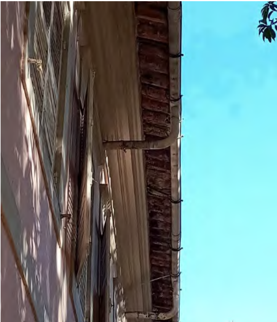
Foto 84: Apesar de algumas telhas do beiral estarem mais prejudicadas do que outras, o conjunto de telhas do beiral apresenta danos e riscos aos frequentadores.
