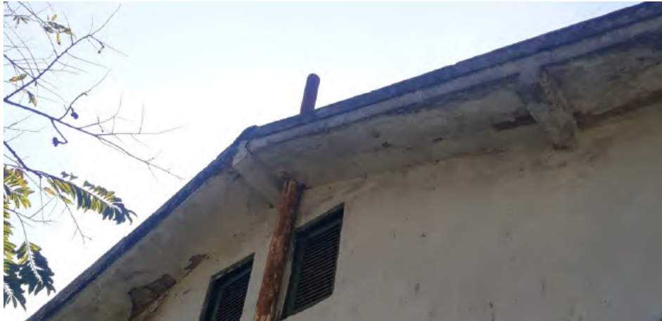
Foto 137: Danos similares ao da foto anterior, com a chaminé com corrosão avançada.
