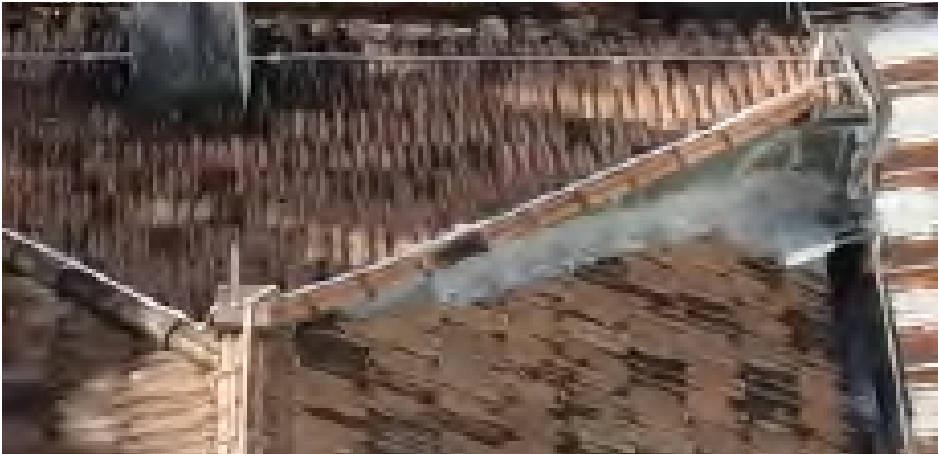
Foto 79: Excesso de manta impermeabilizante no trecho de cumeeira.
