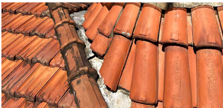
Foto 15: Aplicação excessiva de argamassa de vedação em trecho ao redor da clarabóia, para prevenir a entrada de águas pluviais e outros resíduos.
