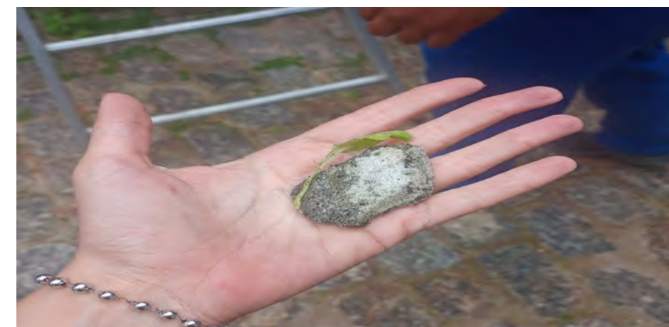
Foto 111: Fragmento de argamassa que se desprende e demonstra a fragilidade das telhas.
