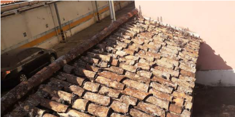
Foto 124: Vista de parte da cobertura do canil, apresentando telhas originais mas em estado avançado de deterioração, como quebras e pátina orgânica. Foto tirada antes da remoção da vegetação.
