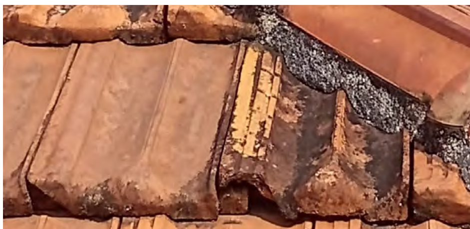
Foto 26: Telhas com fraturas, pedaços faltantes, sobretudo nas pontas, e com vãos entre elas, resultando em ponto de infiltração na sala Código Civil.
