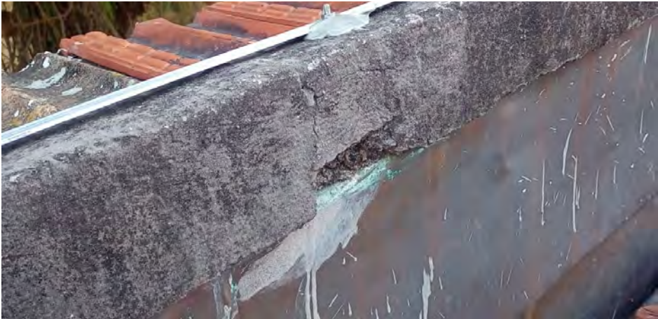
Foto 20: Fratura em trecho interno da argamassa que protege a face superior da platibanda (chapim).
