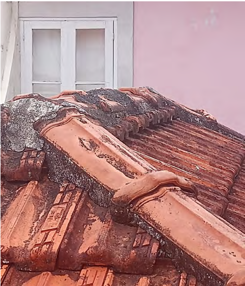
Foto 105: Excesso de argamassa em alguns trechos da cumeeira e falta em outros, como abaixo das telhas que fazem o acabamento lateral da cumeeira. Esses trechos ocos favorecem a quebra das telhas.
