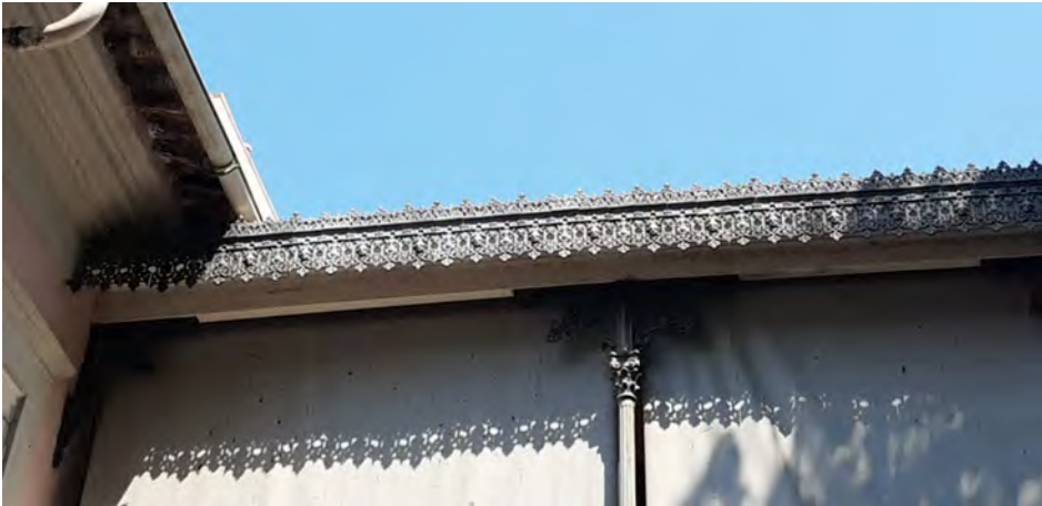
Foto 89: Aproximação do canto esquerdo, local sem proteção adequada, servindo como ponto de infestação de aves.
