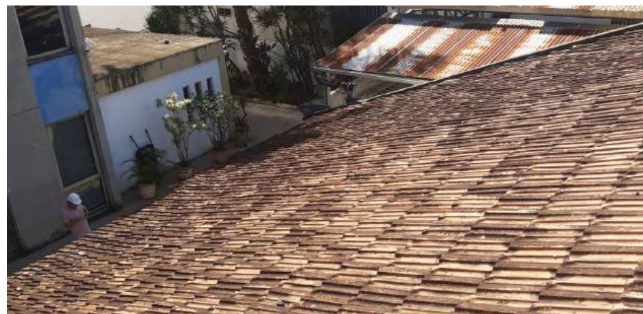
Foto 145: Trecho aos fundos da cobertura, com telhas francesas apresentando sujeira e parte com elevação acima do nível do restante, provavelmente por conta de afundamento do madeiramento estrutural.
