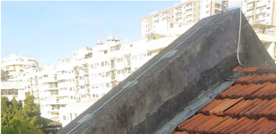
Foto 01: Frontão com sistema SPDA recém instalado, apresentando rufos metálicos em seu encontro com a cobertura em telha francesa, fixados com argamassa deteriorada por ressecamento. Cumeeira apresentando excesso de argamassa para fixação.
