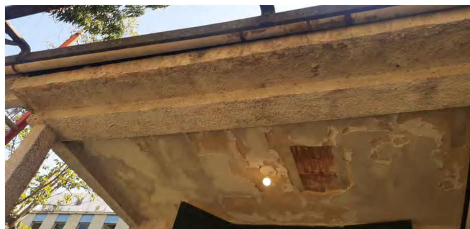
Foto 151: Laje abaixo da cobertura, com machas de umidade e perda da camada de revestimento.
