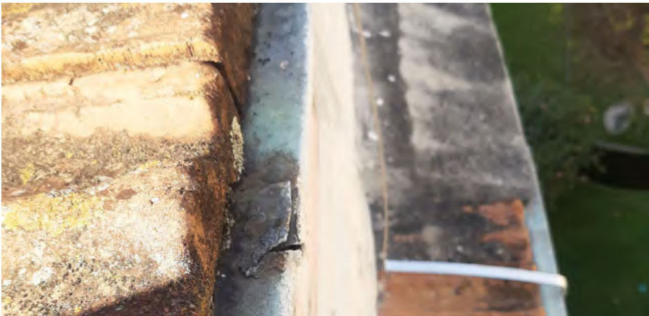
Foto 06: Chapa metálica fixada abaixo das telhas francesas das extremidades da platibanda apresentando deformação na direção do caimento e trechos, como o desta foto, com rasgos. Ver det. 01.
