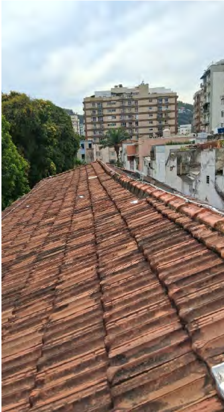
Foto 87: Cumeeira do telhado com trecho de afundamento - vista frontal.
