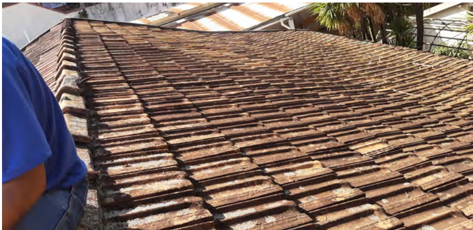
Foto 142: Vista geral da cobertura em direção a garagem, apresentando os danos mencionados nas fotos anteriores, atentando para grande trecho de telhas mais recentes aos fundos e detritos de árvores nas beiras.
