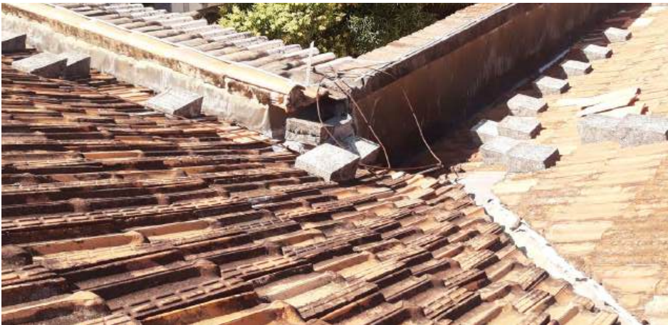
Foto 66: Vista geral do encontro das coberturas, com tyvek e estrutura no rincão expostos, passadiços soltos e saias de cobre com corrosão.
