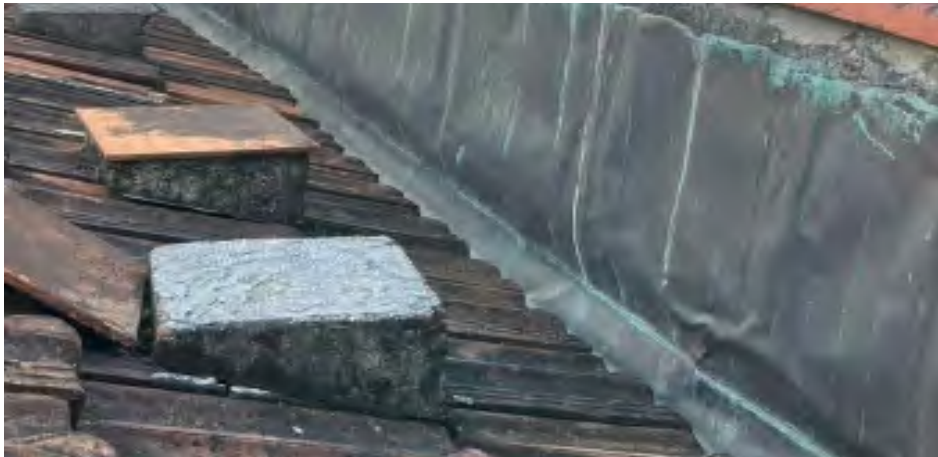
Foto 118: Trecho da saia de cobre deformado devido as intempéries ao longo dos anos. Esse estufamento da saia permite a entrada e acúmulo de água entre a chapa e a platibanda, gerando infiltrações. Além disso, passadiços sem acabamento superior em cerâmica.
