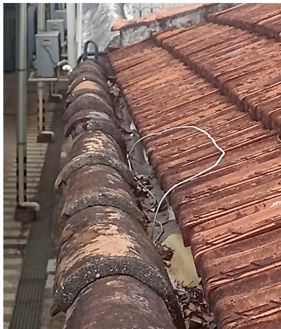
Foto 107: Acúmulo de detritos ao longo da calha que divide a parede do banheiro com o muro para o estacionamento. As telhas que funcionam como pingadeira estão em mal estado, apresentando pontos de desgaste, tanto nas telhas como na argamassa de assentamento.
