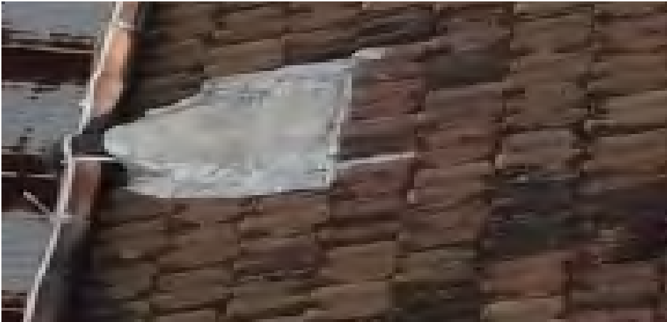
Foto 80: Vedação irregular para o acesso ao interior do telhado pelo corredor de serviço. Este corredor sofre ao longo de toda a sua extensão com problemas de estufamento das paredes e mofo, oriundos da infiltração na parede.
