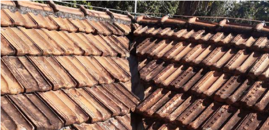
Foto 34: Rincão com telhas danificadas, sem a presença de calha específica para este trecho e com a impermeabilização exposta.
