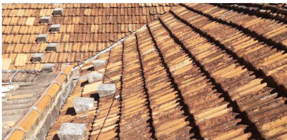
Foto 74: Vista geral da extremidade da platibanda abordada e do rincão com manta tyvek exposta.
