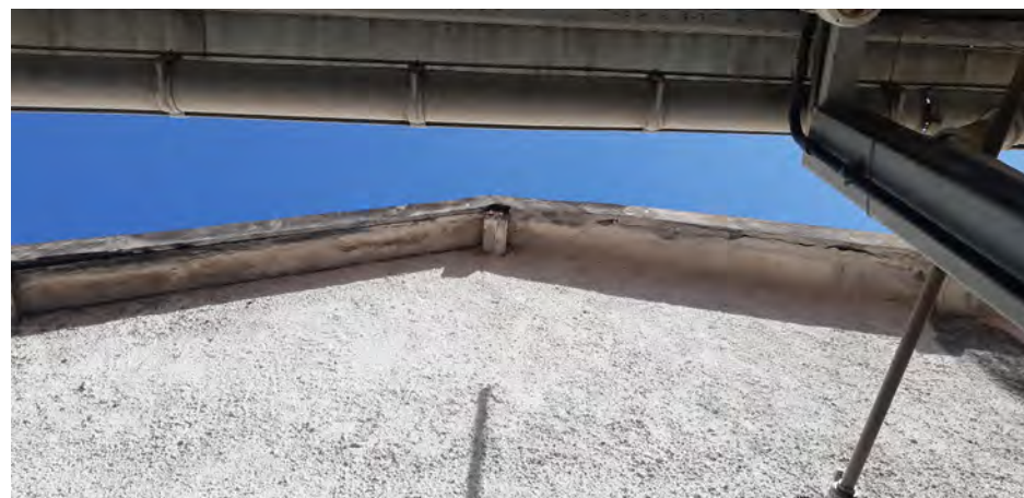
Foto 148: Continuidade do trecho da foto anterior, com madeiramento da cumeeira e beiral esquerdo com desgaste mais severo em relação ao observado na foto 147.
