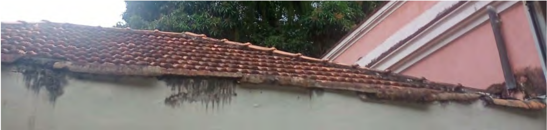
Foto 100: Muro entre o banheiro e o estacionamento apresenta pontos de infiltração, com pátina orgânica e desgaste das telhas que funcionam como pingadeiras.
