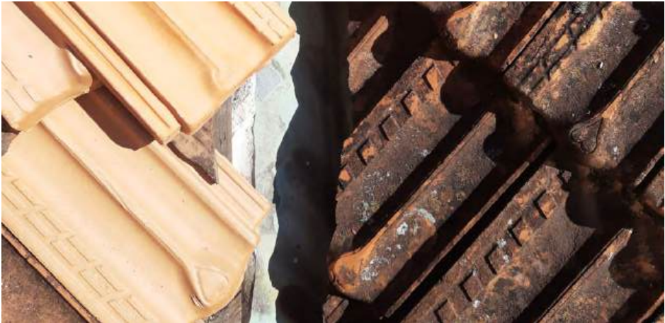
Foto 35: Aproximação de trecho apontado na foto anterior, evidenciando a impermeabilização e trecho de madeiramento expostos.
