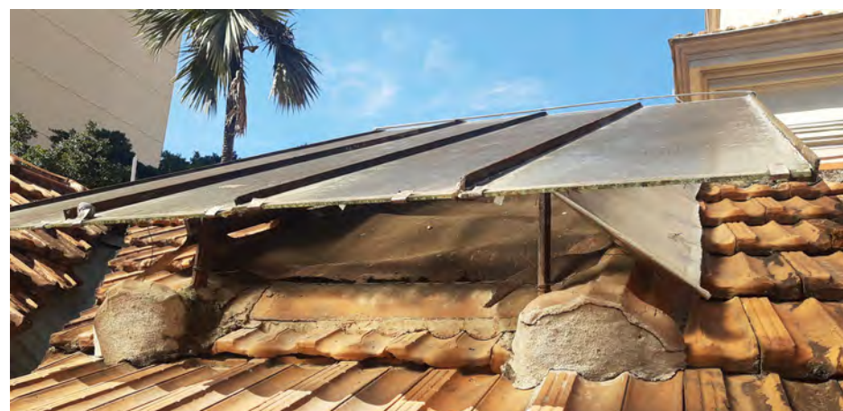
Foto 45: Telhas no entorno da clarabóia com excesso de argamassa. Uso de chapas metálicas para evitar entrada de água pluvial e tela para impossibilitar entrada de aves, outros possíveis animais, insetos e detritos. Estrutura metálica em processo de corrosão.
