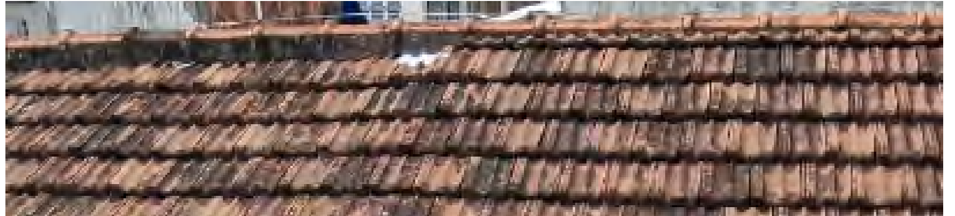
Foto 85: Cumeeira do telhado com trecho de afundamento - vista lateral.
