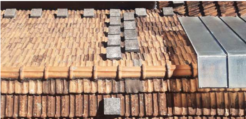
Foto 38: Trecho de caminho dos passadiços entre cumeeira, a qual apresenta trecho com manta impermeabilizante.
