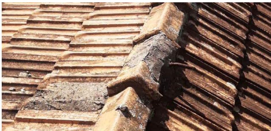
Foto 143: Trecho de cumeeira com resto de estrutura metálica corroída e aplicação de argamassa na telha da cumeeira e telha francesa adjacente.
