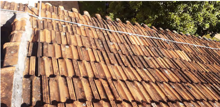
Foto 68: Danos gerais nas telhas francesas e excesso de argamassa nas telhas laterais (encontro com o TE04).
