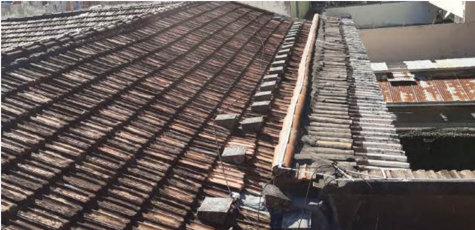
Foto 65: Vista geral apresentando passadiços soltos, telhas de beirais com aplicação de manta impermeabilizante e telhas francesas com desgaste em geral.
