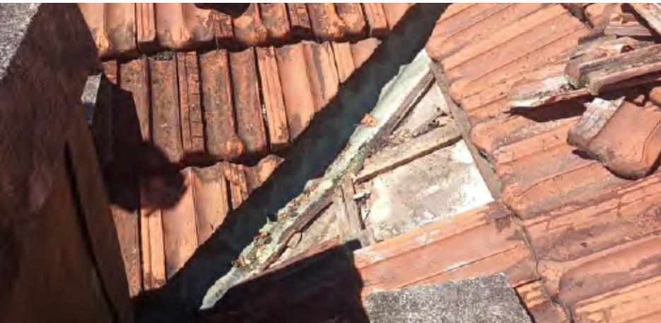
Foto 36: Situação abaixo das telhas, onde a estrutura em madeira apresenta deterioração avançada, assim como a subcobertura (tyvek) .
