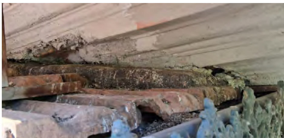
Foto 97: Lateral da cobertura, apontado na foto 95, entre as telhas e friso, com telhas deterioradas e frisos recompostos de modo inadequado.
