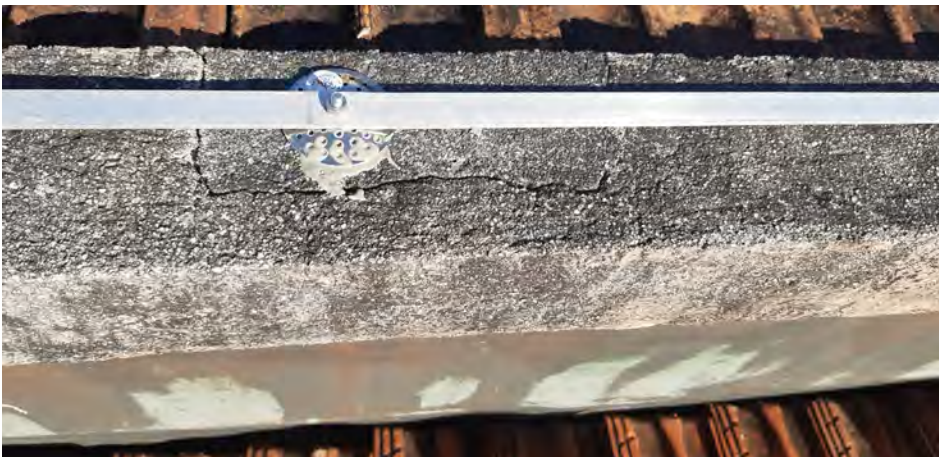
Foto 08: Fissuras em diversos trechos dos topos das platibandas que são revestidas com argamassa de cimento.
