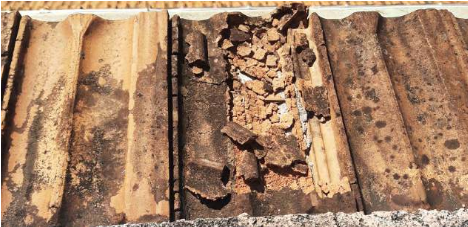
Foto 03: Telha quebrada em trecho de platibanda.
