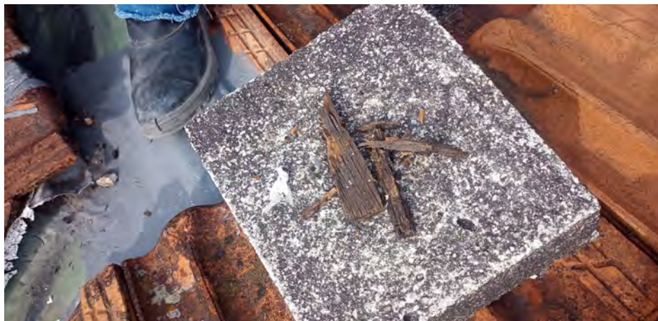
Foto 49: Restos de madeira da estrutura interna do telhado apodrecida logo abaixo da subcobertura (tyvek).
