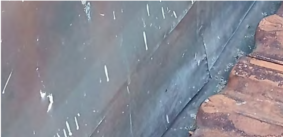
Foto 18: Ondulações e rasgos na saia que faz parte do conjunto com a calha de cobre. Pode causar infiltrações na platibanda e alcançar as paredes da sala sala Buenos Aires.
