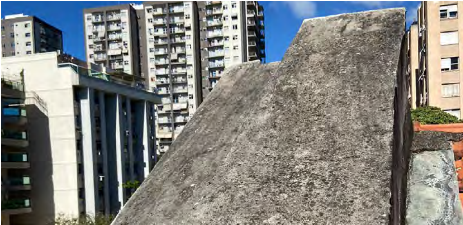
Foto 02: Superfície superior do frontão, anterior a colocação do sistema SPDA, apresentando porosidade no revestimento. Este fator possibilita a absorção de água, acarretando infiltração em ambientes internos do sobrado.
