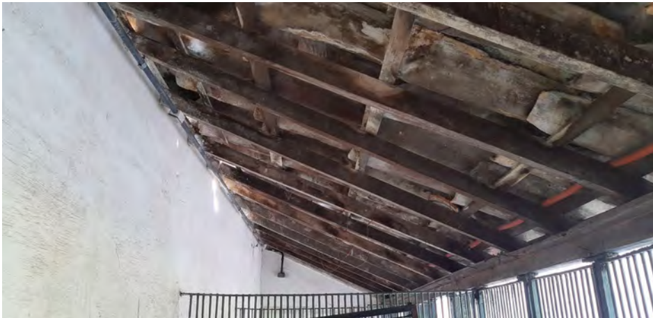
Foto 126: Estado avançado de degradação da estrutura, com trechos com mofo branco e umidade. Parte inferior das telhas também com degradação avançada.
