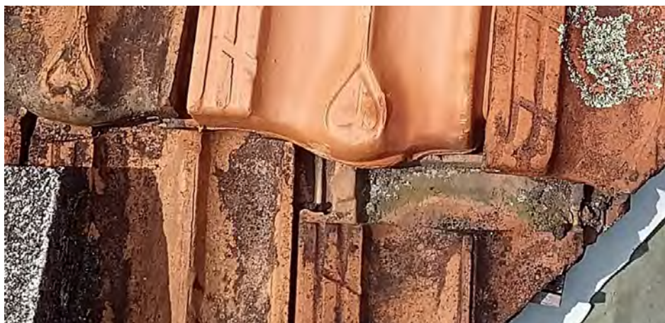
Foto 52: Telha com pedaços faltantes.
