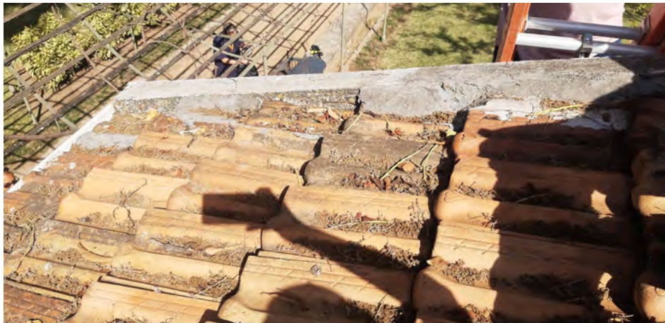
Foto 141: Aproximação de trecho apresentado na foto 139, observando a aplicação de argamassa irregular. Diferenciação de telhas novas e antigas com desencaixe entre peças por desconcontro sutil nas dimensões das telhas e acúmulo de detritos proveniente das árvores.
