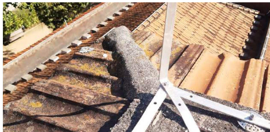
Foto 11: Aplicação de argamassa excessiva, atualmente apresentando ressecamento, no encontro das telhas das platibandas. Pode-se observar também a presença de pátina orgânica, vão entre os encaixes da telha (o que gera infiltração) e sujeidades.
