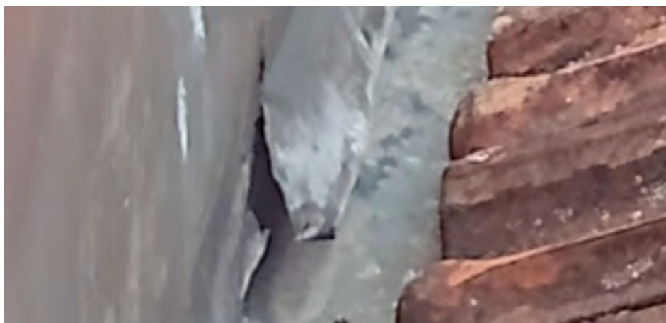
Foto 58: Rasgo na saia de cobre no trecho acima da sala Habeas Corpus que pode causar infiltrações no seu interior.
