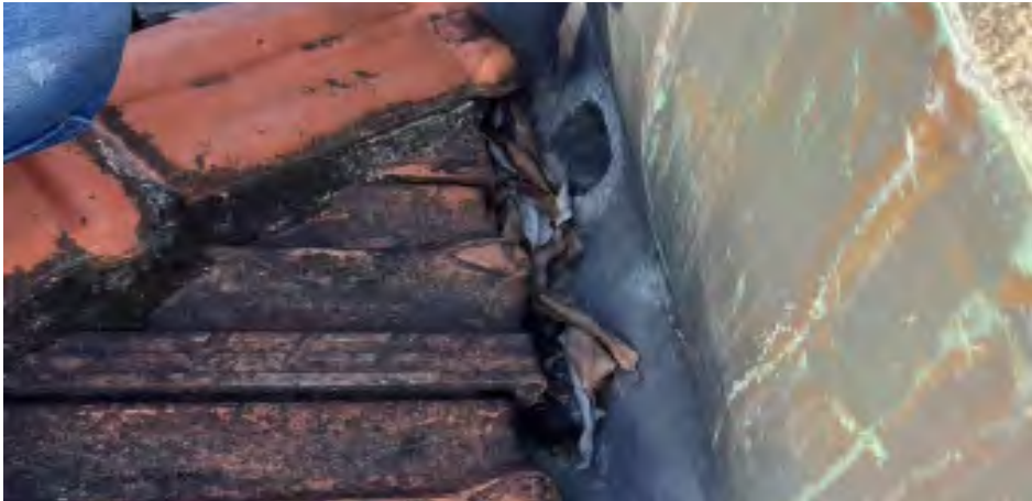
Foto 113: Acúmulo de detritos na calha causado por empoçamento. O tubo de águas pluviais está posicionado de forma lateral, prejudicando o caimento da calha.
