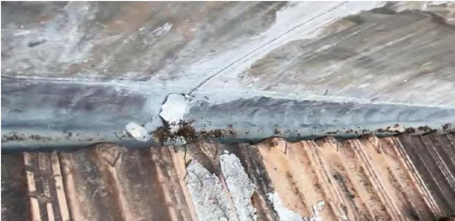
Foto 114: Outro trecho de calha com acúmulo de detritos. Rachadura na platibanda da fachada principal da Cavalaria. Telhas apresentam rachaduras e restos de argamassa.
