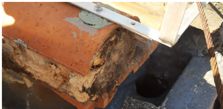
Foto 72: Aproximação da telha na beira da platibanda, fixada com argamassa em argila em estado de ressecamento, com desprendimento da telha.
