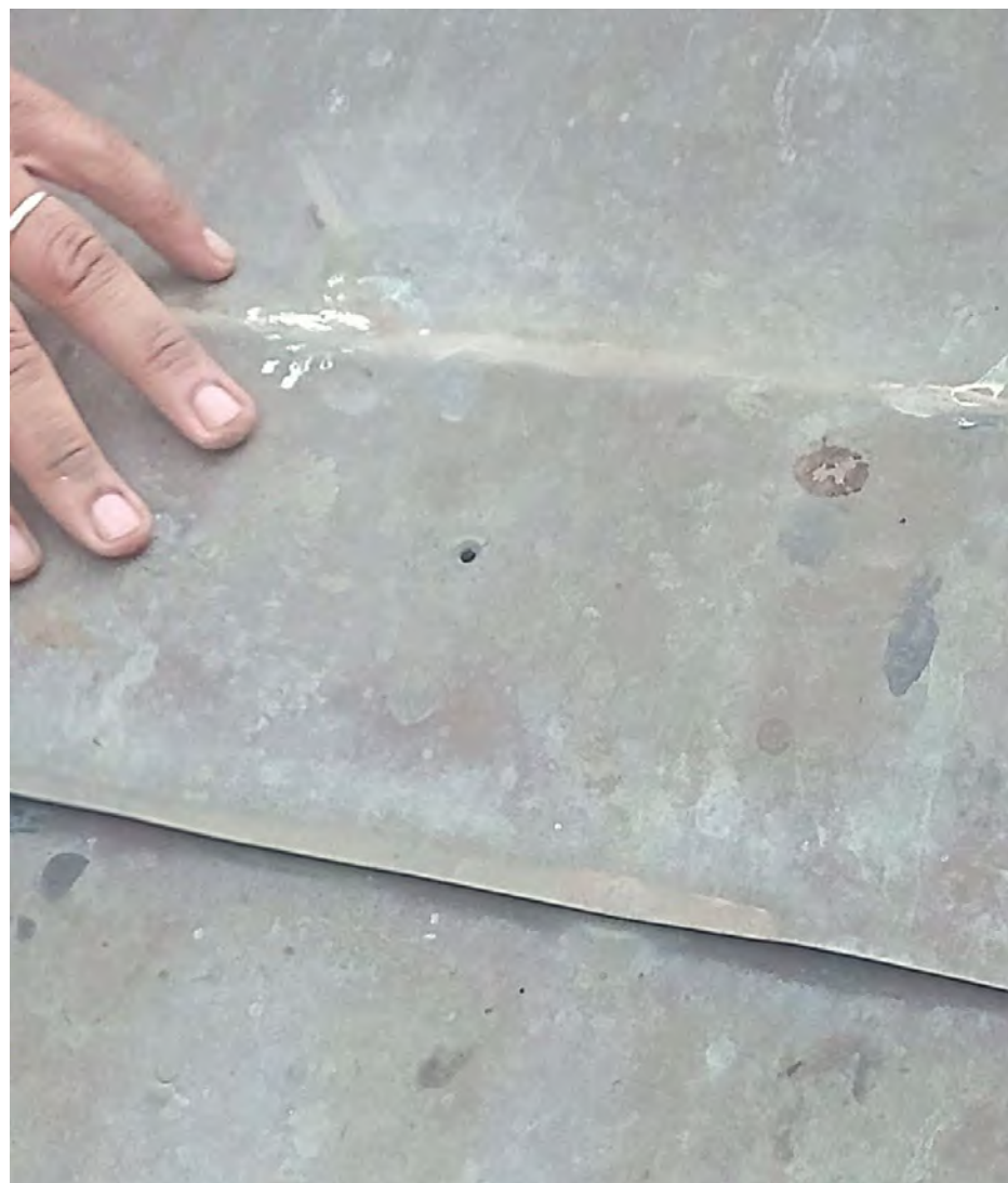
Foto 156: Os pregos que fazem a fixação das chapas de cobre estão se desprendendo por má fixação ao madeiramento interno da cobertura. O madeiramento está apodrecido em alguns pontos e devido as repetidas tentativas de recolocação dos pregos, a madeira já está desgastada.
