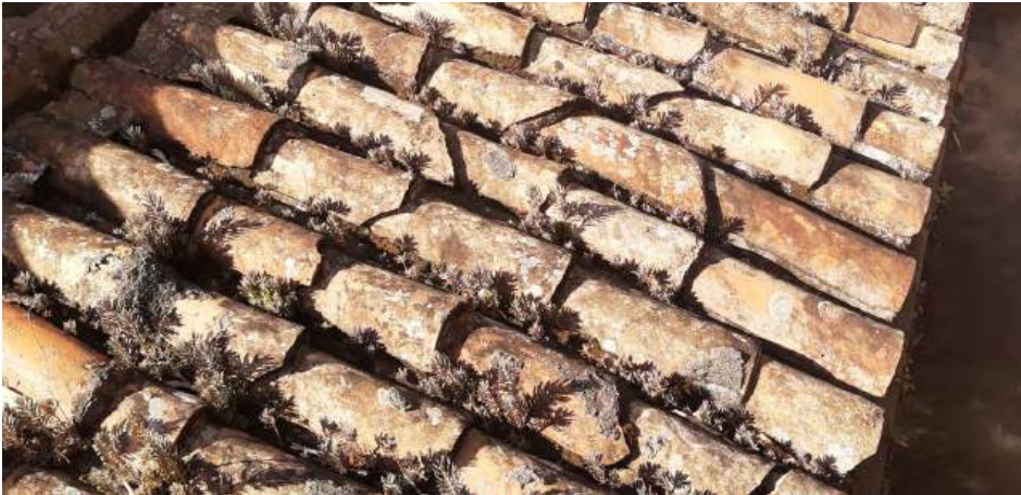
Foto 125: Foto aproximada da cobertura, observando com mais detalhes os danos apontados.
