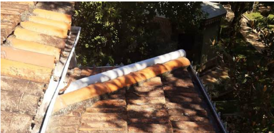
Foto 95: Extremidade da cobertura da varanda, com os danos apontados anteriormente, cumeeira com excesso de argamassa e cano de pvc para escoamento das águas pluviais, apontado na foto 94.
