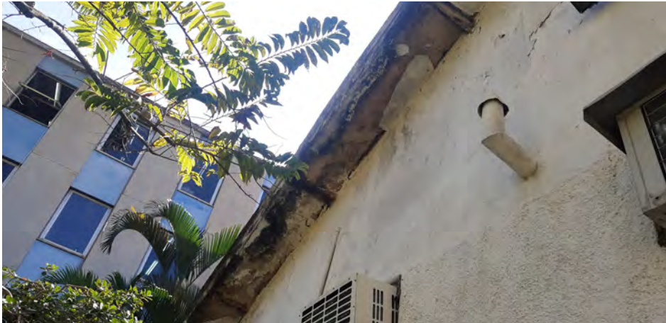
Foto 136: Parte posterior do telhado, com estrutura em madeira com desgastes avançados e com pedaços faltantes, e argamassa de revestimento do beiral deteriorado e expondo o madeiramento em alguns trechos.
