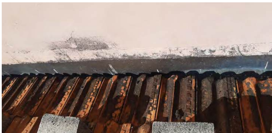
Foto 41: Rufos fixados na parede do sobrado apresentando uma marcação horizontal que demonstra ressecamento da camada de pintura. Observa-se também as telhas em estado de sujeidade avançado e corrosão leve do rufo.
