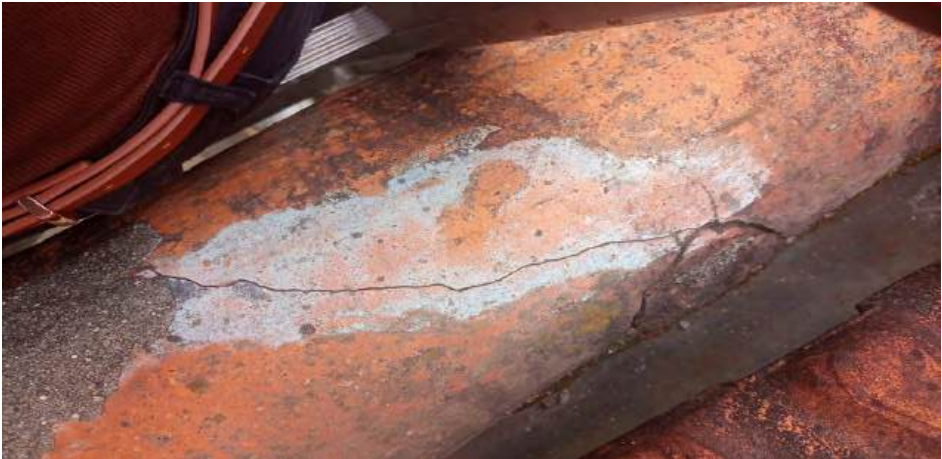
Foto 103: Telha trincada. Pode evoluir para rachadura e causar infiltrações dentro do banheiro.
