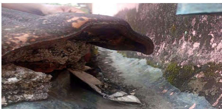
Foto 109: Acúmulos de detritos secos ao longo da calha e restos da subcobertura (tyvek) sob a calha, exposto as intempéries.
