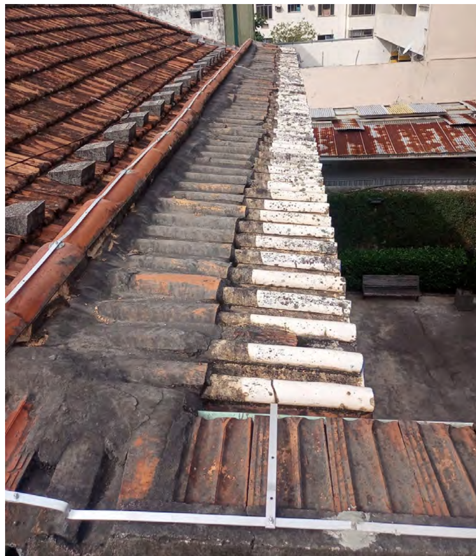
Foto 60: Excesso de manta impermeabilizante nas telhas decorativas que compõem o beiral da Sala Bahia e da Sala Questão Religiosa. Sujidades em geral e algumas telhas estão com partes faltantes.
