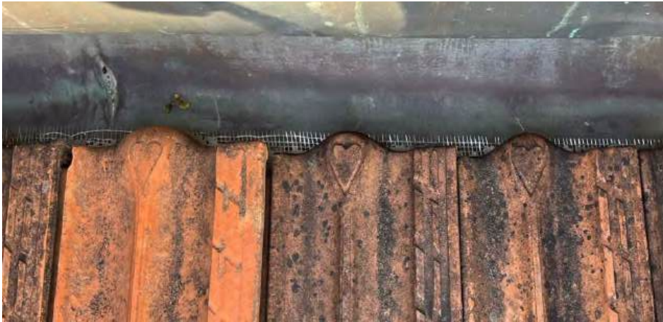
Foto 112: Rebarba da subcobertura (tyvek) sobrando para além das telhas. A falta desse arremate envolvendo o madeiramento pode danificar o conjunto do telhado.
