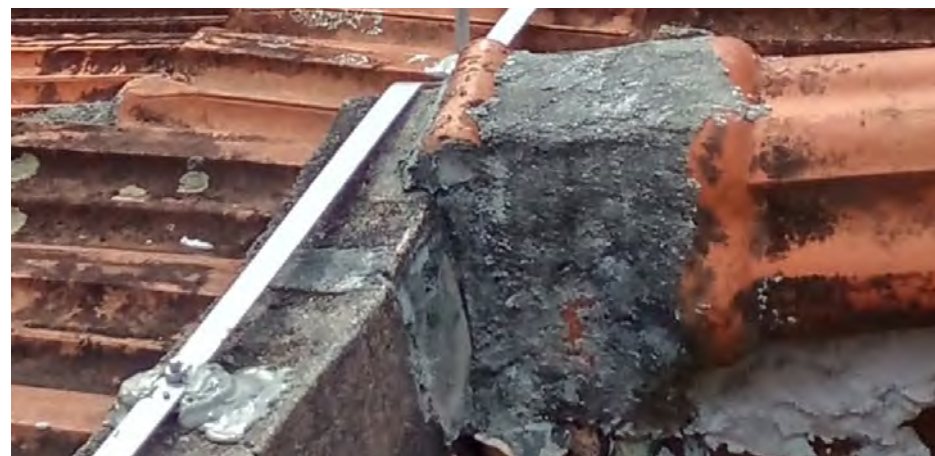
Foto 53: Excesso de argamassa nas telhas de cumeeira que dividem o TE04 do TE05.
