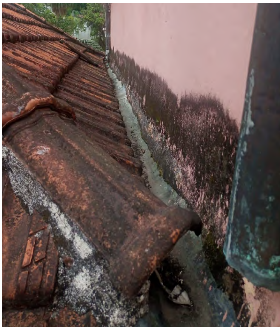
Foto 106: Mancha negra causada por infiltração na parede que faz divisa entre o banheiro e a cavalaria. O tubo de águas pluviais da cavalaria que desagua na calha do banheiro apresenta oxidação.
