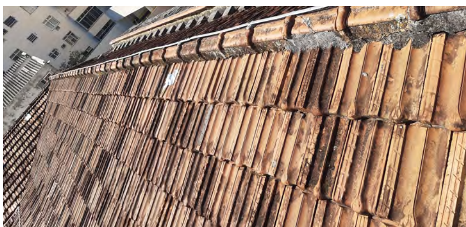
Foto 77: Vista geral da cobertura, em direção ao telhado TE 06, apresentando excesso de argamassa nas telhas da cumeeira e telhas francesas com sujidade e desgastes em geral.
