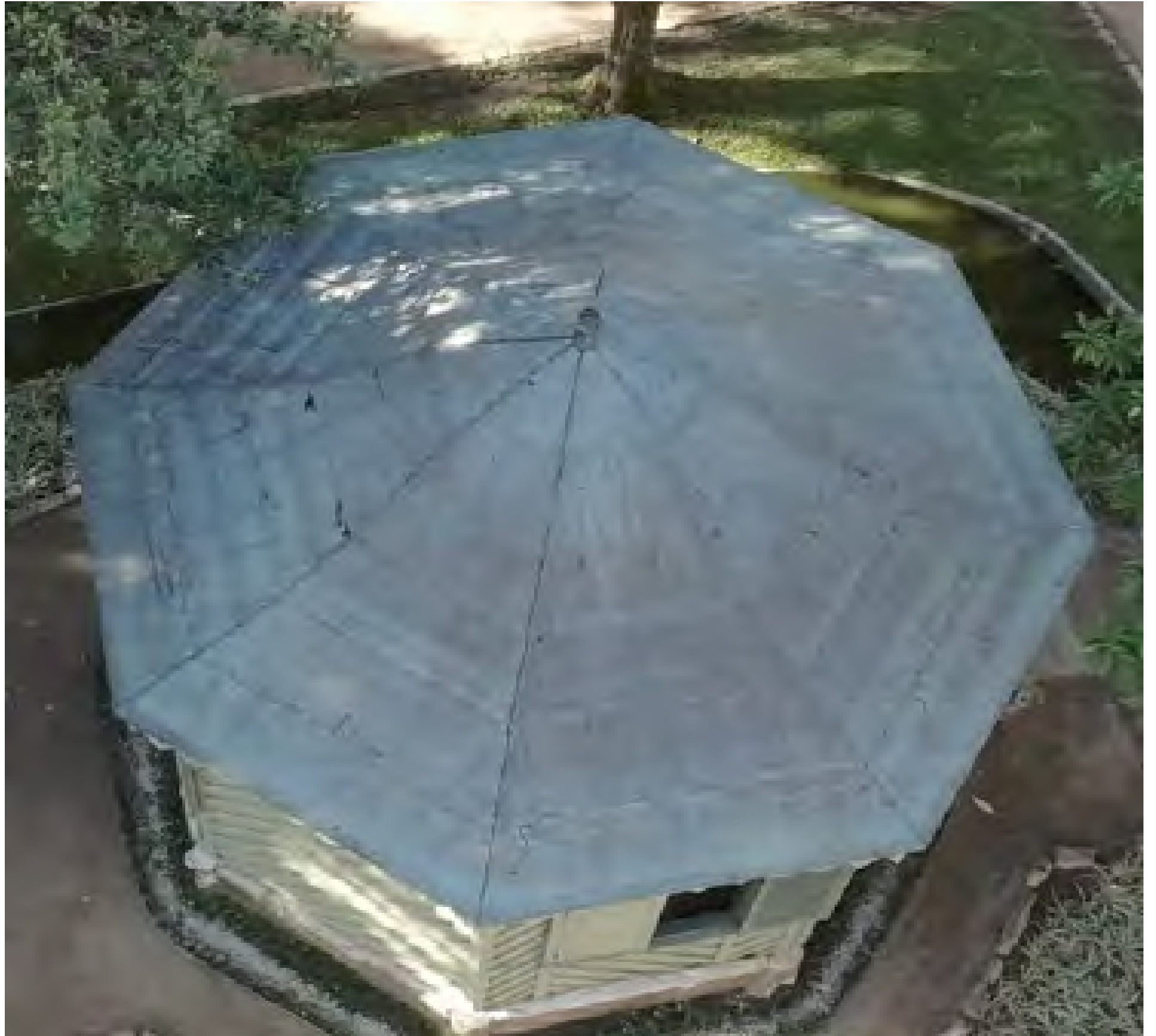
Foto 154: As chapas de cobre da cobertura estão com a pintura desgastada pelo tempo. Pode ser observado também que existem vãos entre chapas, o que favorece a entrada de água no interior do quiosque e a formação de goteiras.
