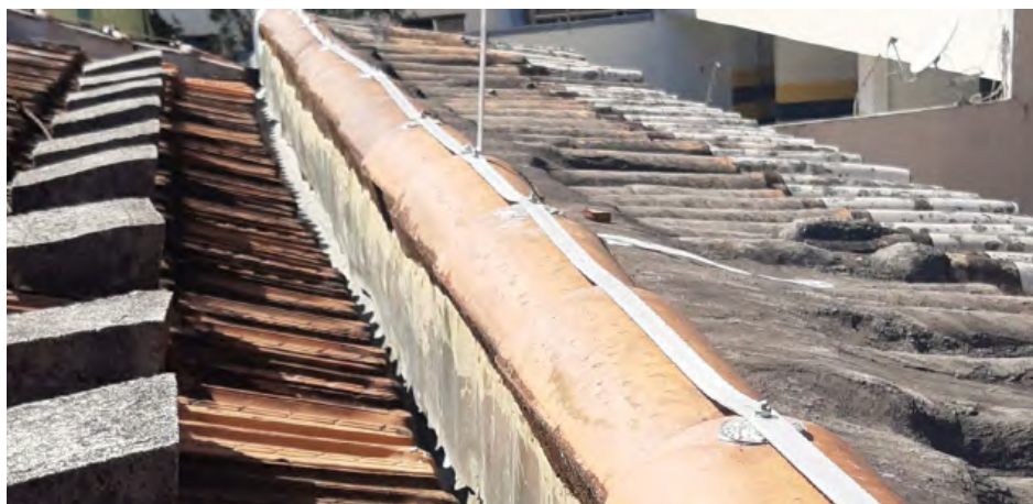
Foto 71: Platibanda com saia de cobre e telhas desgastadas. Apresenta duas fileiras de telhas de beirais, a primeira com manta impermeabilizante excessiva e a segunda (telhas decoradas) com desgastes.
