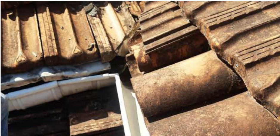
Foto 93: Encontro entre telhados TE 05 e 06, logo acima do telhado TE 07. Além dos danos observados anteriormente, as telhas de pvc atuais não comportam a quantidade de águas pluviais escoadas pelas coberturas superiores, demonstrando o subdimensionamento das calhas.
