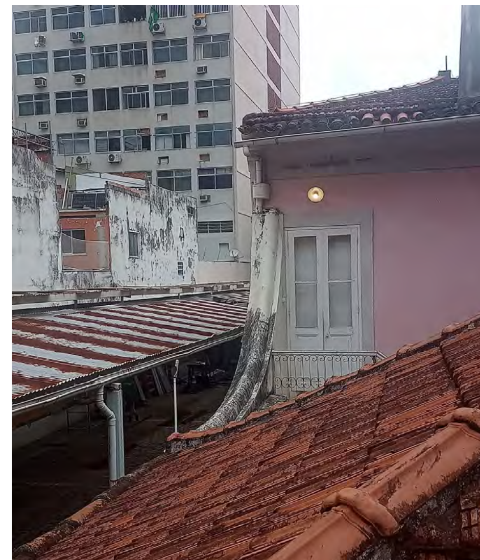
Foto 108: Mancha negra na parede em curva que faz a união do muro com a parede do corredor de serviço da Casa.
