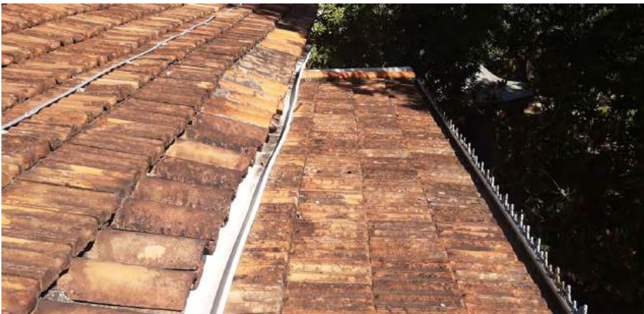
Foto 94: Vista geral da cobertura em direção ao lado direito. Telhas de beirais da cobertura TE 05 em estado de degradação considerável, calha de pvc tortuosa e telhas francesas com sujidades. O trecho abaixo dos beirais também apresenta infestação de aves.
