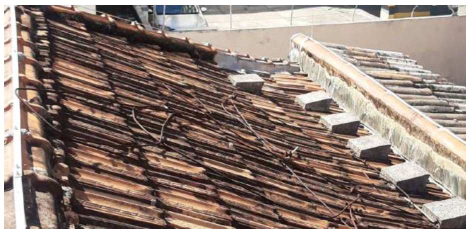
Foto 75: Vista geral da extremidade oposta da platibanda abordada, com cumeeira apresentando excesso de argamassa para fixação de telhas, saia de cobre deteriorada e argamassa de fixação deteriorada na platibanda.
