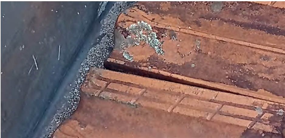
Foto 22: Vão entre as telhas sendo um possível ponto de infiltração na sala Constituição.
