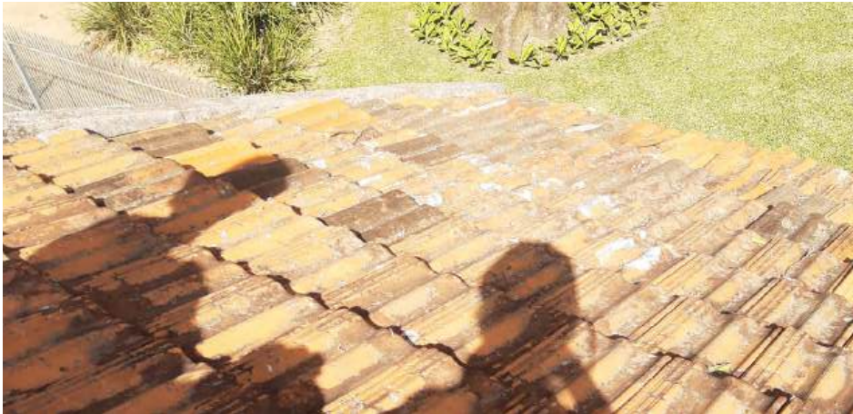
Foto 129: Lateral da cobertura em direção ao jardim, com telhas francesas com desgastes, pátina organica considerável e peças desencaixadas após troca por quebra, resultante da queda de fruto de árvore próxima, o que permite entrada de água.
