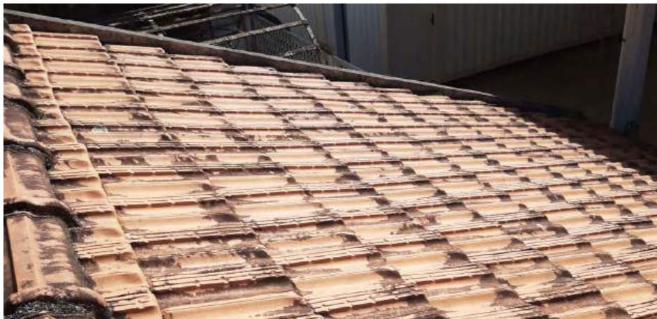
Foto 133: Cobertura em direção a garagem, com telhas apresentando sujidades e leve pátina orgânica.
