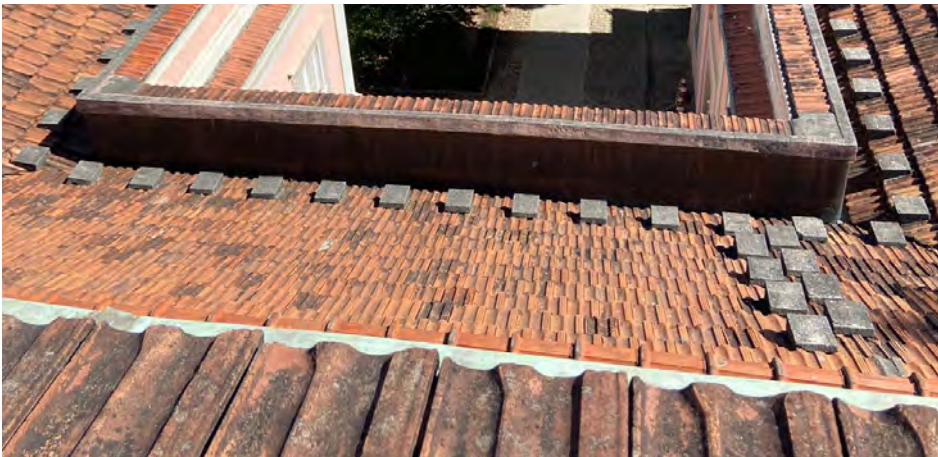
Foto 37: Trecho posterior do telhado, apresentando telhas com sujidades, platibanda com saia de cobre deteriorada, excesso de argamassa no encontro das telhas das platibandas e passadiços soltos.
