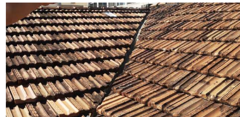
Foto 76: Rincão entre as coberturas TE 05 e 06, com subcobertura tyvek e madeiramento exposto. Telhas com sujidades e desgastes em geral.
