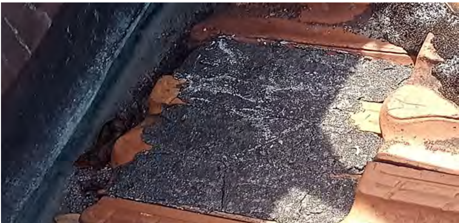
Foto 25: Telhas faltantes preenchidas com argamassa em mau estado de conservação por estar exposta a intempéries e pode causar infiltração na sala Código Civil.
