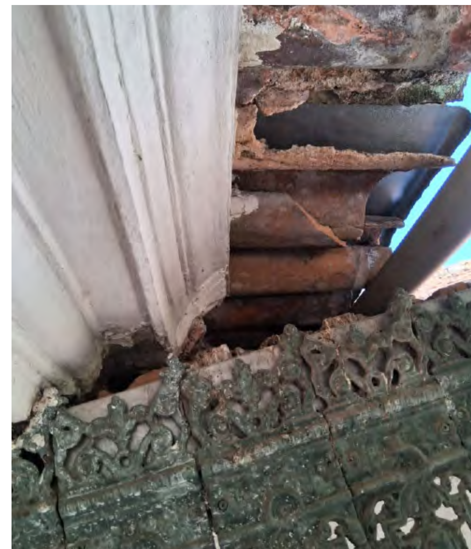
Foto 99: Trecho lateral esquerdo, apontado nas fotos 89, 91 e 92, entre as telhas e friso, apresentando lambrequins corroídos e com risco de queda, resultando em risco para os frequentadores. Telhas de beirais com desgaste avançado e quebradas, também sendo ponto de infestação de aves.
