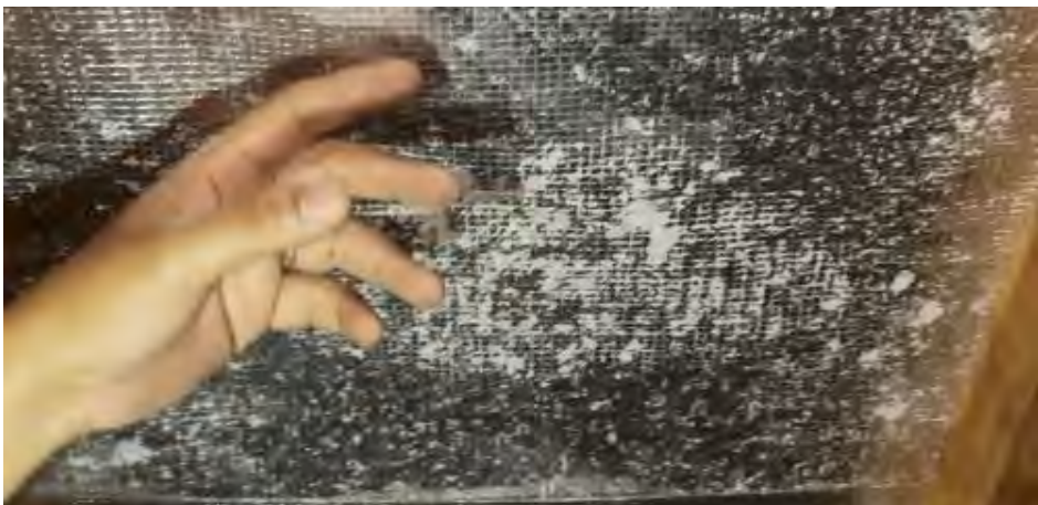
Foto 119: Subcobertura (tyvek) apresenta pontos de mofo no interior do telhado.
