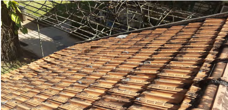
Foto 131: Continuidade do trecho de cobertura direcionado para o jardim, apresentando os danos mencionados nas fotos anteriores acerca das telhas, atentando para uma peça destacada por aplicação de manta impermeabilizante.
