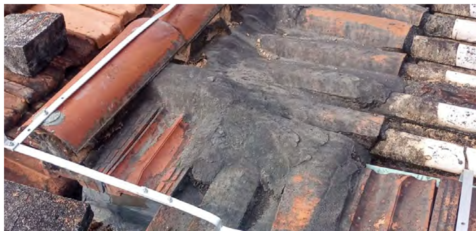
Foto 57: Aplicação excessiva de manta impermeabilizante nas telhas do beiral de telhas decoradas na fachada sul.
