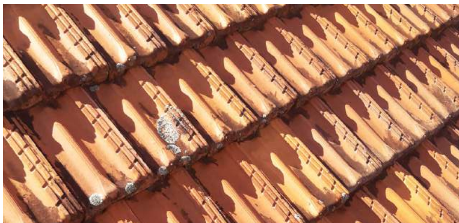
Foto 09: Telhas francesas apresentam em geral sujeidade e presença de pátina orgânica, tanto de manchas brancas de fungos como pequenos musgos.
