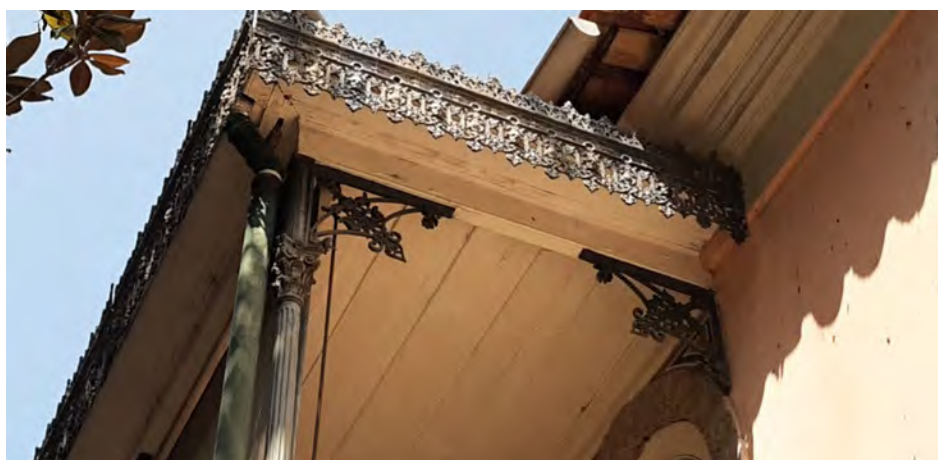
Foto 96: Lateral da cobertura, também vista à partir do nível térreo, atendo para a descida de AP com vão excessivo no forro em madeira, além da presença de aves no trecho de curvatura.
