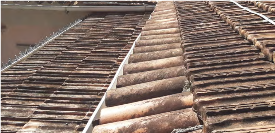
Foto 90: Vista em direção ao encontro entre coberturas TE 05, 06 e 07, com beirais do TE05 degradados e com desencaixe e telhas da cobertura da varanda com sujidades, porém íntegras.
