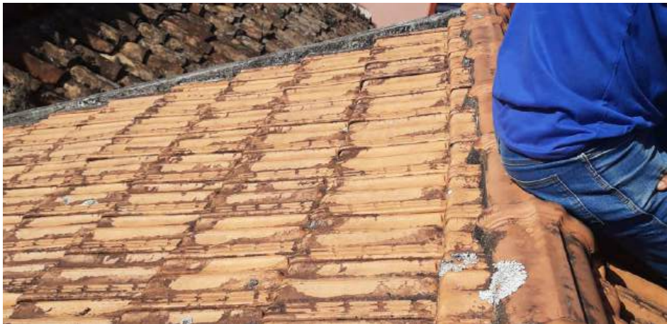
Foto 134: Cobertura em direção a garagem e adjacente ao antigo canil, com danos apontados na foto anterior e cumeeira com presença de pátina orgânica.
