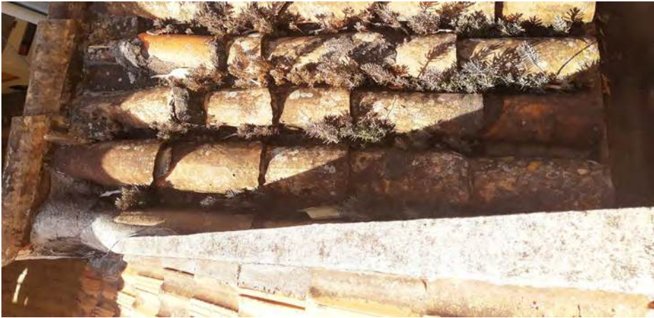
Foto 127: Lateral adjacente ao TE12, apresentando os danos apontados na foto 124.
