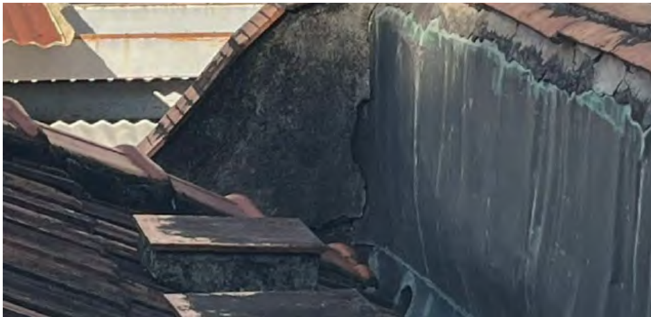
Foto 117: Peça faltante de argamassa de acabamento no trecho do encontro entre as faces da platibanda. Além disso, o encontro do arremate da argamassa da platibanda com a saia de cobre apresenta marcas de infiltração.
