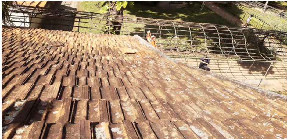
Foto 139: Vista à partir da cumeeira, com telhas apresentando danos similares ao da foto anterior, porém com telhas substituídas na beira após quebra por frutos de árvores.
