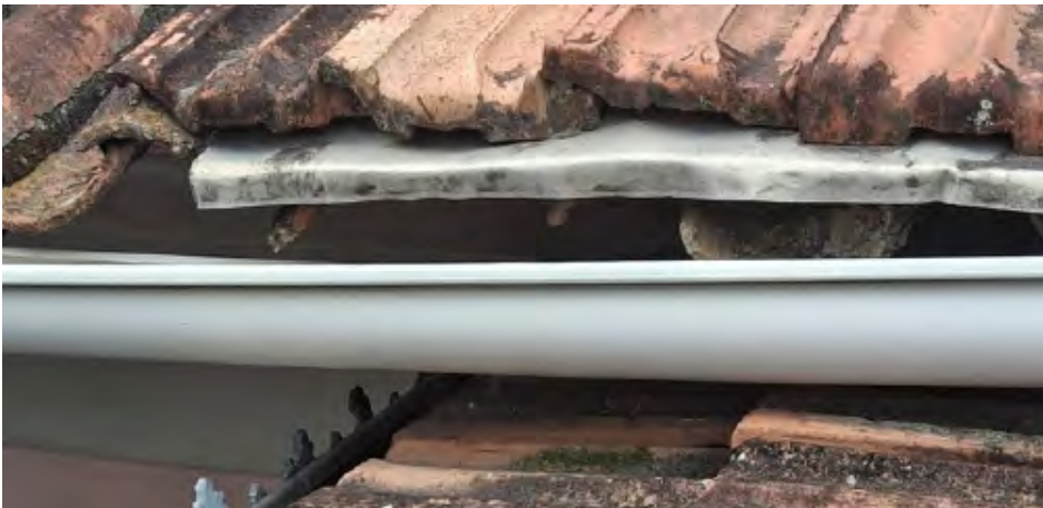
Foto 92: Aproximação do trecho da foto anterior, apresentando as chapas metálicas deterioradas e telhas de beirais, abaixo das telhas francesas, quebradas.
