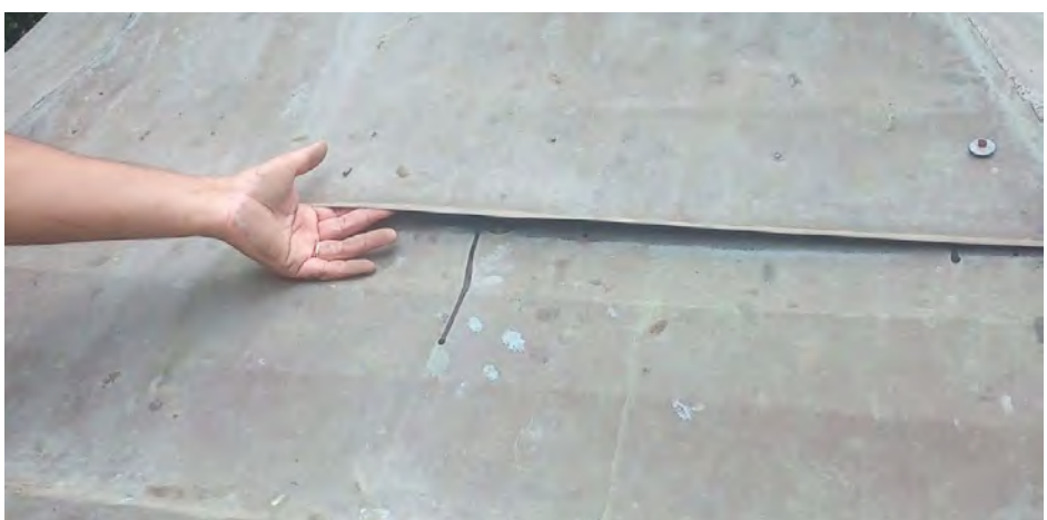
Foto 157: Falta de fixação entre as telhas de cobre da cobertura do quiosque.
