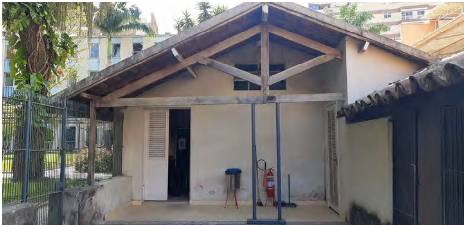
Foto 135: Tesoura da cobertura com escoramento emergencial. Ver detalhe xy.
