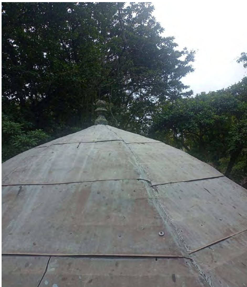
Foto 155: Chapas de cobre do telhado do quiosque estão mal fixadas em alguns trechos. Esses vãos entre chapas permite a entrada de água e o apodrecimento do madeiramento interno da cobertura.
