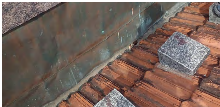
Foto 30: Saia de cobre com ferrugem no encontro das chapas e ondulação causada pelo excesso de calor que deforma o material.
