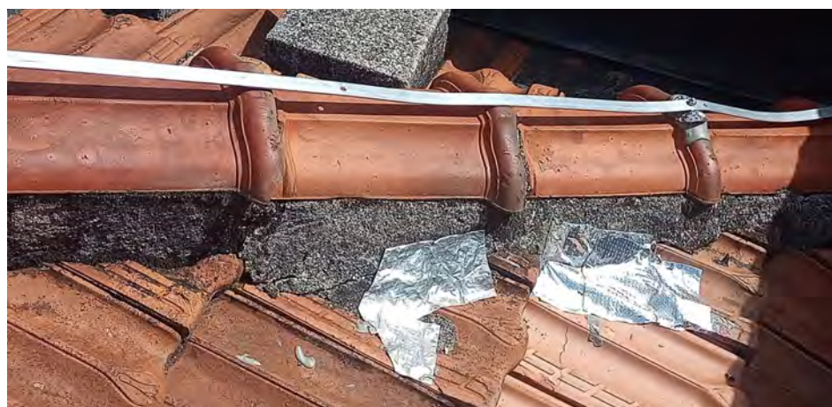
Foto 27: Pedacos de manta de alumínio fazendo remendos na argamassa de assentamento das telhas da cumeeira.
