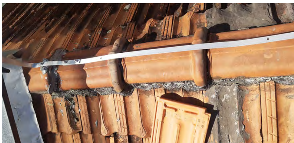
Foto 44: Argamassa de fixação excessiva nas cumeeiras e aplicação de manta impermeabilizante em telhas, próximo a clarabóia.
