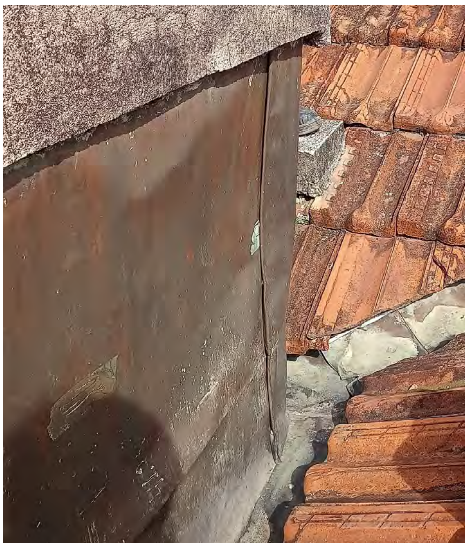
Foto 31: Encontro das chapas de cobre que compoem a saia com frestas e sem vedação total provocam infiltração na sala Código Civil. Já foram feitas tentativas anteriores de remendo com fita de manta de alumínio.
