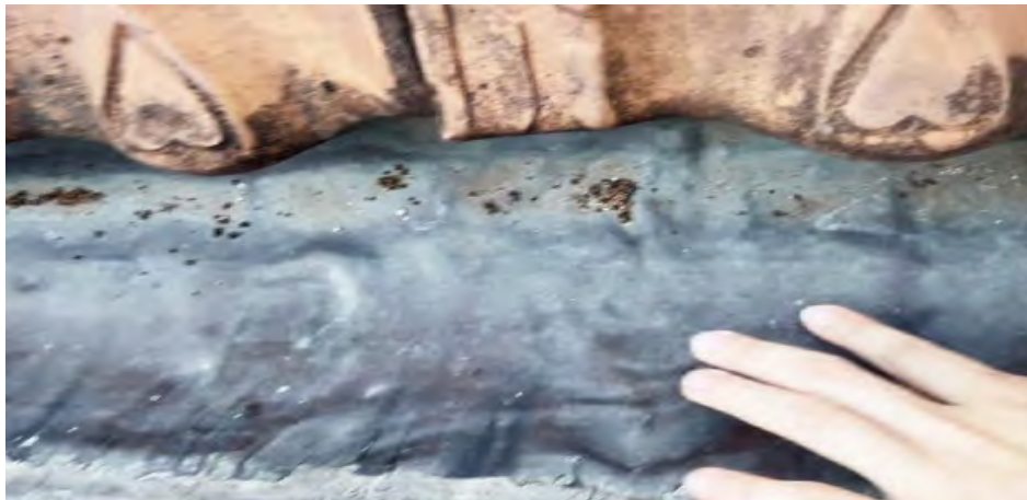
Foto 116: Dilatação (enrugamento) da calha de cobre. Essas rugas são causadas pela exposição as intempéries e podem favorecer o surgimento de trincas e fissuras na calha que podem causar infiltrações no interior da Cavalaria, além do acúmulo de detritos.
