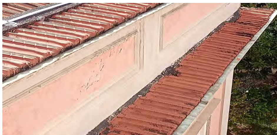
Foto 32: Fiada de telhas abaixo da platibanda com telhas danificadas. Foram feitas intervenções temporárias com argamassa de preenchimento onde houve quebra.
