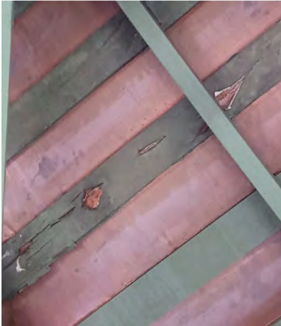
Foto 152: Madeiramento interno do quiosque apresenta pontos de desgaste. Isso provoca problemas com relação a fixação dos pregos que conectam as telhas de cobre a estrutura de madeira.
