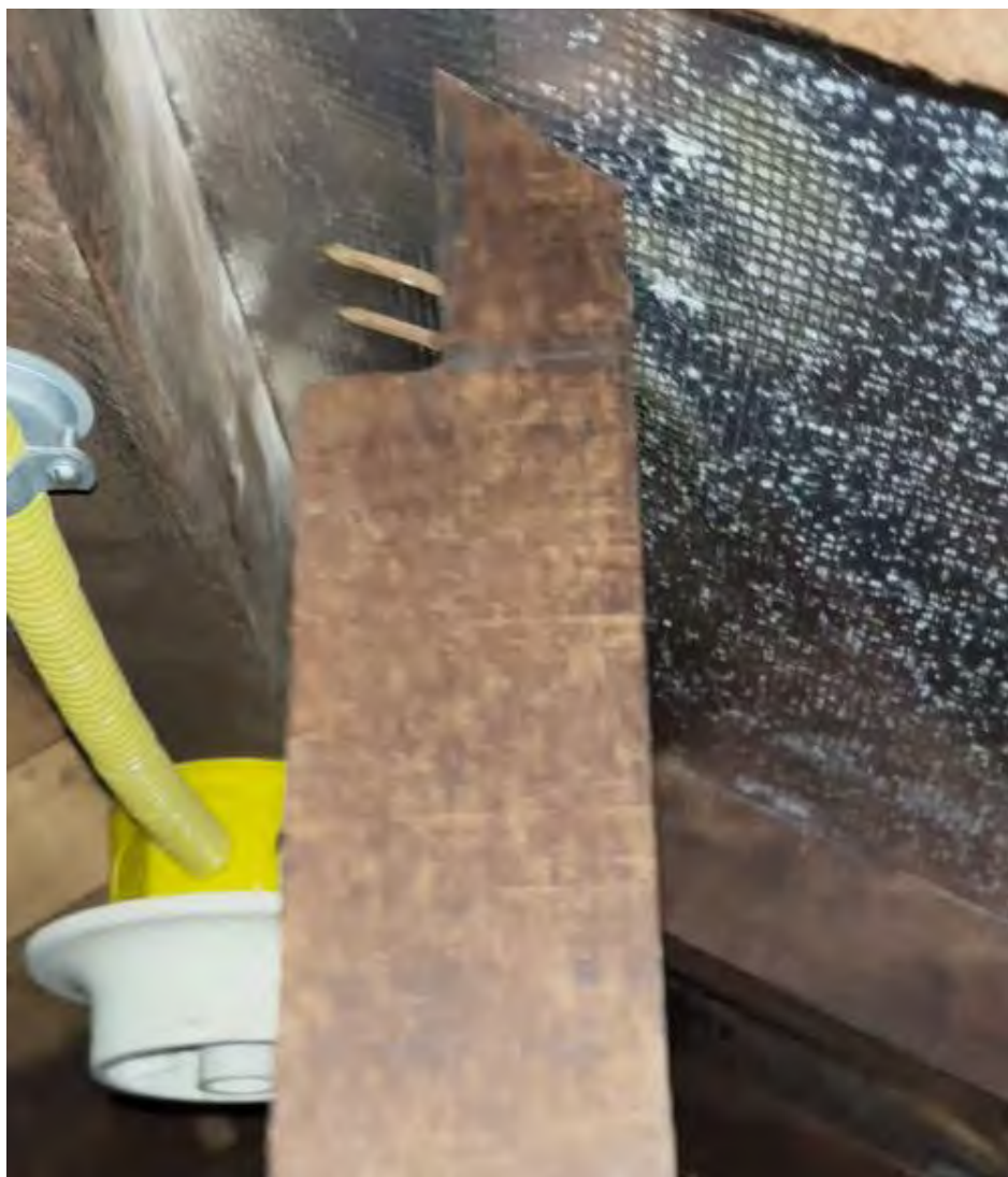
Foto 120: Madeiramento do interior do telhado solto.
