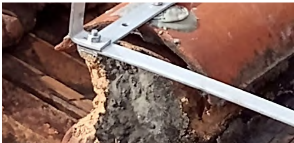
Foto 56: Má fixação da instalação de SPDA deixando um dos captores em balanço fora das telhas. Falta acabamento na lateral para cobrir a argamassa e evitar infiltrações.
