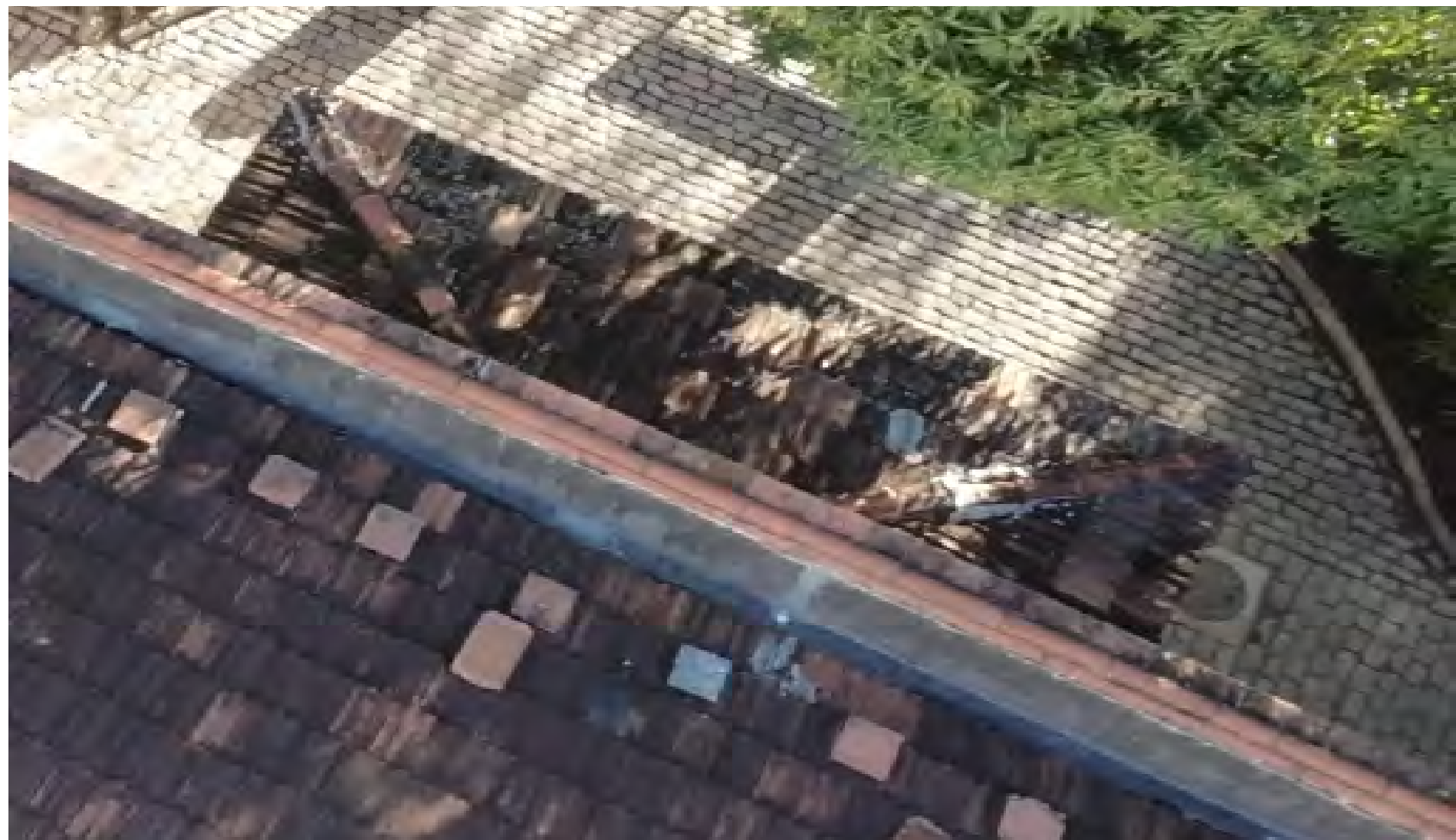
Foto 121: Ausência de algumas telhas no TE10. Algumas outras estão fragilizadas nas bordas devido a queda de frutos das árvores. Espaço sem telhas preenchido com argamassa e com mancha negra. No TE09, passadiços soltos e/ou sem acabamento em cerâmica.
