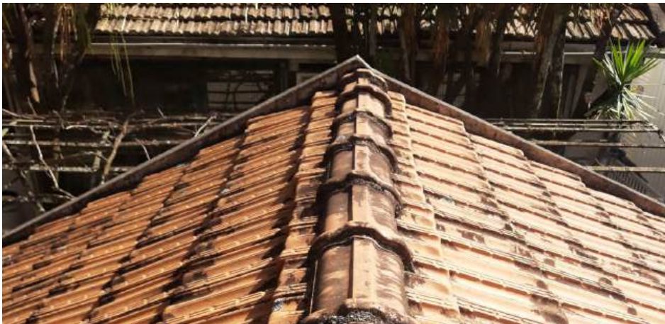
Foto 132: Cumeeira direcionada para o TE13, com excesso de argamassa para fixação com ressecamento.
