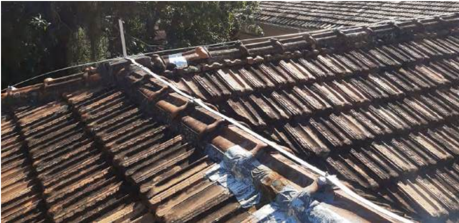
Foto 64: Aplicação de manta aluminizada em cumeeira. Telhas com desgaste em geral.
