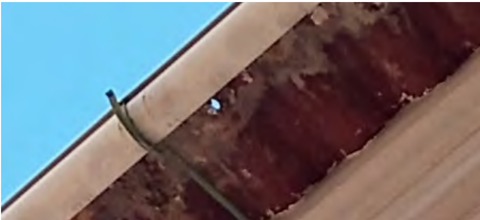
Foto 82 Furo em telha do beiral.
