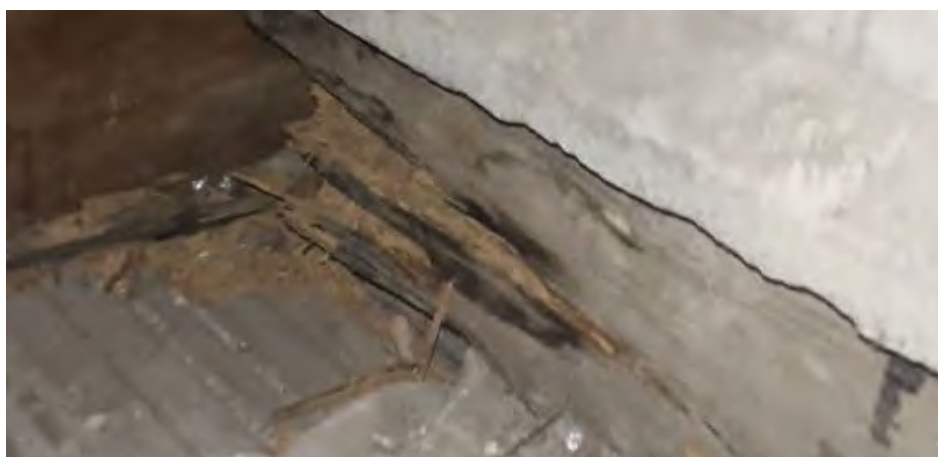
Foto 122: Barrote de madeira que sustenta a caixa d'água desativada no interior do telhado da cavalaria está apodrecido.
