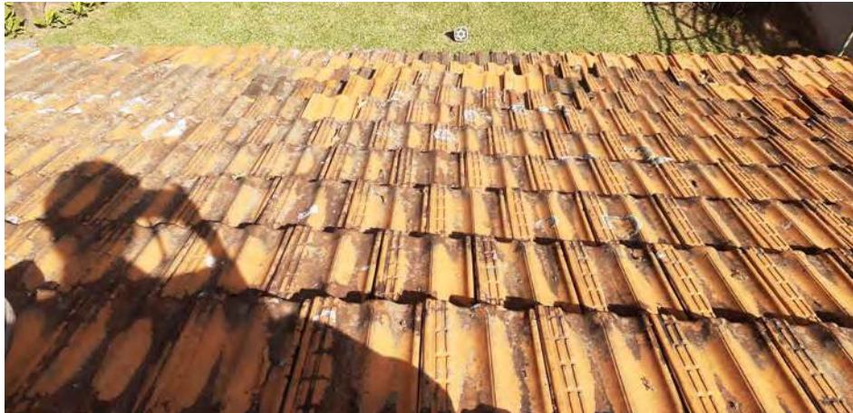
Foto 130: Trecho central da cobertura, continuidade da foto anterior, apresentando os mesmos danos apontados acerca das telhas francesas.
