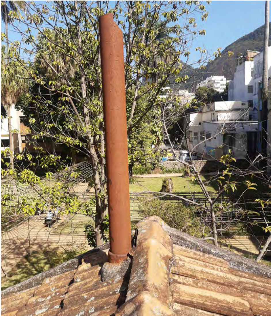
Foto 140: Aproximação da parte superior da chaminé, com corrosão avançada e trecho quebrado.
