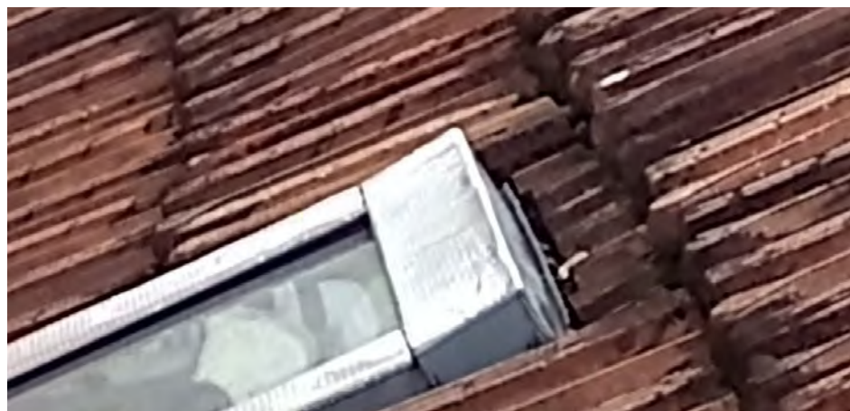
Foto 59: Fresta entre o alçapão do telhado e as telhas, gerando má vedação e infiltrações no interior do telhado.
