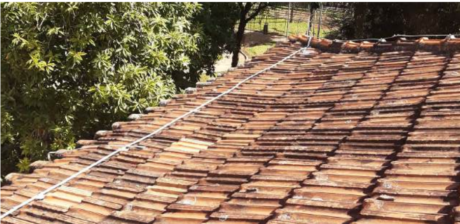
Foto 67: Beira de cobertura com telhas apresentando sujidades, pátina orgânica e deterioração do material.
