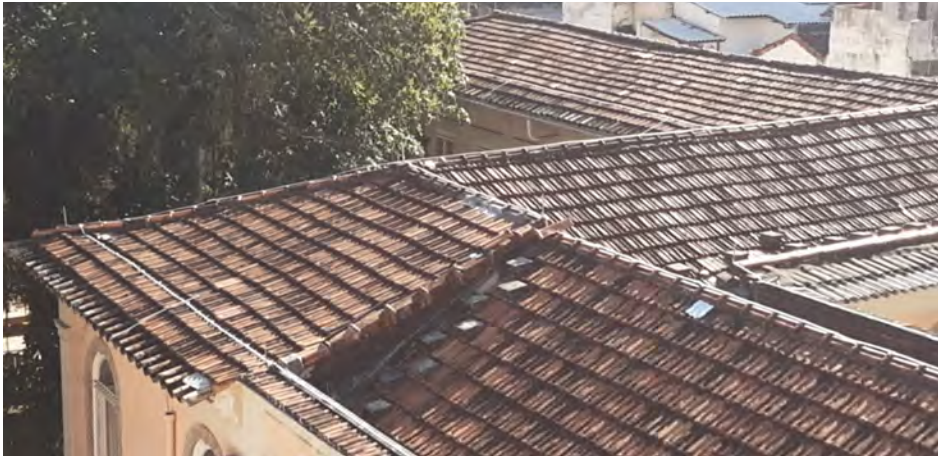
Foto 63: Vista geral da transição do TE 04 para 05, onde há ponto crítico de infiltrações na platibanda.
