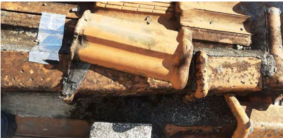
Foto 70: Continuidade da cumeeira em direção a cumeeira de topo desta cobertura, com manta aluminizada, argamassa nos encontros das telhas para evitar infiltração e telhahs desgastadas.
