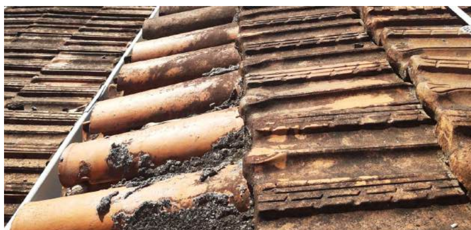
Foto 78: Telhas entre a cobertura TE05 e TE07, referentes a varanda da sala Bahia, que apresentam desgastes, desencaixes e aplicação de argamassa para fixação e vedação de vãos, a fim de evitar infiltração.
