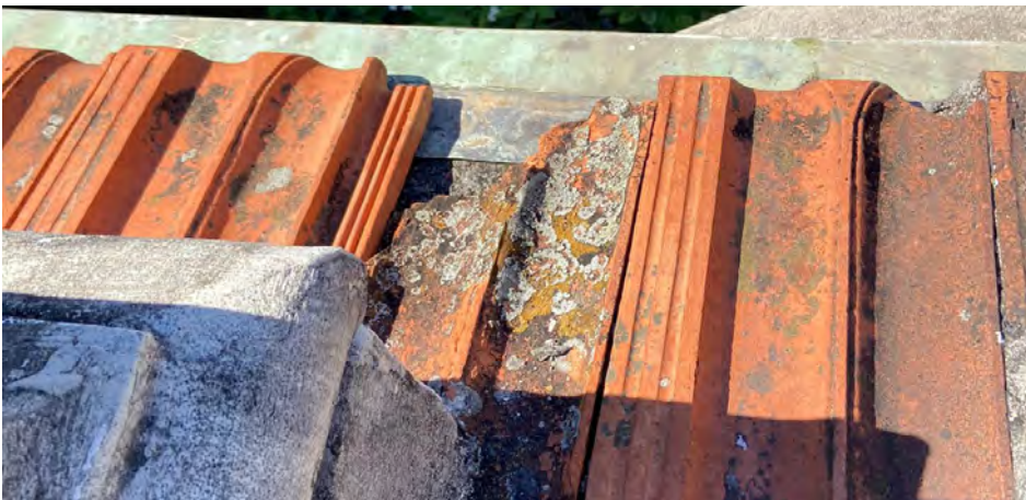
Foto 07: Telha francesa, próxima a estátua esquerda do frontão, quebrada e com presença avançada de pátina orgânica. Sua quebra deixa exposta a estrutura de sustentação e impermeabilização.
