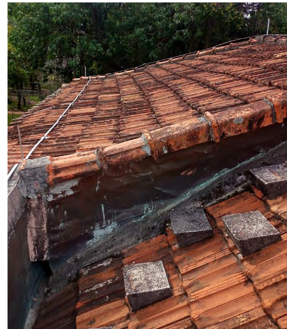
Foto 55: Trecho da platibanda que divide o TE04 do TE05 com saia de cobre retorcida, com emendas e acabamento ruim no encontro do cobre com a argamassa de fixação, gerando pontos de infiltração na área do corredor social da Casa.
