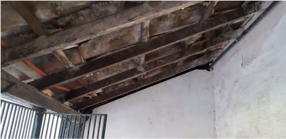
Foto 128: Estrutura abaixo do trecho da foto anterior está deteriorada por umidade, com presença de pontos de mofo branco, como os apresentados na foto 126, e as paredes também são afetadas pela por umidade.
