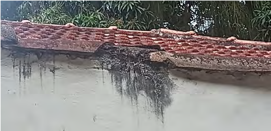
Foto 101: Telas quebradas e/ou faltantes no muro do estacionamento.
