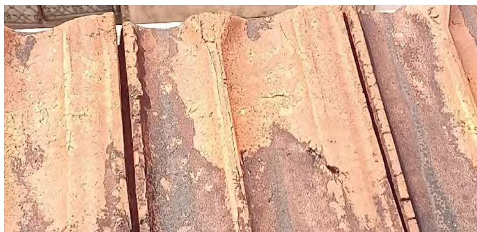
Foto 29: Frestas no encontro das telhas causando danos na pingadeira em chapa metálica abaixo.
