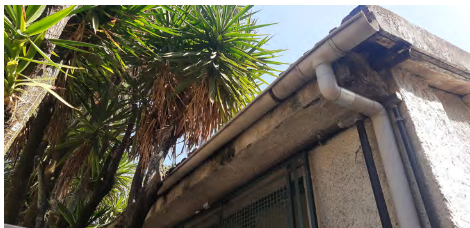
Foto 150: Calha em pvc apresentando desgastes e estrutura em concreto logo abaixo com manchas negras, indício de vazamento de águas pluvias e dano por umidade.
