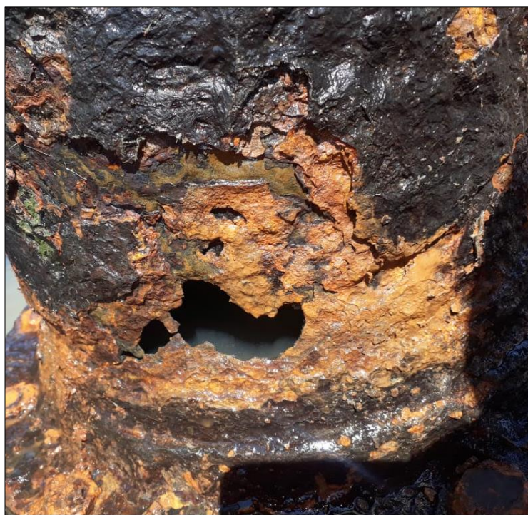
Figura 4 - Ponto de vazamento (Fonte: autor)
