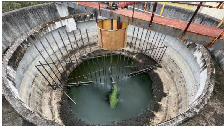
Figura 8 - Adensador de lodo
