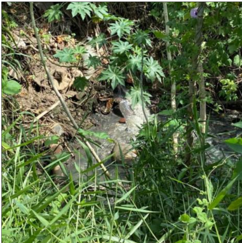
Figura 14 - Despejo irregular devido a extravaso do poço por inoperância do bombeamento
