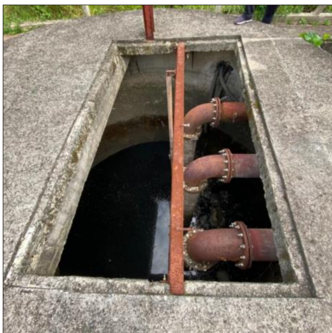
Figura 11 - Poço de sucção sem tubos guias e bombeamento inoperante
