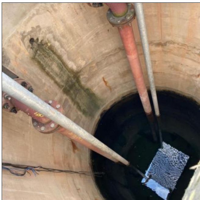
Figura 10 - Poço de sucção e tubos guias
