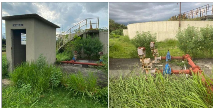
Figura 7 - Estação de recalque de lodo
