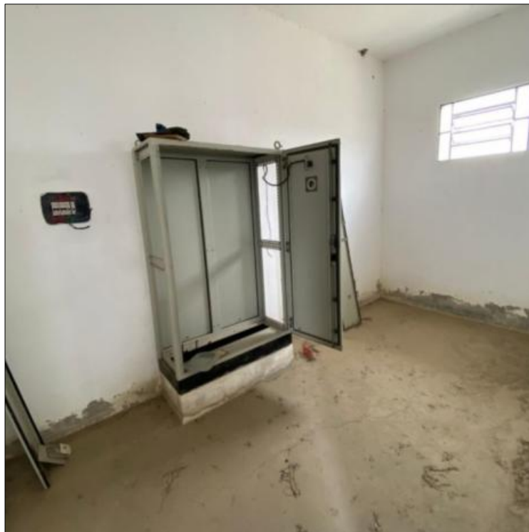
Figura 12 - Ausência de sistema elétrico
