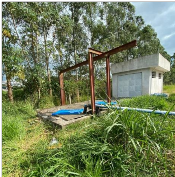
Figura 2 - Elevatória de esgoto bruto dentro da ETE
