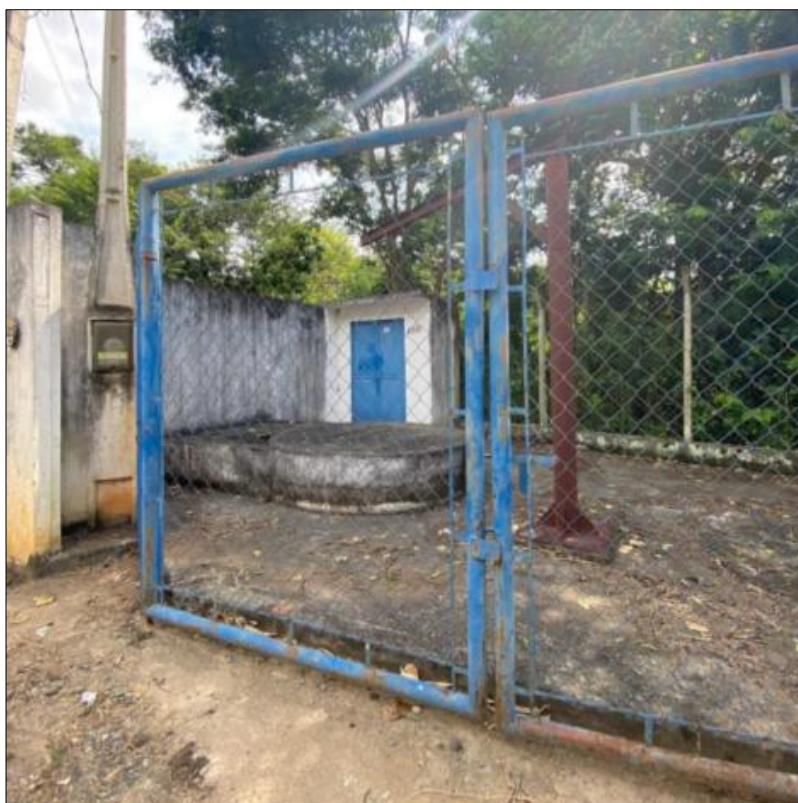
Figura 15 - EEE São Francisco não recebe a totalidade da bacia de contribuição projetada
