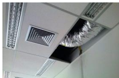
Difusor embutido no Forro
