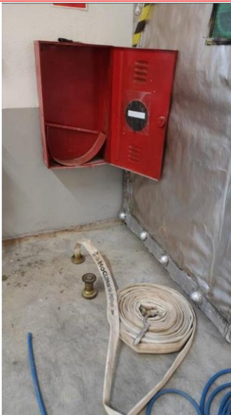
Figura 3 - Hidrante Salão (próximo a porta de entrada):
