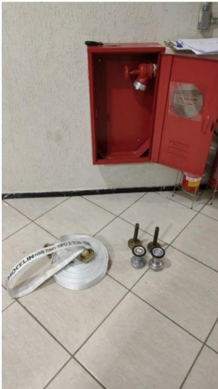
Figura 2 - Hidrante do Piso Térreo (Recepção)
