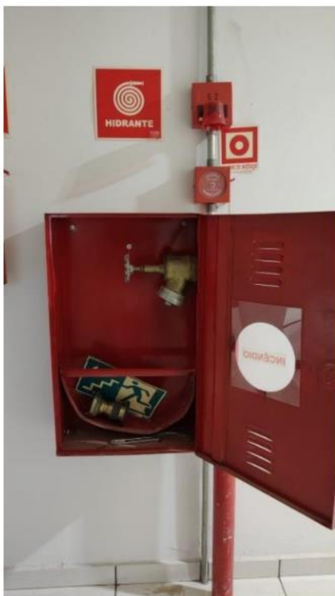
Figura 1 - Hidrante do Piso Superior
