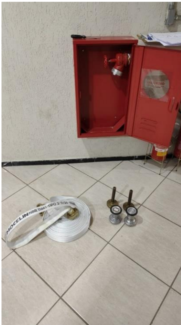
Figura 2 - Hidrante do Piso Térreo (Recepção)
