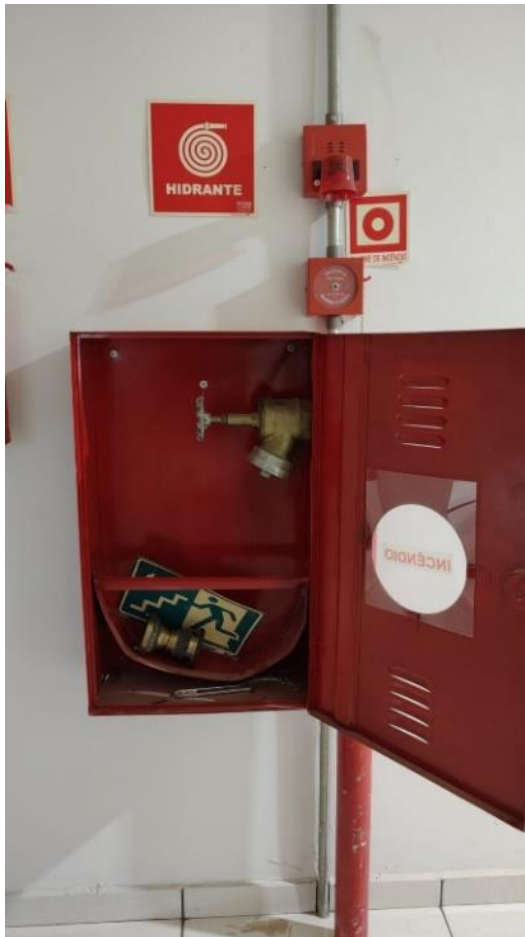
Figura 1 - Hidrante do Piso Superior
