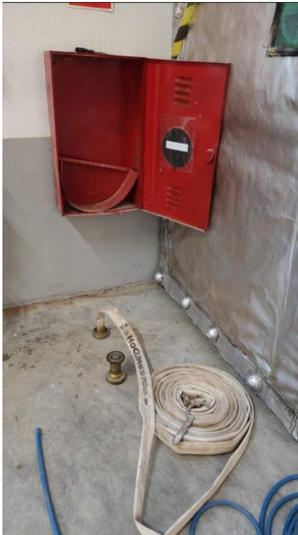
Figura 3 - Hidrante Salão (próximo a porta de entrada):
