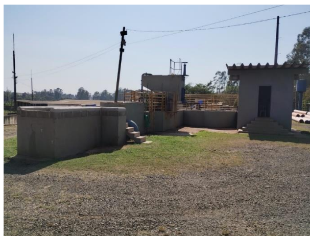
Figura 12 – Pré-tratamento – vista de montante a jusante
