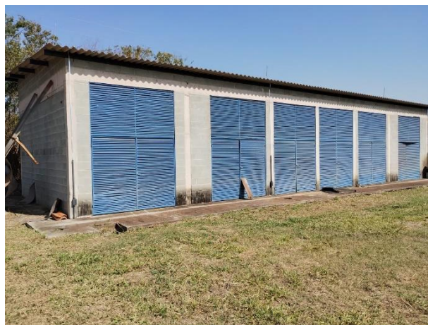
Figura 20 – Casa dos geradores
