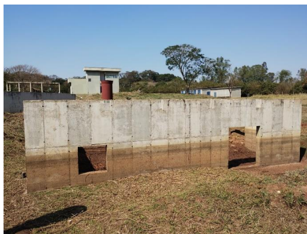
Figura 23 – Caixa de Registros
