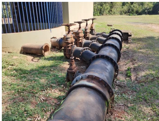
Figura 41 – Linha de Recalque na saída da EEE
