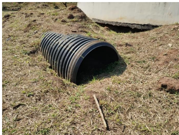
Figura 24 – Tubulação do Tanque de Aeração – Caixa de Registros
