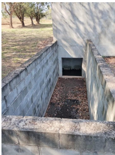
Figura 37 – Tanque de Desinfecção
