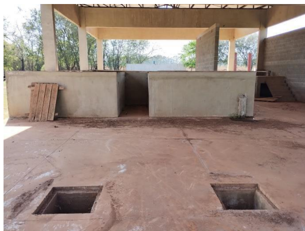
Figura 31 – Casa de desidratção do lodo - Vista interna.
