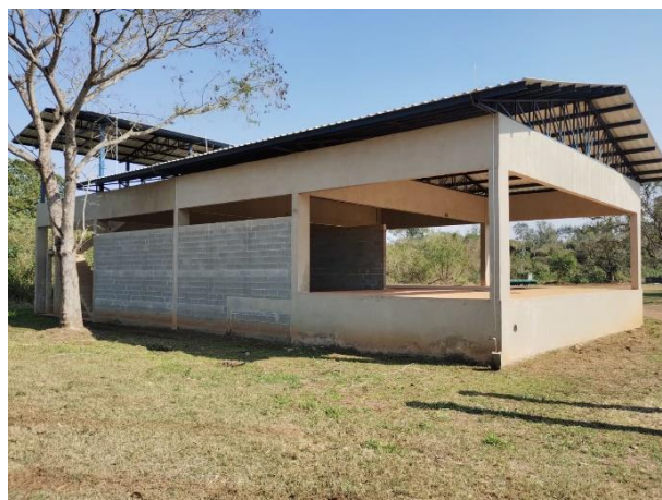
Figura 27 – Casa de desidratação do lodo
