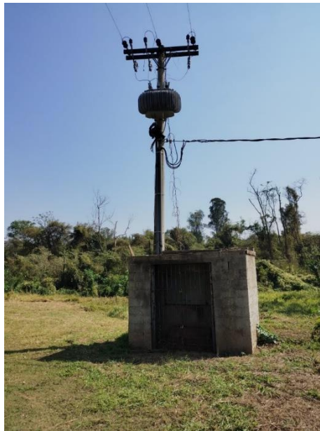
Figura 43 – Entrada de energia elétrica 02
