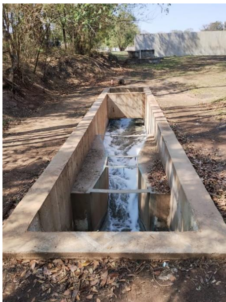
Figura 48 – Medidor de vazão (calha Parshall)
