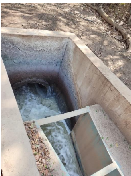
Figura 47 – Medidor de vazão (calha Parshall)
