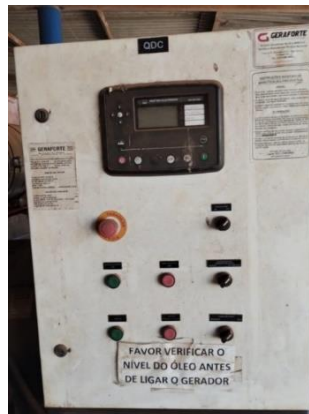
Figura 53 – Grupo gerador - Painel de comando.
