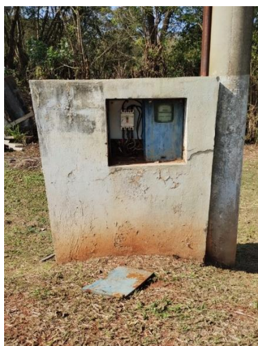
Figura 8 – Quadro de medição da entrada de energia elétrica 01
