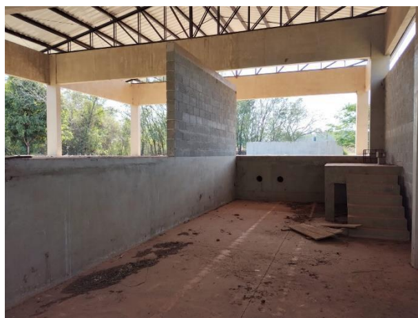
Figura 33 – Casa de desidratção do lodo - Vista interna da área central para a frente.
