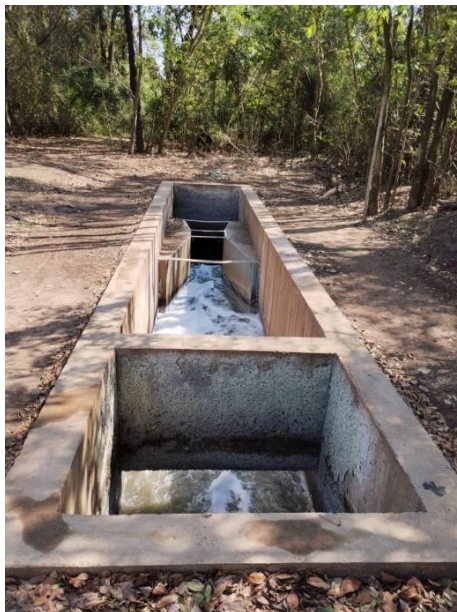
Figura 45 – Medidor de vazão (calha Parshall)
