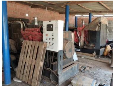
Figura 52 – Grupo gerador - Observa-se a existência de dois grupos geradores.
