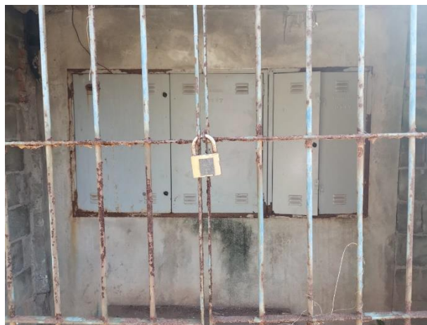
Figura 44 – Quadro de medição da entrada de energia elétrica 02
