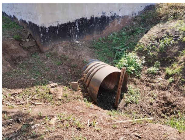
Figura 36 – Tanque de Desinfecção - Tubulação de entrada do tanque.
