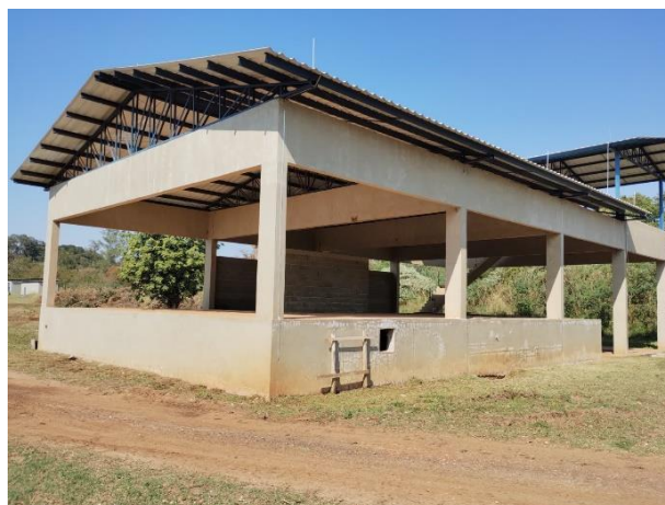
Figura 28 – Casa de desidratação do lodo
