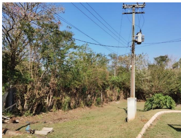
Figura 7 – Entrada de energia elétrica 01 e emissário região leste (chegada)
