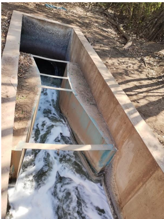
Figura 46 – Medidor de vazão (calha Parshall)
