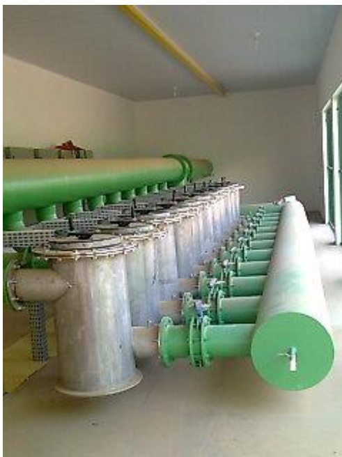
Figura 13. Reator ultravioleta da estação.
