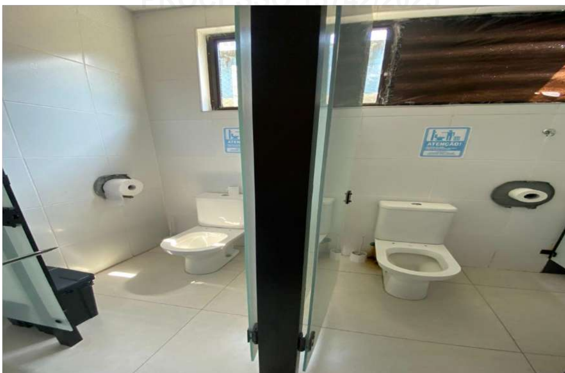
Fig. 12 – Banheiro feminino (galeria), vasos sanitários não possuem assentos.
