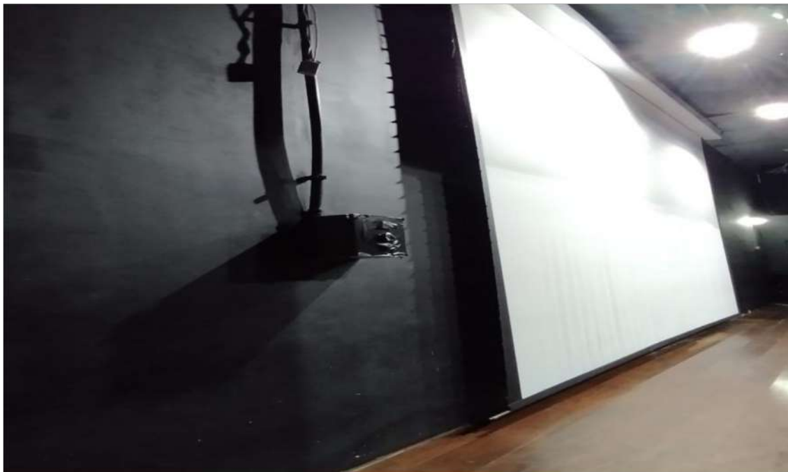
Fig.21 – Mecanismo de abertura da cortina principal, encontra-se sem funcionamento. Necessitando reparo.
