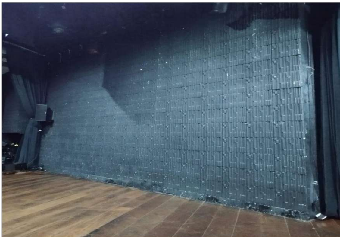
Fig. 20 – Necessário mecanismo de “cortina retrátil”, nas laterais do palco. Reparo telhado/infiltração.
