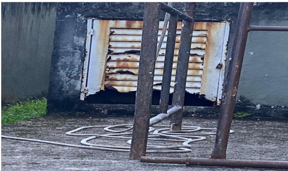
Fig.6 - Porta de acesso ao barrilete encontra-se deteriorada devido ao ferrugem.
