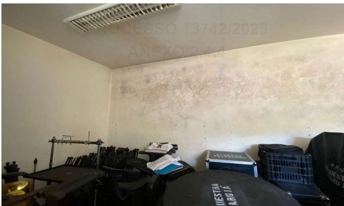
Fig. 8 – Sala de Orquestra, possui infiltrações.
