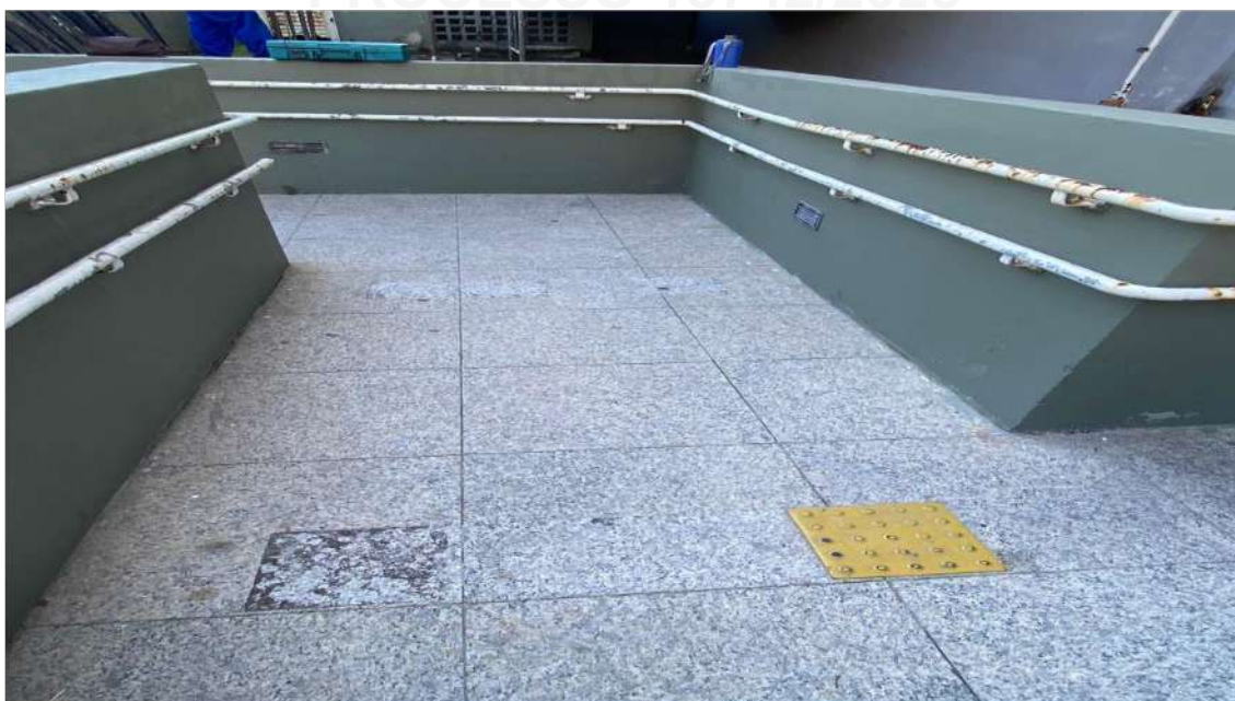
Fig.4 - Ausência de piso tátil na rampa de acesso
