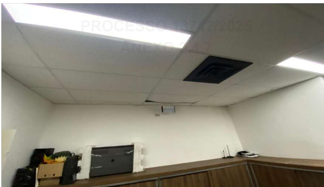
Fig. 14 – Cabine de som possui infiltrações
