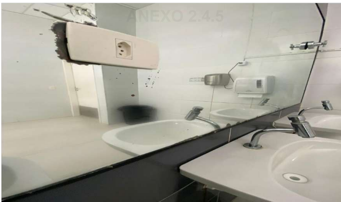
Fig. 10 – Espelho do banheiro masculino encontra-se manchado, devido a umidade.
