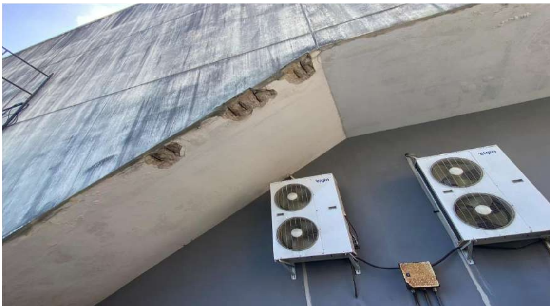
Fig. 7 – Armaduras corroídas, necessitando reparo.
