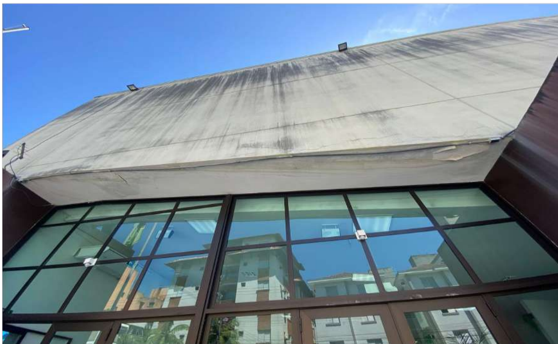
Fig. 3 – Fachada encontra-se com fissuras devido a fatores ambientais e necessita de reparo/pintura.
