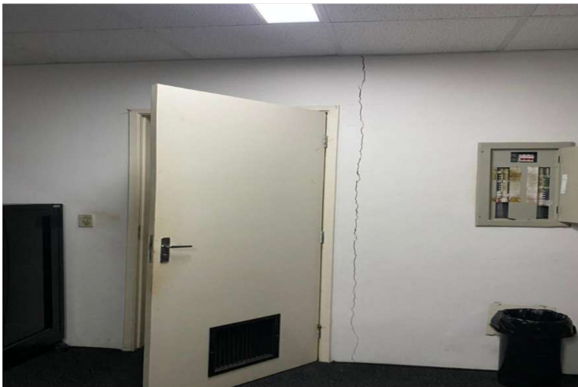
Fig. 15 – Trinca próxima ao vão de porta da cabine de som.
