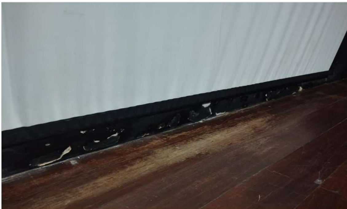
Fig. 19 – Rodapé lona de projeção, encontra-se com infiltrações.
