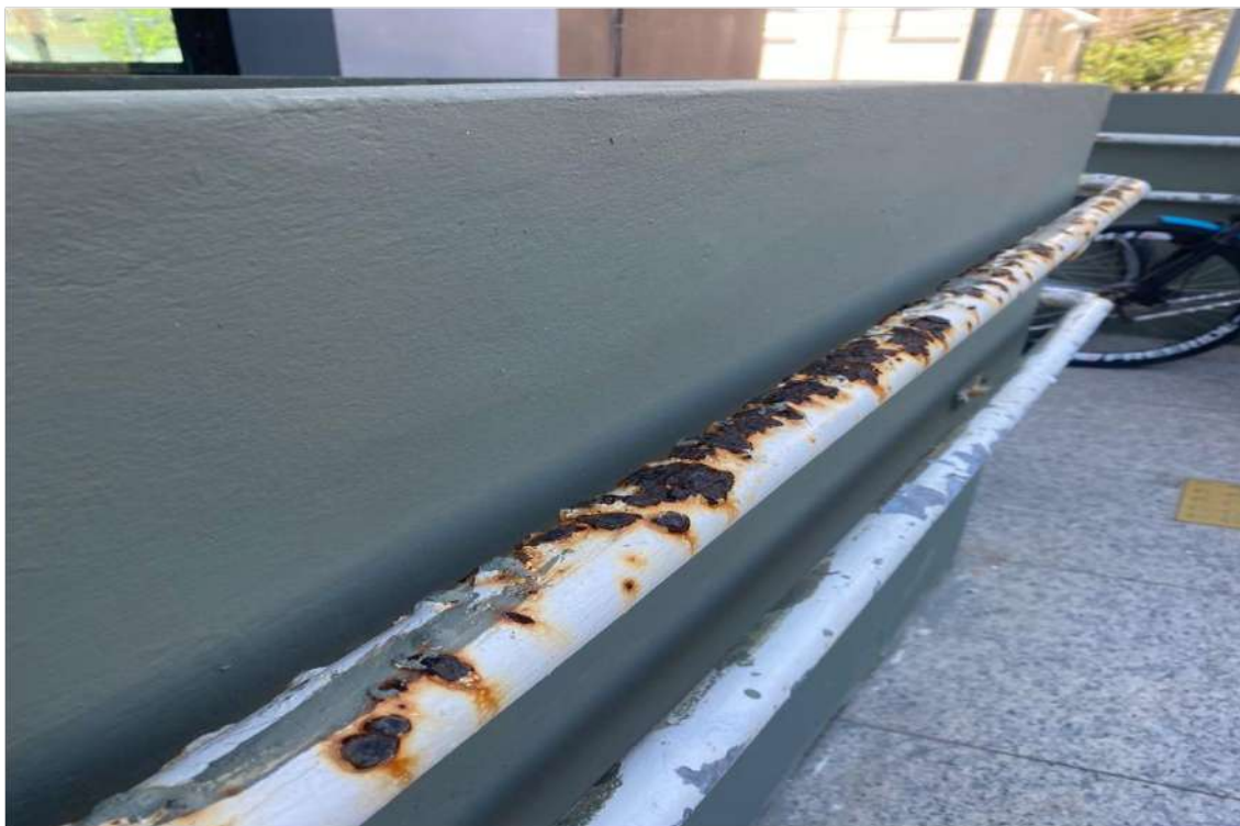
Fig.5 – Corrimão duplo de acessibilidade, encontra-se deteriorado devido ao ferrugem. Sendo necessária a troca do mesmo.
