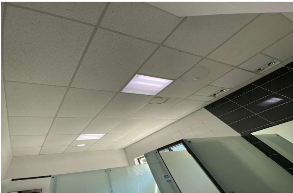
Fig. 9 – Infiltrações teto banheiro masculino (galeria)
