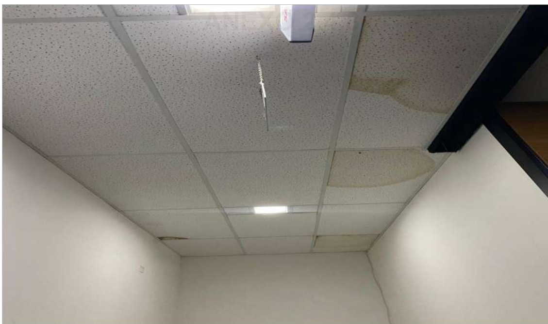
Fig. 16 – Infiltrações no teto escadaria (entrada platéia).
