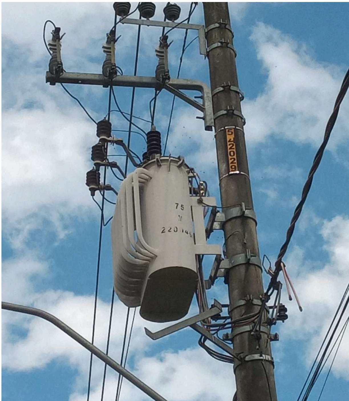
FIGURA 1 - ET 542029 transformador trifásico existente
