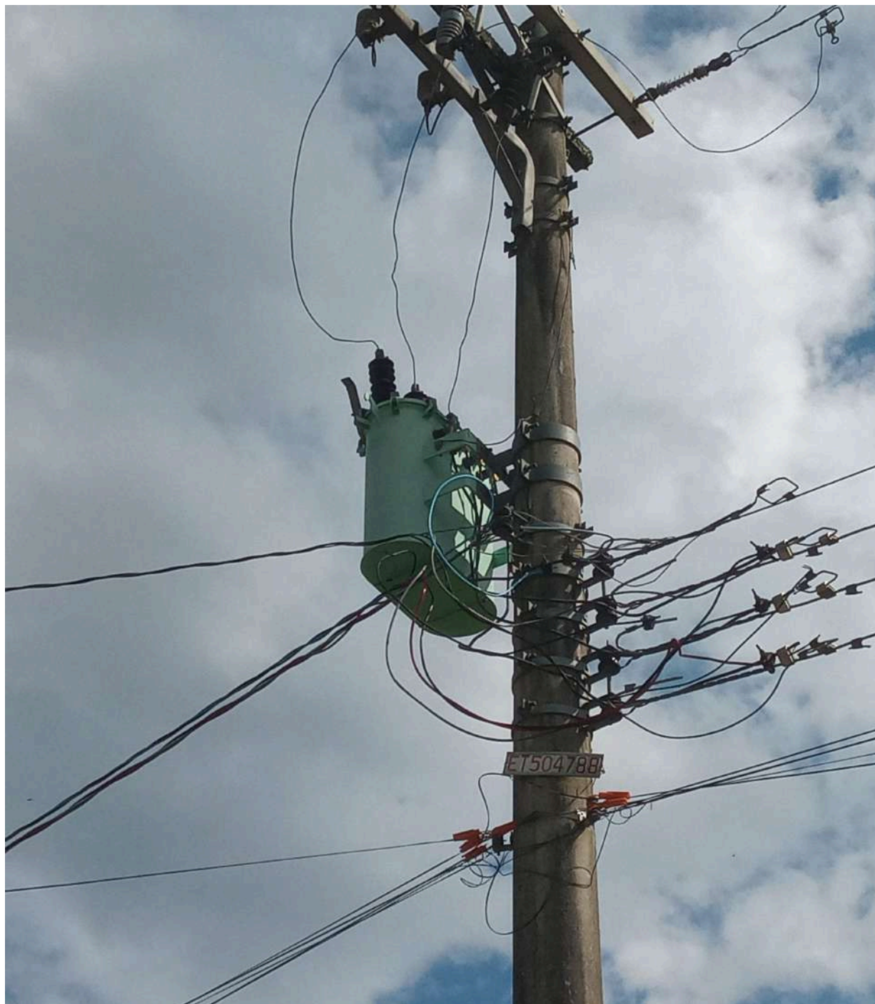
FIGURA 1 - ET 504788 transformador trifásico primário para secundário
