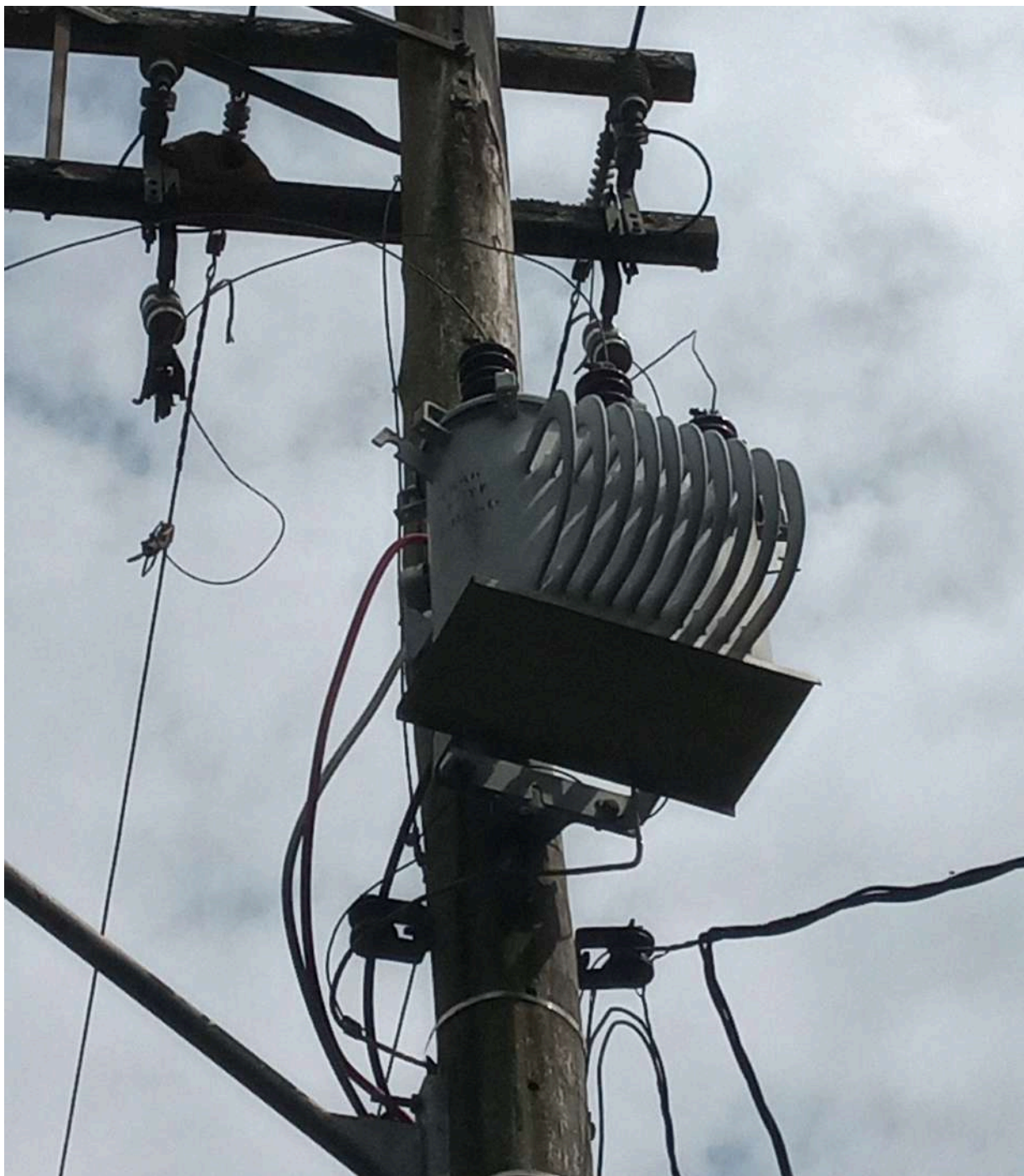
FIGURA 1 - ET 518319 transformador trifásico primário para secundário
