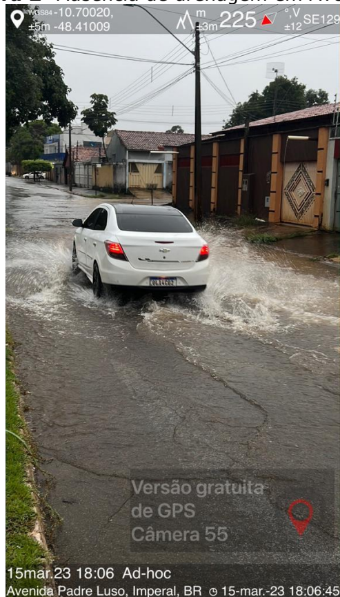
Figura 2- Ausência de drenagem em Avenida.
