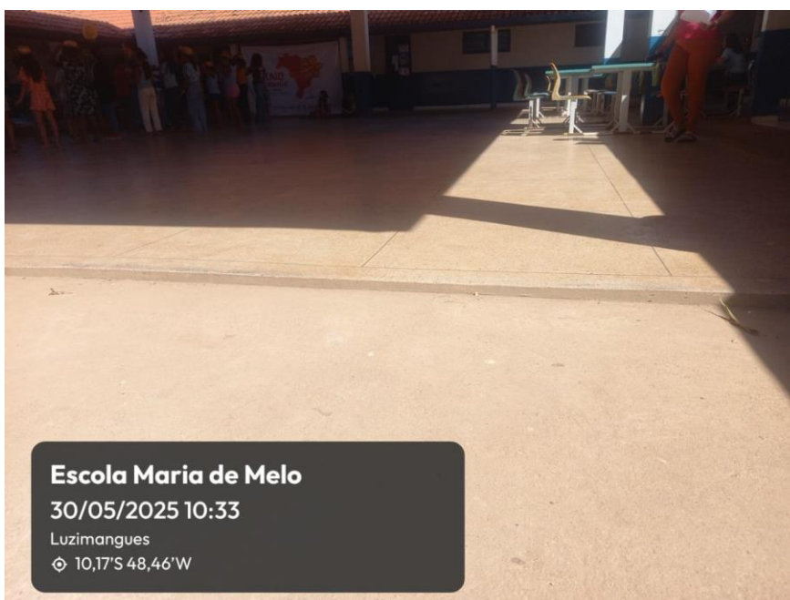
Figura 6 Desnível do Galpão e Calçada da Escola Maria de Melo
