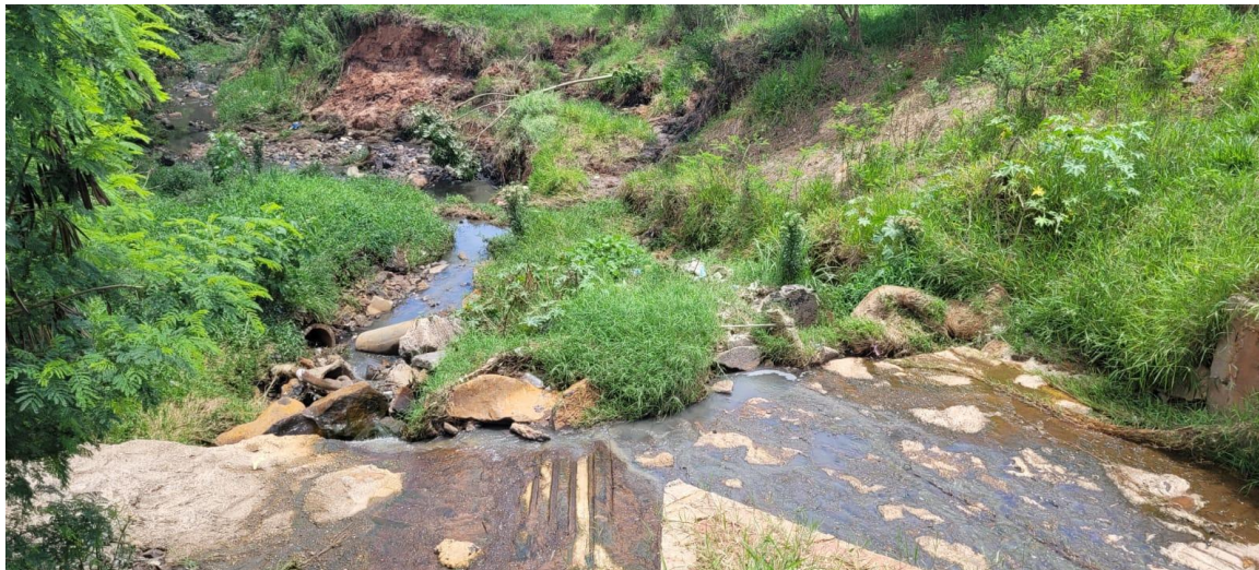
Figura 1 – Processos erosivos em trecho do Córrego Lajeado Fonte: Secretaria de Agricultura e Meio Ambiente (2023)
