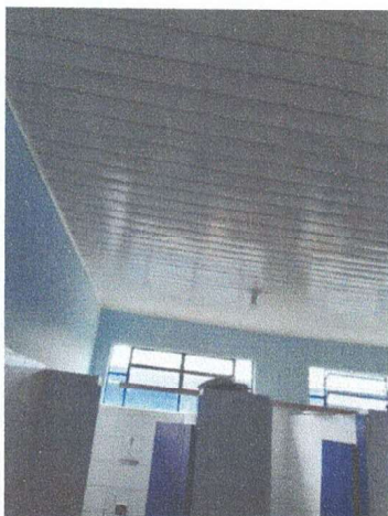
FOTO 13- FORRO PVC À SER SUPRIMIDO
