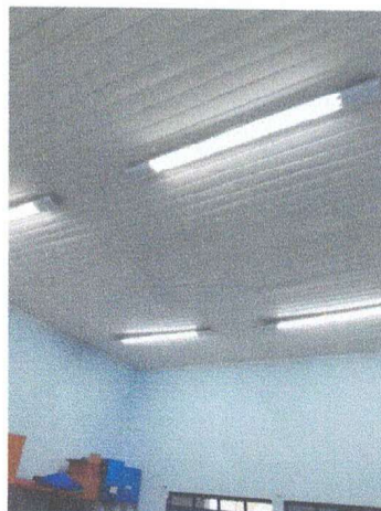
FOTO 10- FORRO PVC À SER SUPIMIDO
