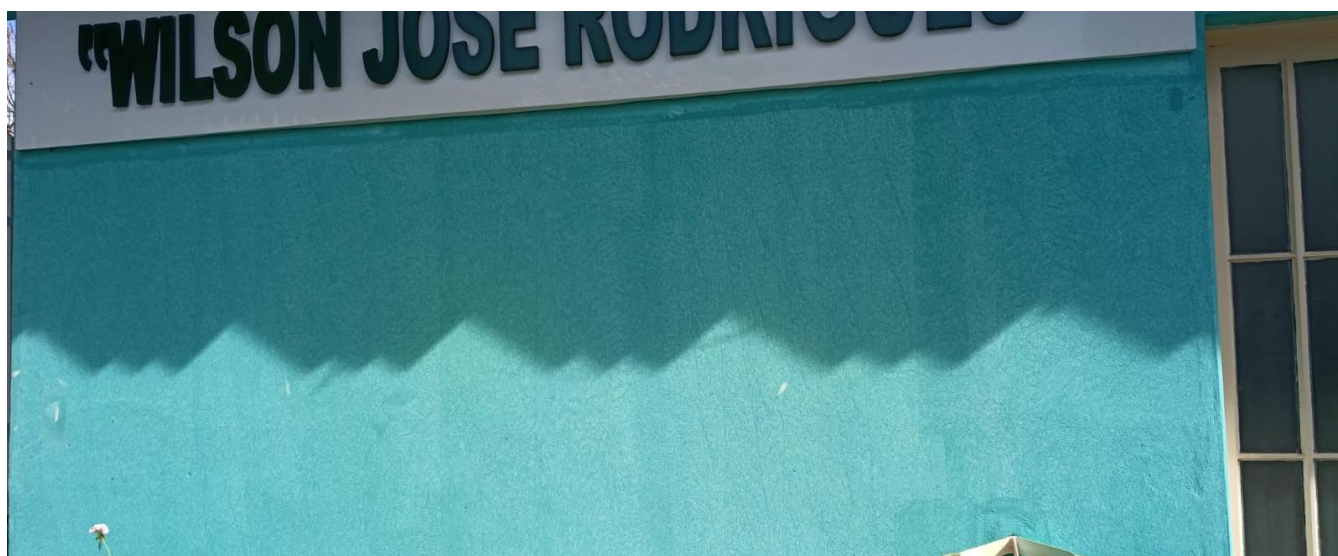
IMAGEM 02 - Escola Municipal Wilson José Rodrigues, baixa cobertura da tinta, com necessidade de maior número de demãos e tonalidade divergente da cor especificada. FONTE: Acervo pessoal do autor
