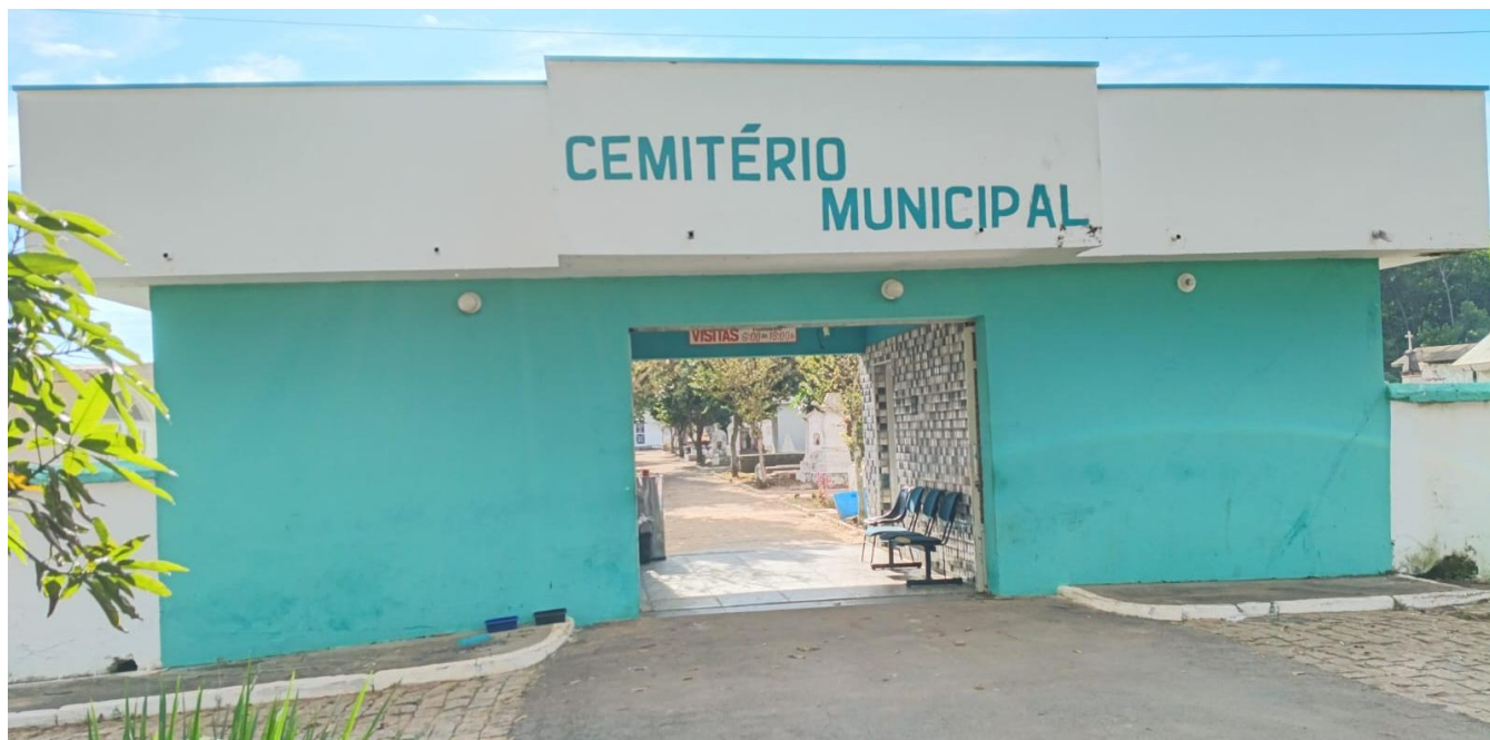
IMAGEM 03 – Entrada Cemitério Municipal, com tonalidade divergente da cor especificada. FONTE: Acervo pessoal do autor
