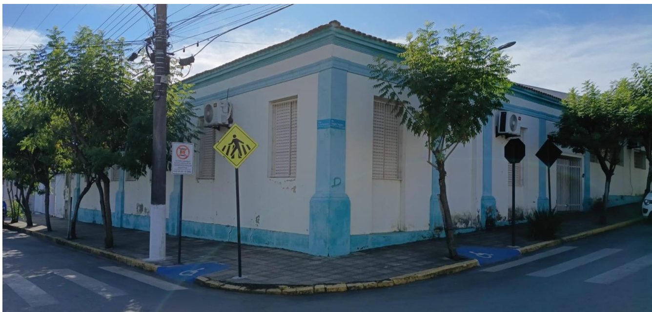
IMAGEM 01 - EMEB Prof. Wilson José Rodrigues (Extensão), desbotamento precoce da pintura, com perda significativa da coloração original em curto período de tempo; FONTE: Acervo pessoal do autor
