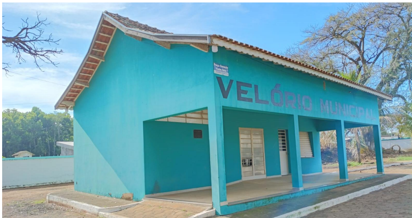
IMAGEM 04 – Velório Municipal, com desbotamento precoce da pintura, com perda significativa da coloração original em curto período de tempo; FONTE: Acervo pessoal do autor
