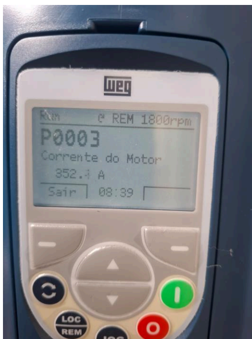
Figura 1: Leitura de corrente elétrica no motor de B1, 23/01/2026
