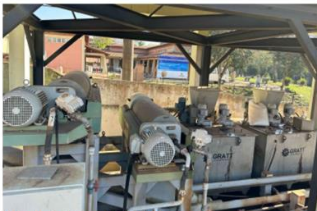
Instalação Geral do SKID.
