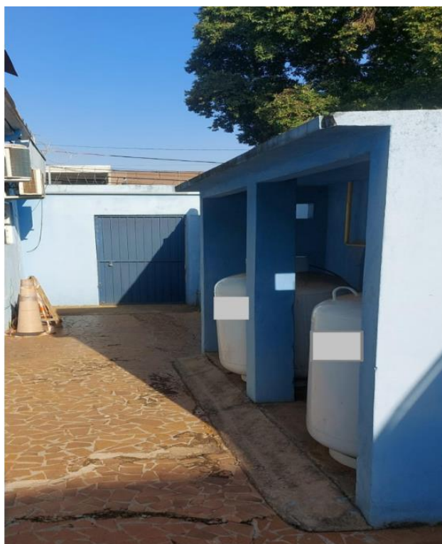
Figura 03 – Vista da central de GLP
