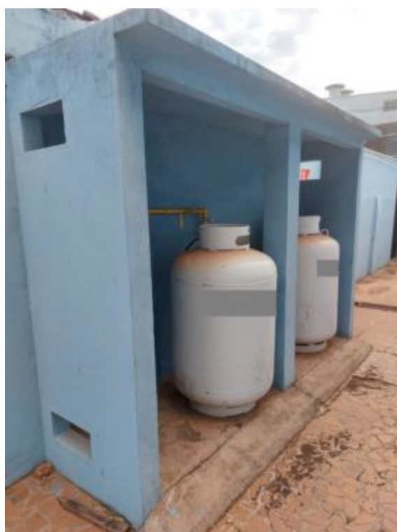
Figura 04 – Detalhe da central de GLP
