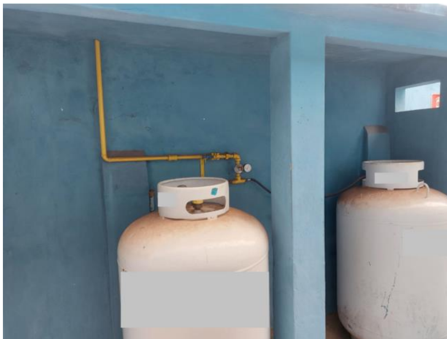
Figura 05 – Detalhe da instalação atual da central de GLP
