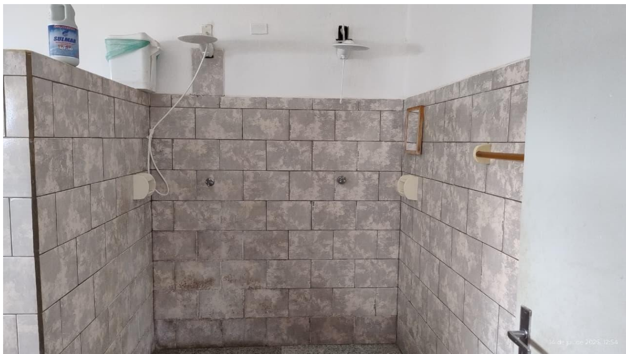
FOTO 8: SANITÁRIOS DOS ALOJAMENTOS SARGENTOS E TENENTES
