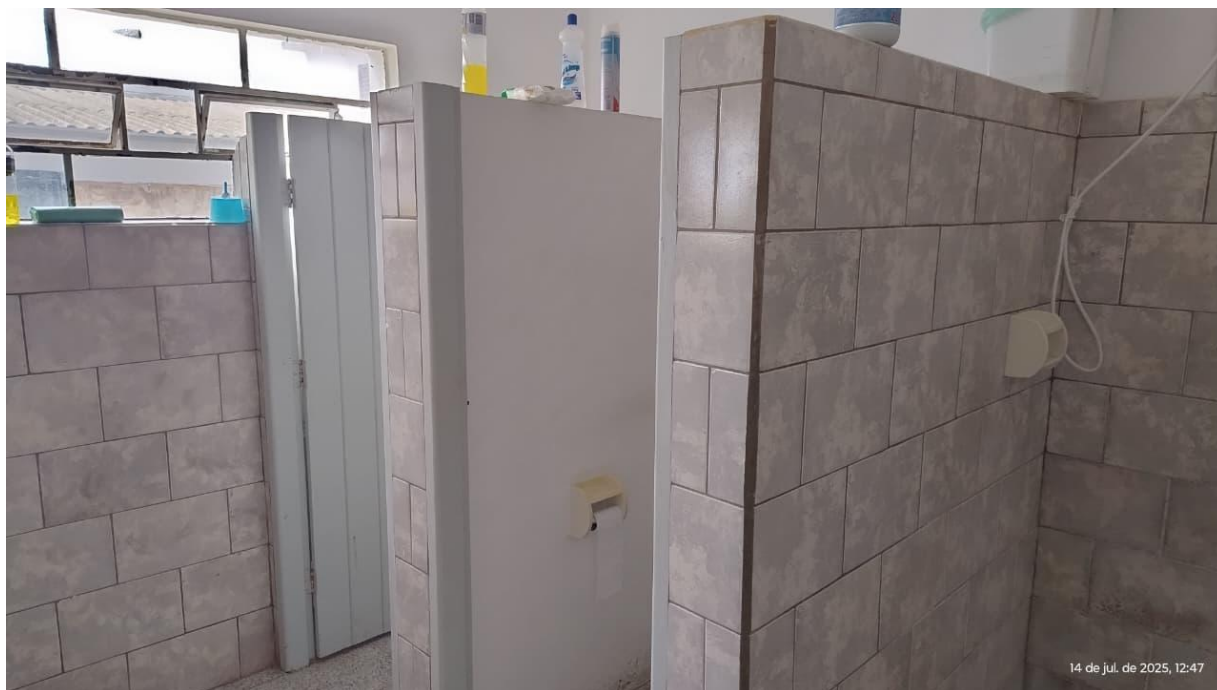
FOTO 6: SANITÁRIOS DOS ALOJAMENTOS SARGENTOS E TENENTES
