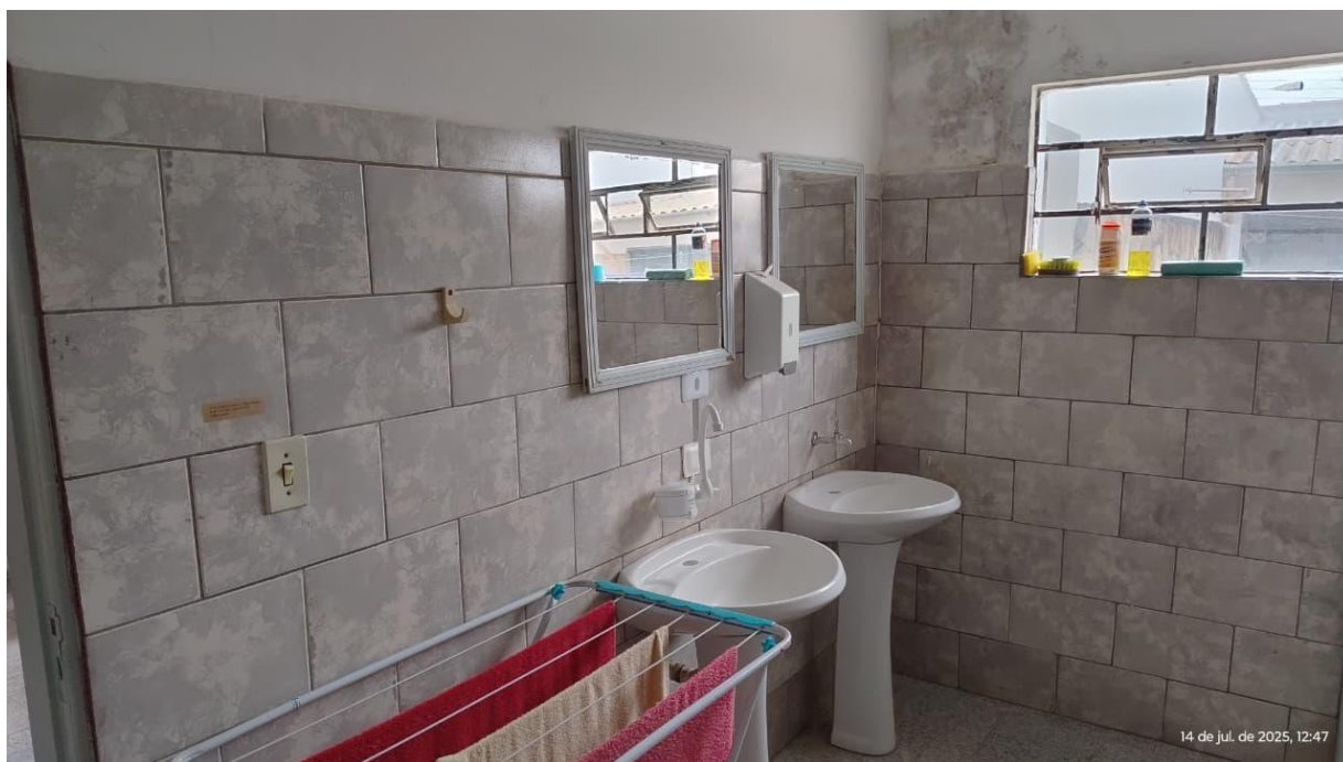
FOTO 5: SANITÁRIOS DOS ALOJAMENTOS SARGENTOS E TENENTES
