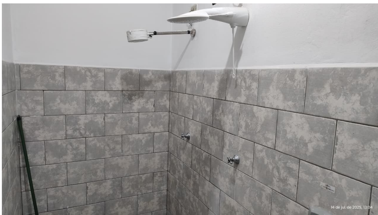
FOTO 10: SANITÁRIO DO ALOJAMENTO FEMININO
