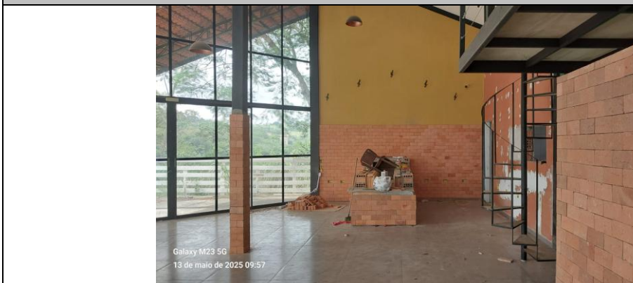
Salão e vista entrada cozinha. Obs: Paredes faltando pintura, fogão a lenha sem acabar (opcional a retirada/proposta anterior), arremates do passa prato, e, peça metálica de mezanino (opcional a retirada/proposta anterior).
