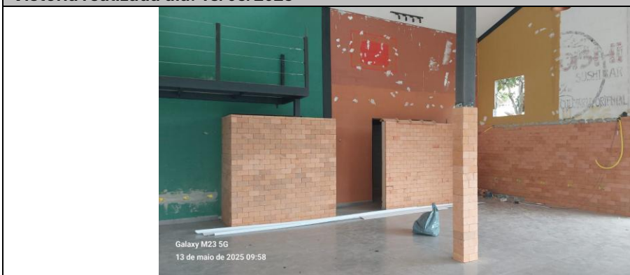
Salão e vista entrada dos sanitários, faltando pintura e fechamento de vão de parede.
