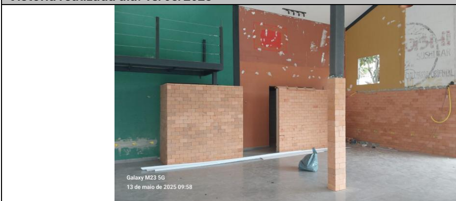
Salão e vista entrada dos sanitários, faltando pintura e fechamento de vão de parede.
